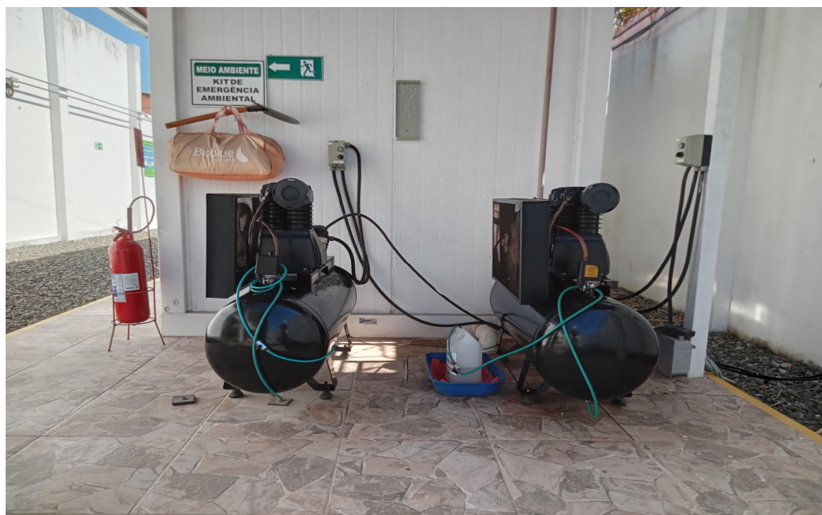
Foto 13: Sistema de ar comprimido (acionamento das válvulas da RCU)
