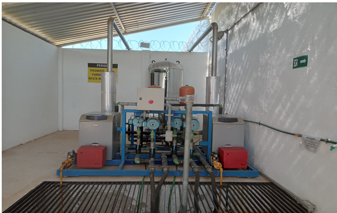
Foto 5: Sistema de aquecimento, armazenamento e recalque de água
