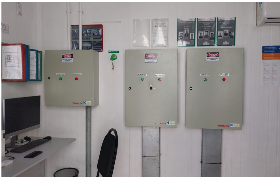
Foto 14: Painéis elétricos (Sala de Operação)
