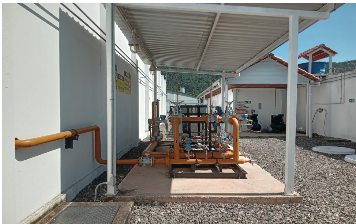
Foto 8: Tubulação de entrada da ERM (Pressão - 7,5 bar)
