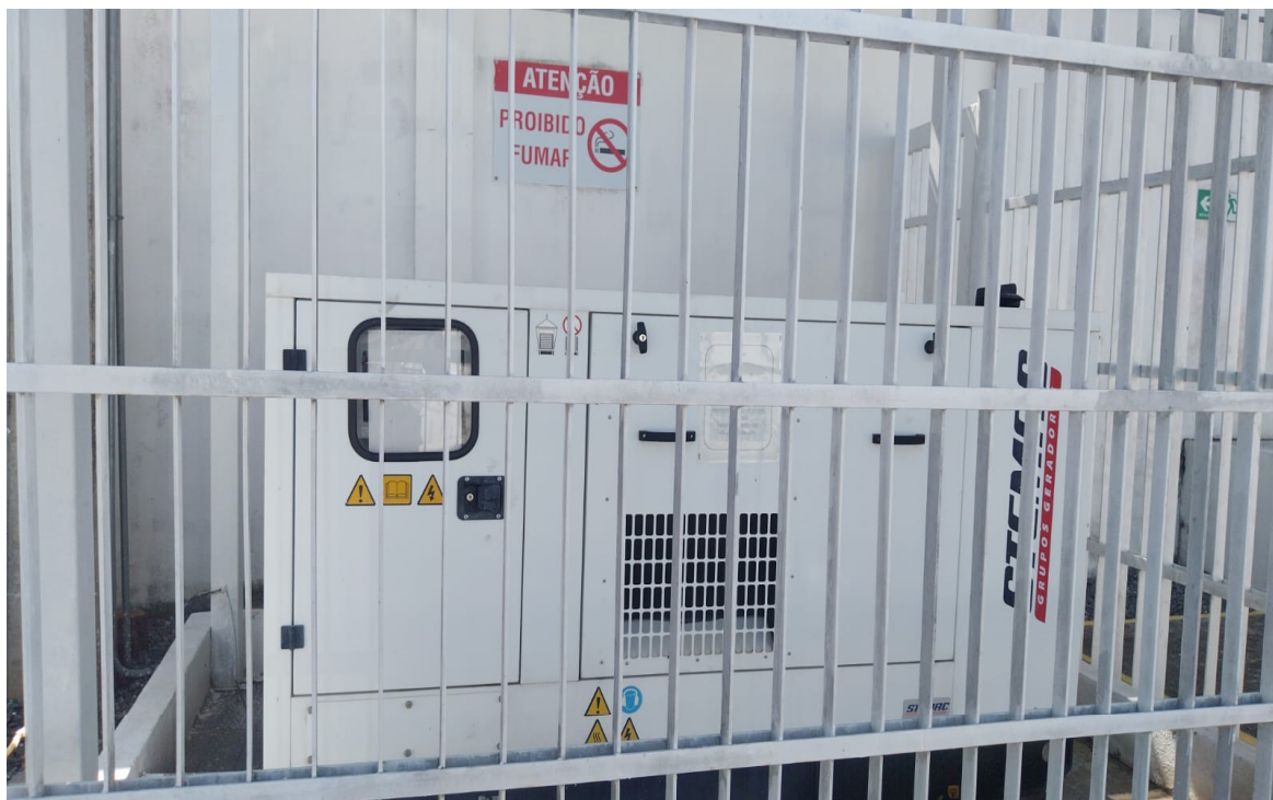
Foto 16: Gerador de emergência
