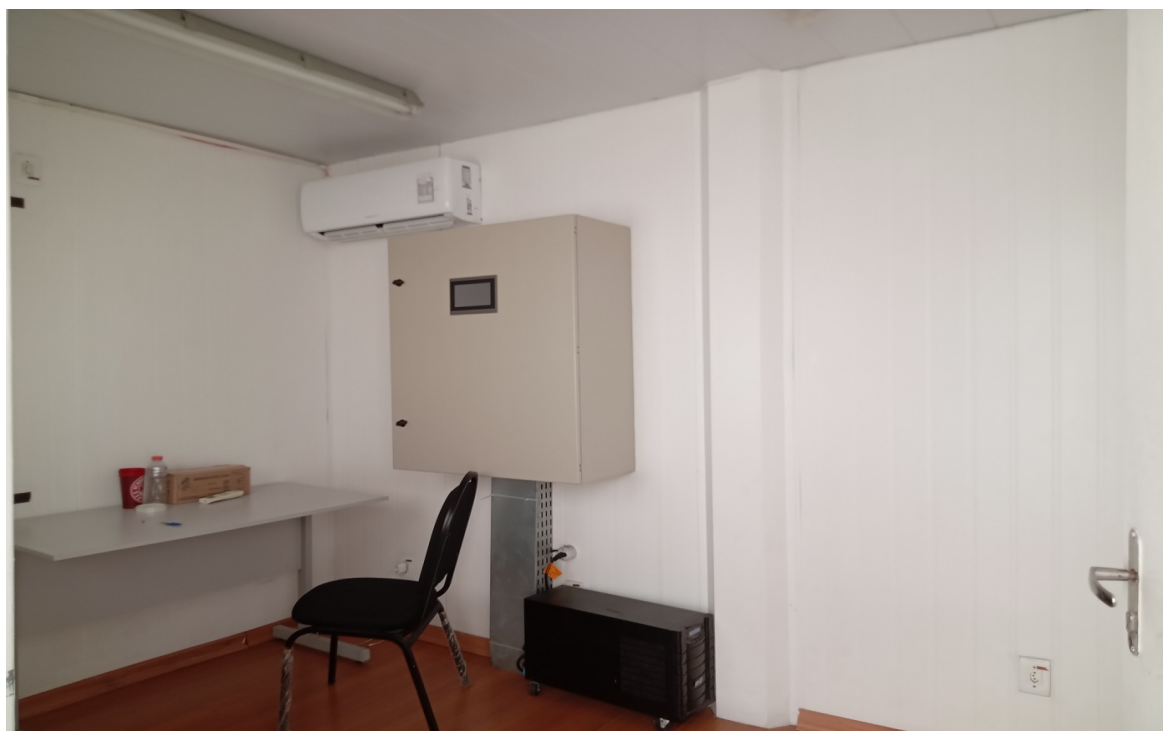
Foto 15: Painel do sistema de telemetria e nobreak (ERM)
