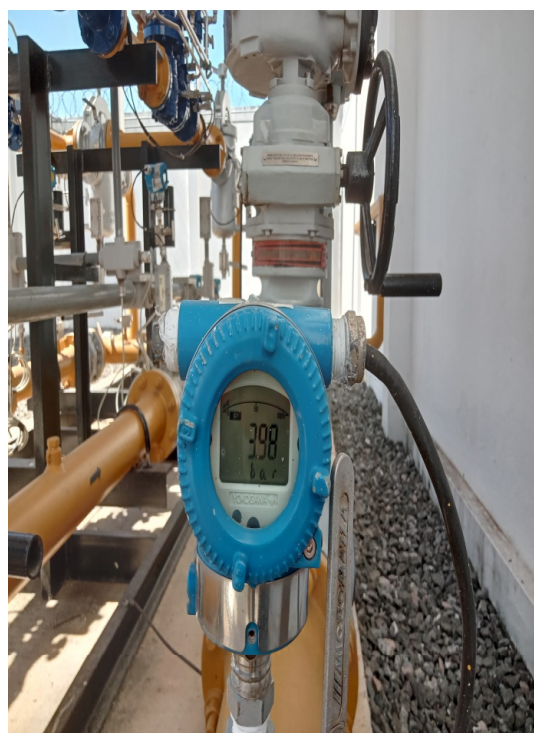
Foto 12: Medição da pressão de saída
