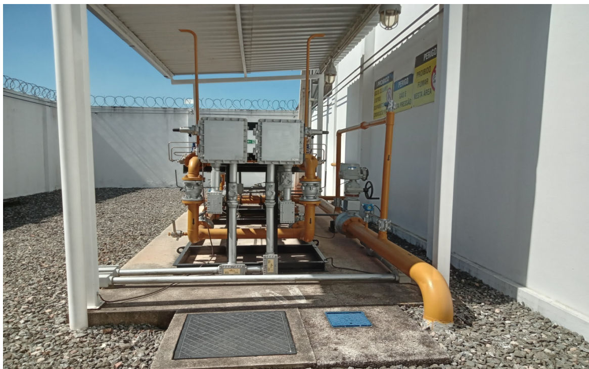
Foto 9: Tubulação de saída da ERM para distribuição (Pressão - 4 bar)
