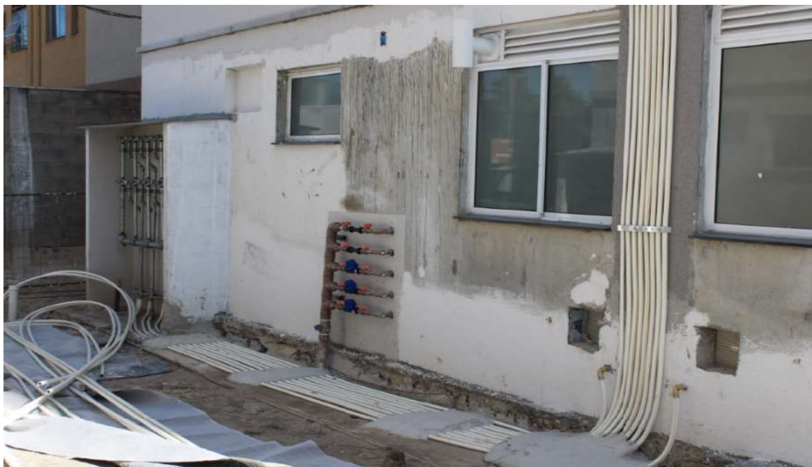
Foto 3 : instalação para regulador e medidores
