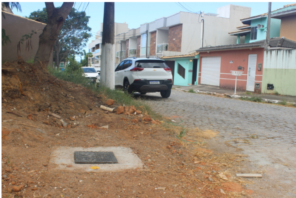
Foto 8: Caixa de interligação de rede
