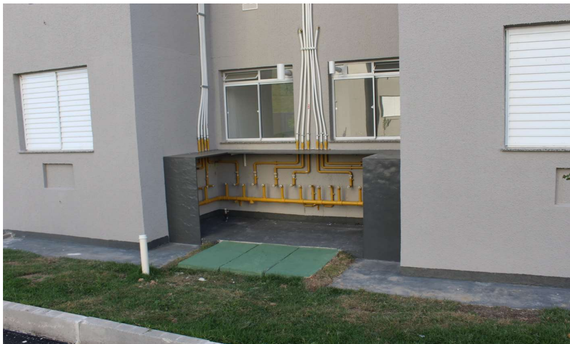
Foto 4 : Instalações internas preparadas para receber os reguladores e os medidores.
