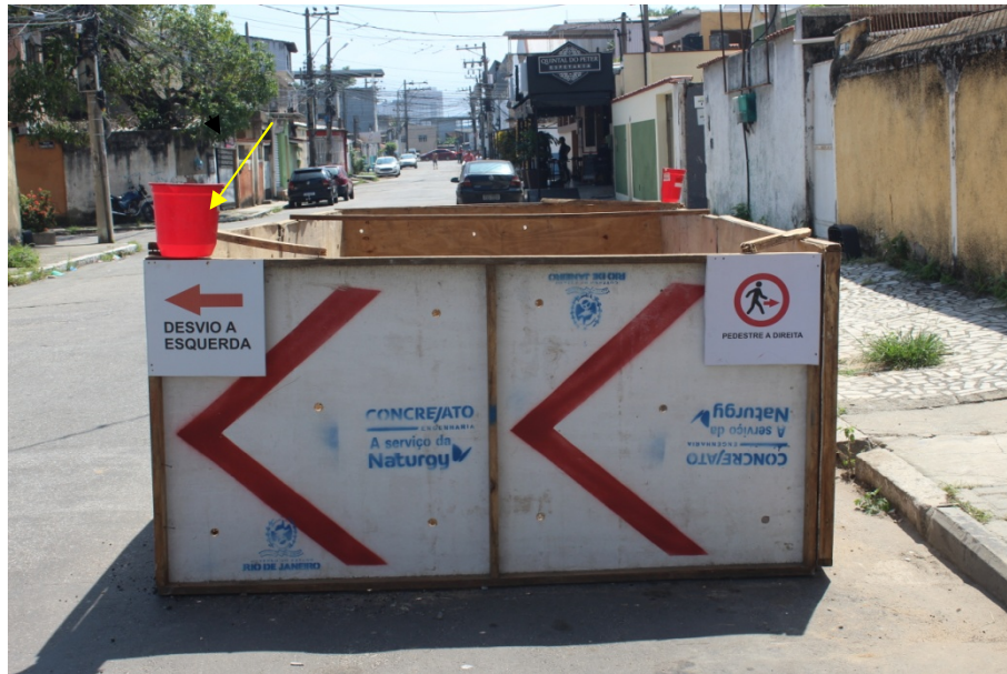
Foto 7: Isolamento de obra com sinalização noturna sem faixa refletiva.
