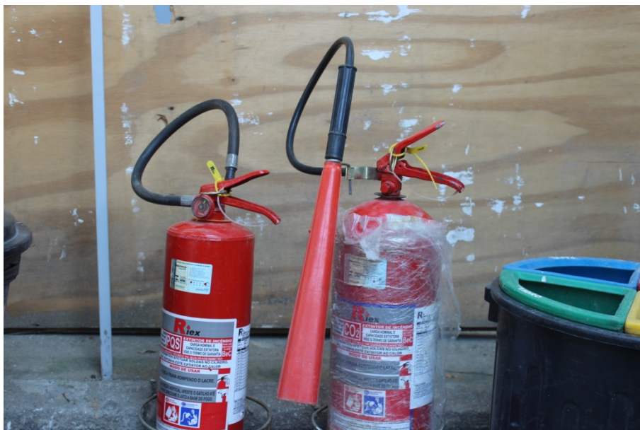
Foto 9: Extintores de incêndio presentes na área de vivência.
