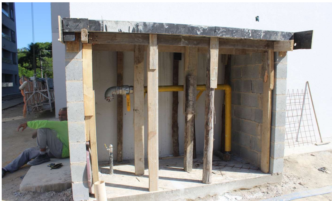
Foto 3 : Ponto de instalação do regulador de pressão.
