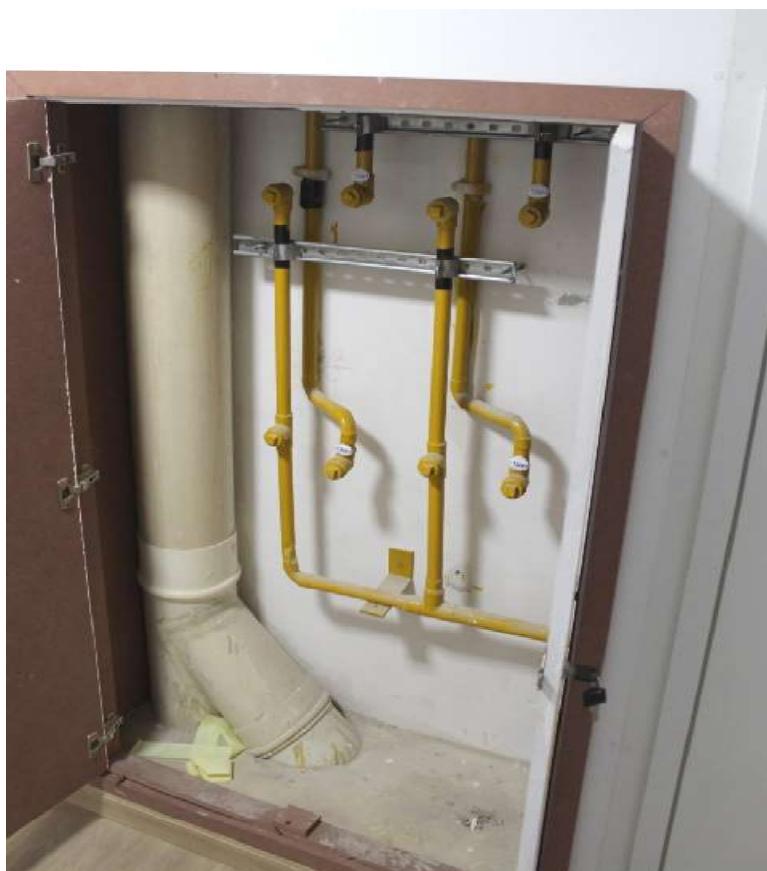
Foto 4 : Cabine de medidores instaladas nos andares.
