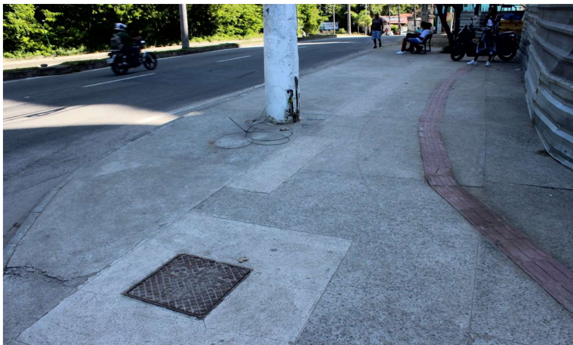
Foto 1 : Válvula de interligação da rede nova com a rede existente.
