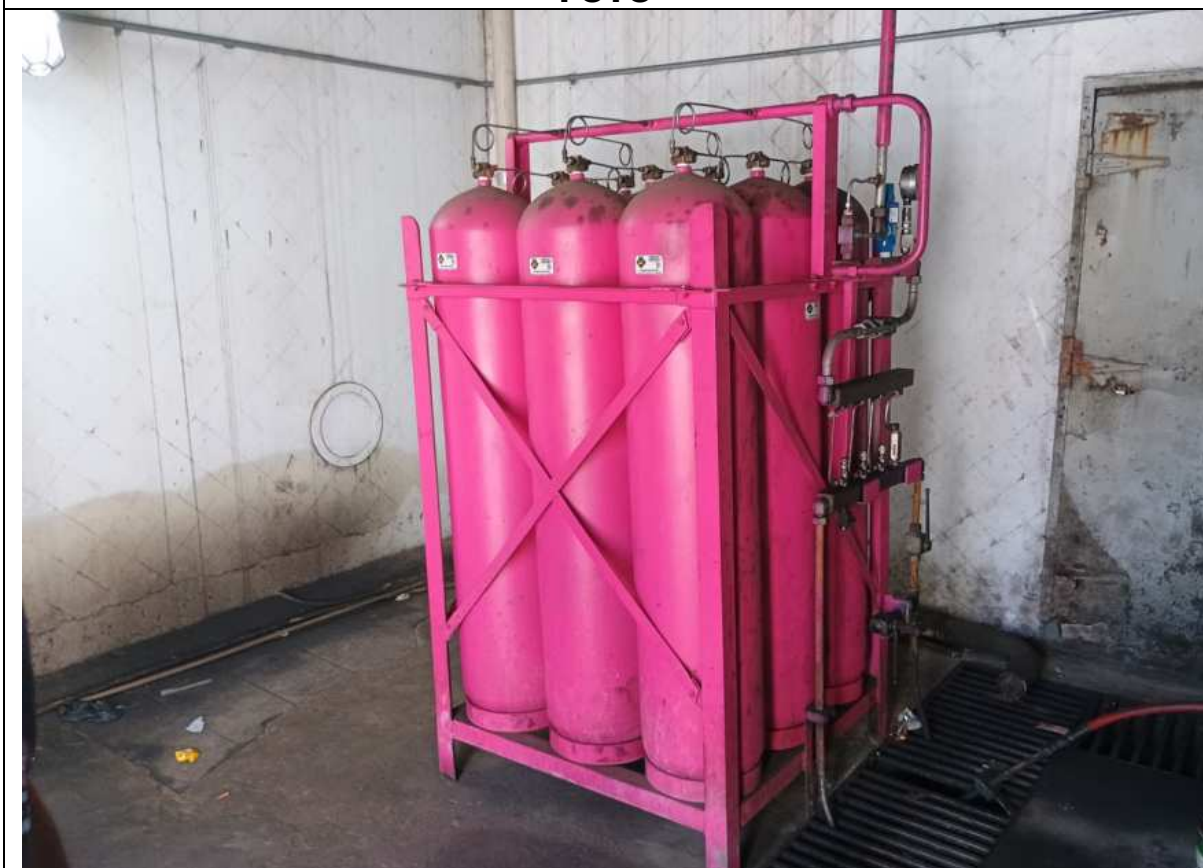
Foto 4: tanques de armazenamento do posto Rotor.
