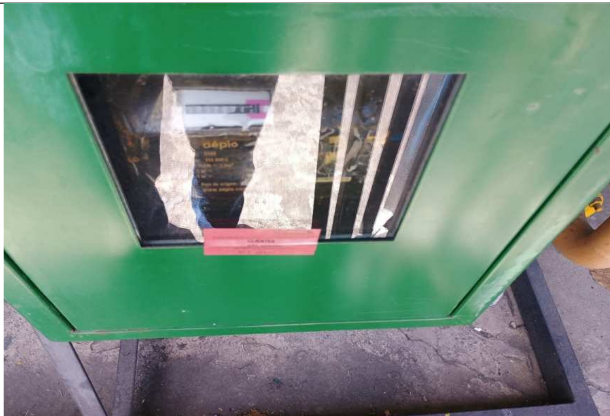
Foto 1: medidor de gás de entrada do posto Rotor.
