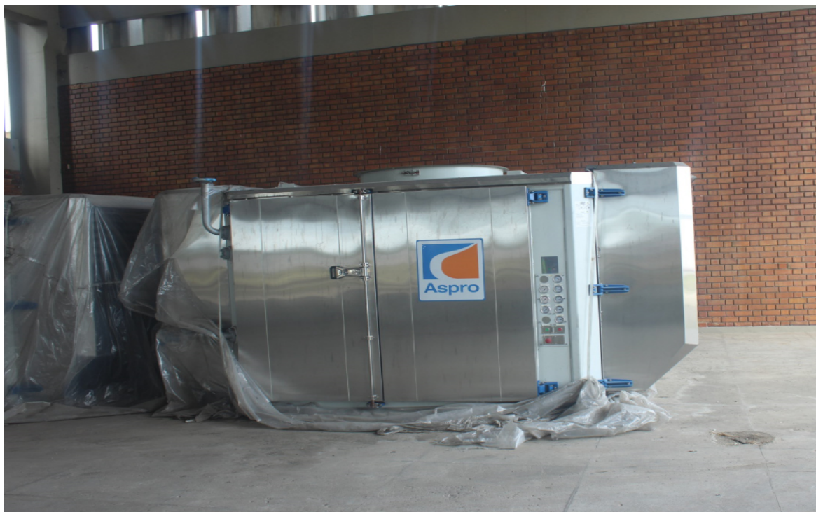
Foto 13: Equipamento novo desprotegido
