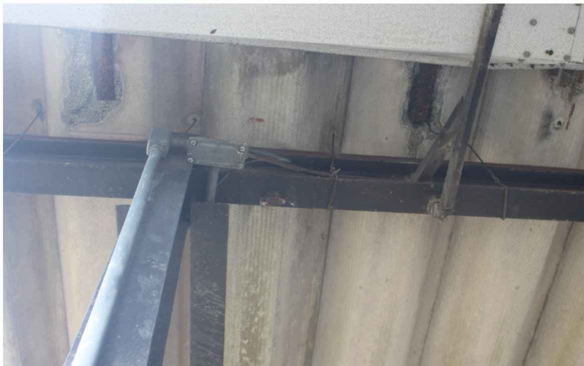
Foto 19: Estrutura do telhado e mãos francesas enferrujadas
