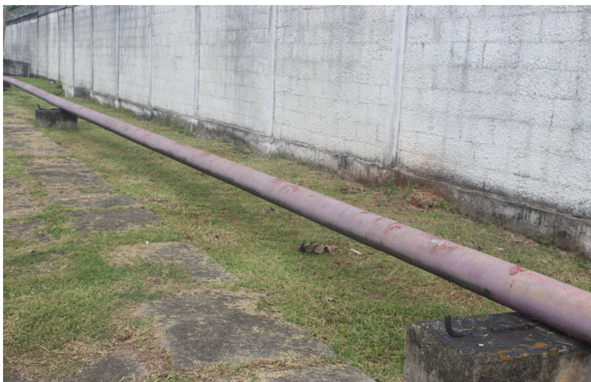
Foto 10: Tubulação de combate a incêndio com pintura gasta por toda a estação
