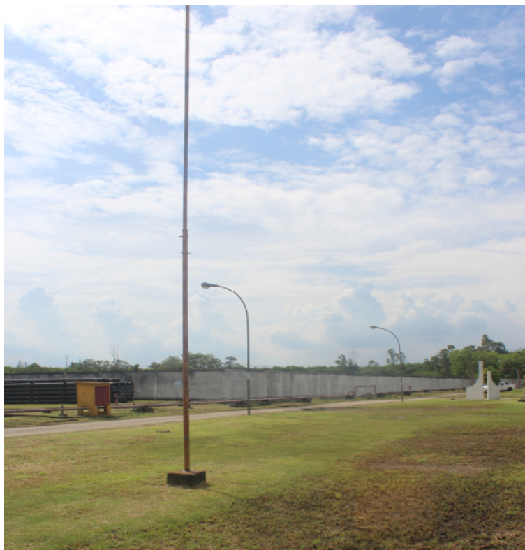
Foto 20: Pára-raio com pintura desgastada
