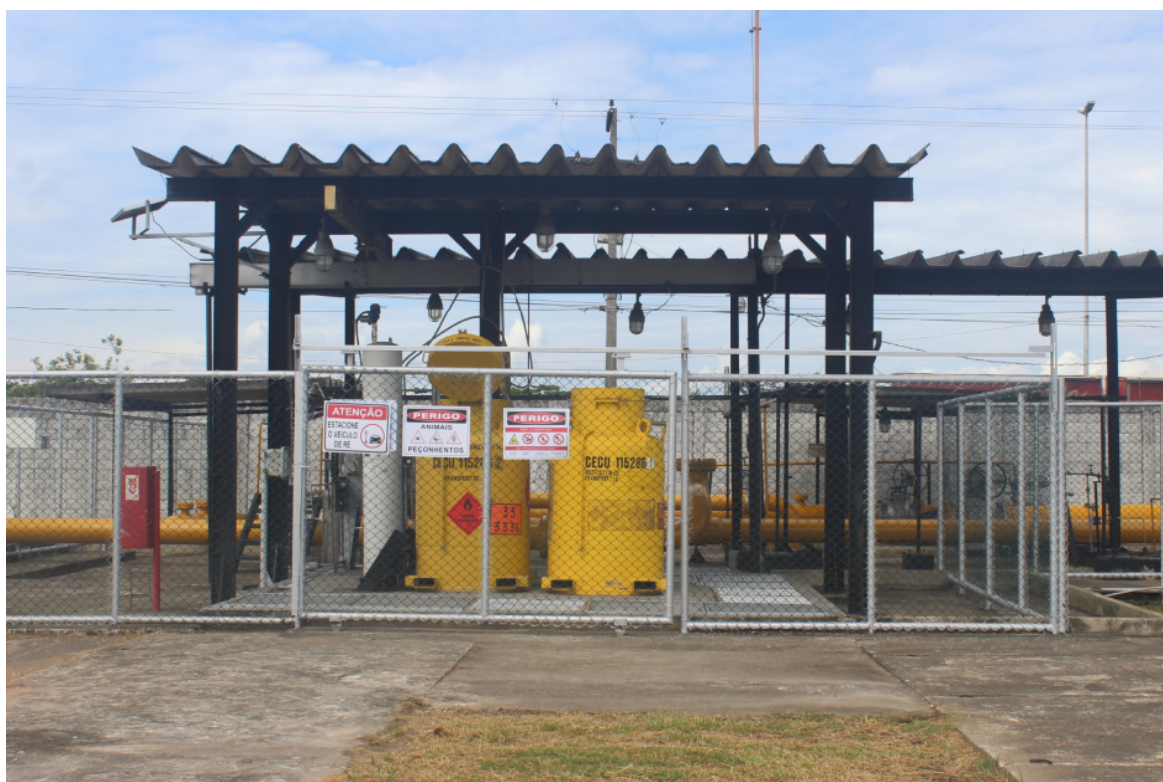
Foto 16: Estação de odoração
