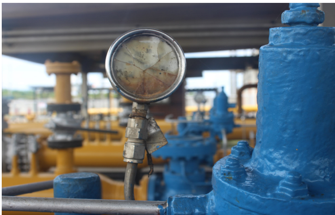
Foto 6: Dispositivo em mau estado de conservação
