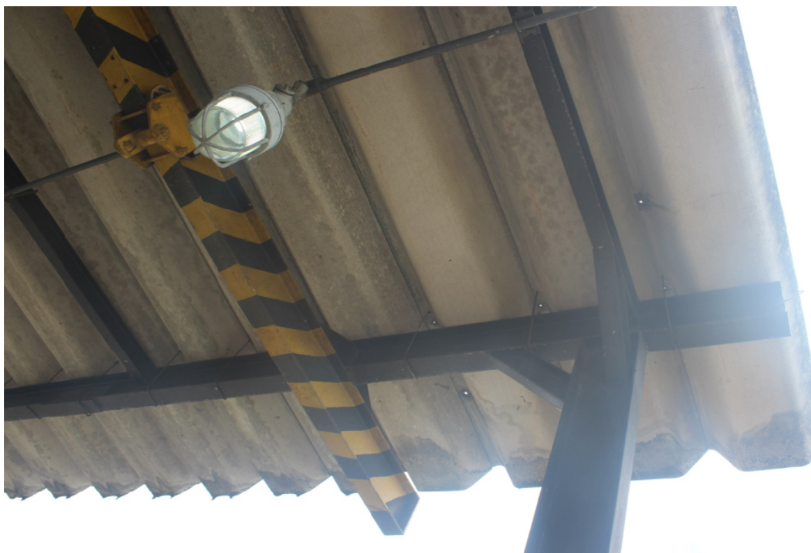
Foto 18: Telhado com furos
