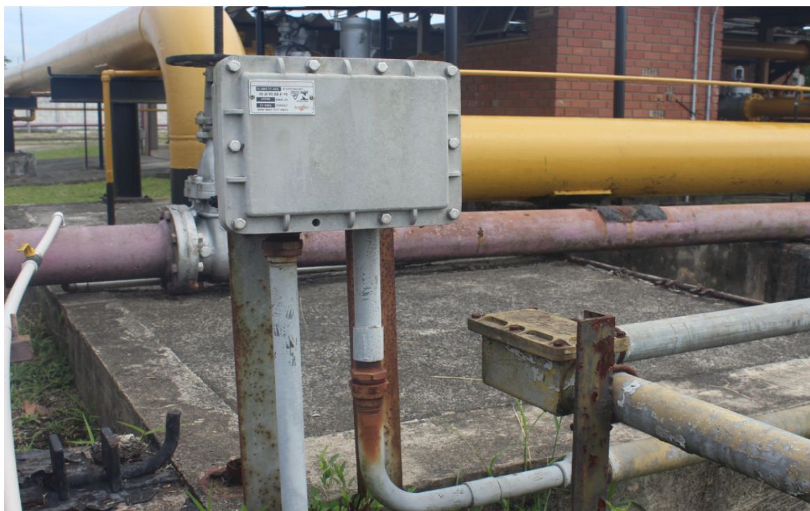
Foto 15: Pintura desgastada e enferrujada
