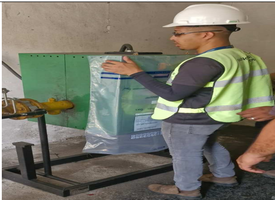
Foto 7: Equipe da Concessionária procede com o lacre da caixa do medidor após constatar suspeitas de problemas.
