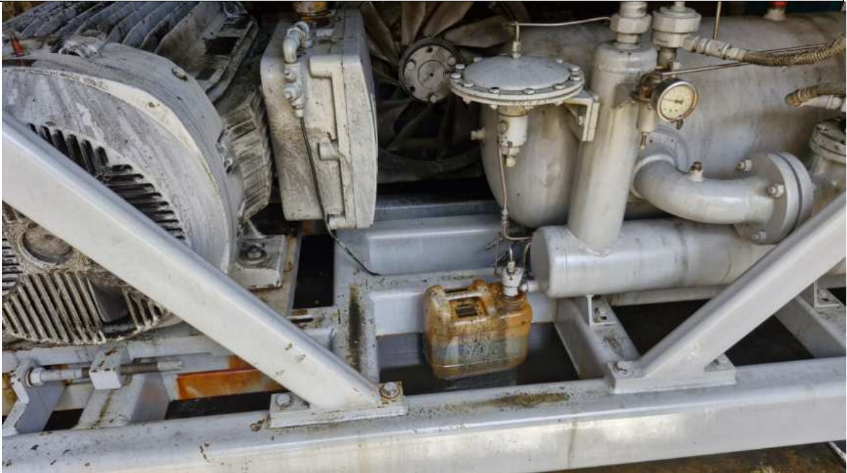
Foto 5: Compressor do Posto, com vazamento de óleo visível.
