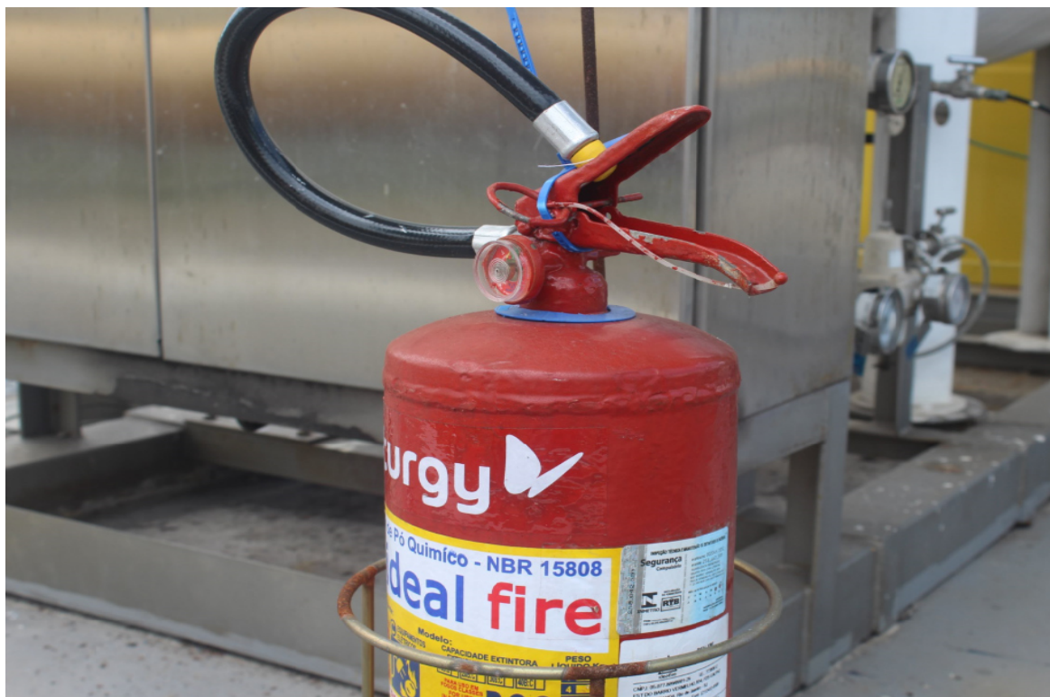
Foto 7: Extintor de incêndio
