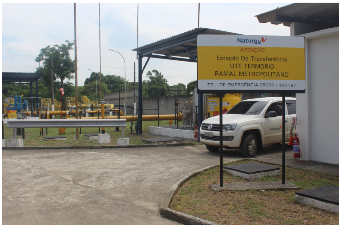
Foto 1: Placa de identificação da Estação
