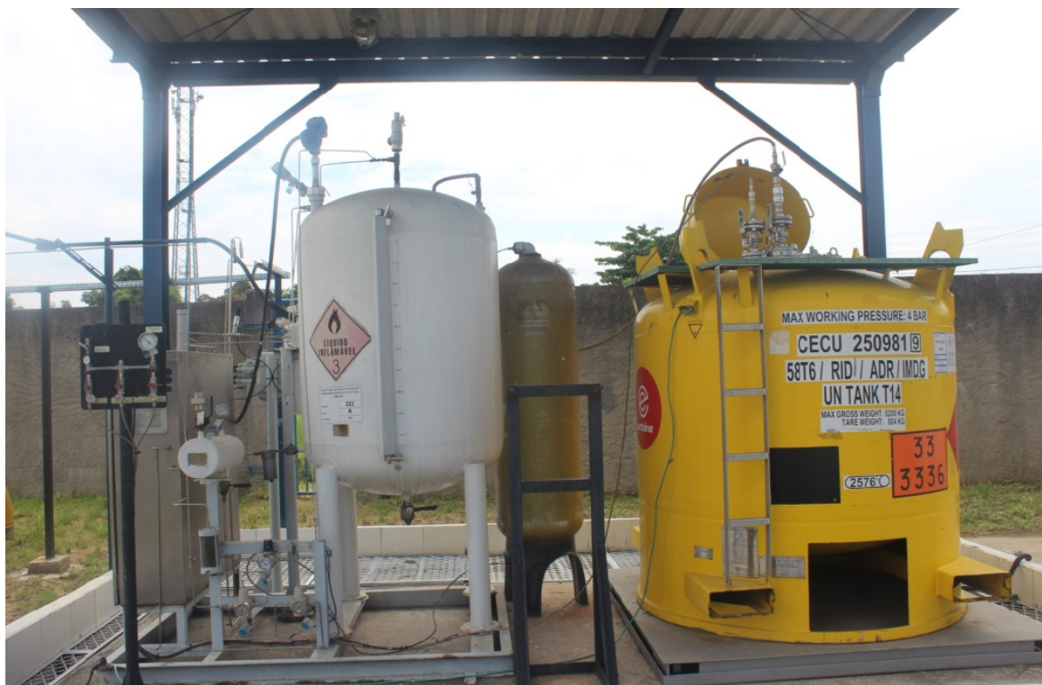
Foto 5: Sistema de injeção de mercaptana
