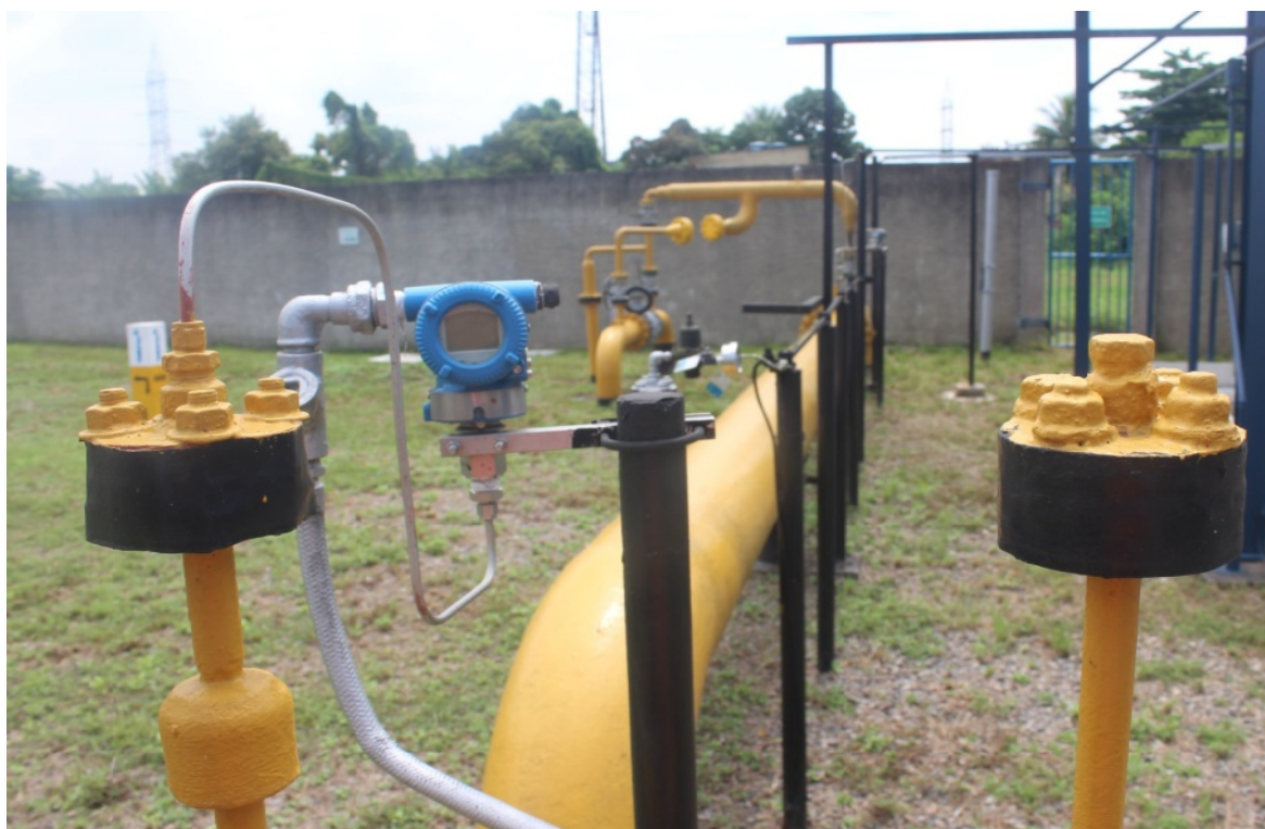
Foto 6: Um dos manômetros sem funcionamento
