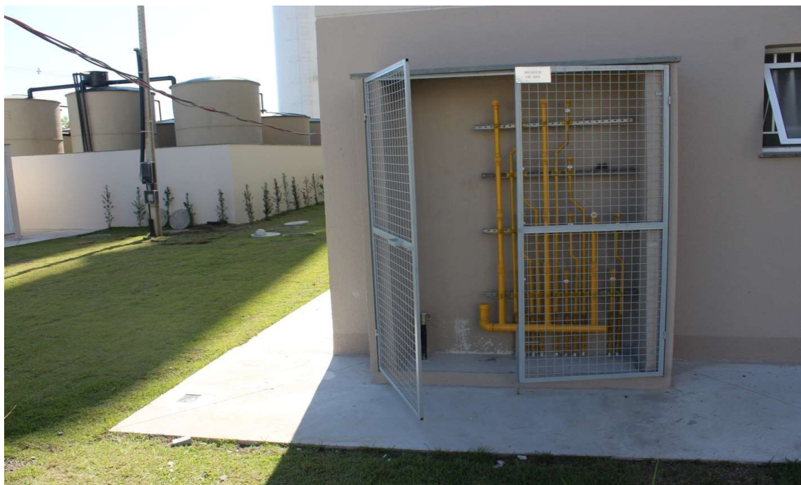
Foto 3 : Instalações internas preparadas para receber os reguladores e os medidores.
