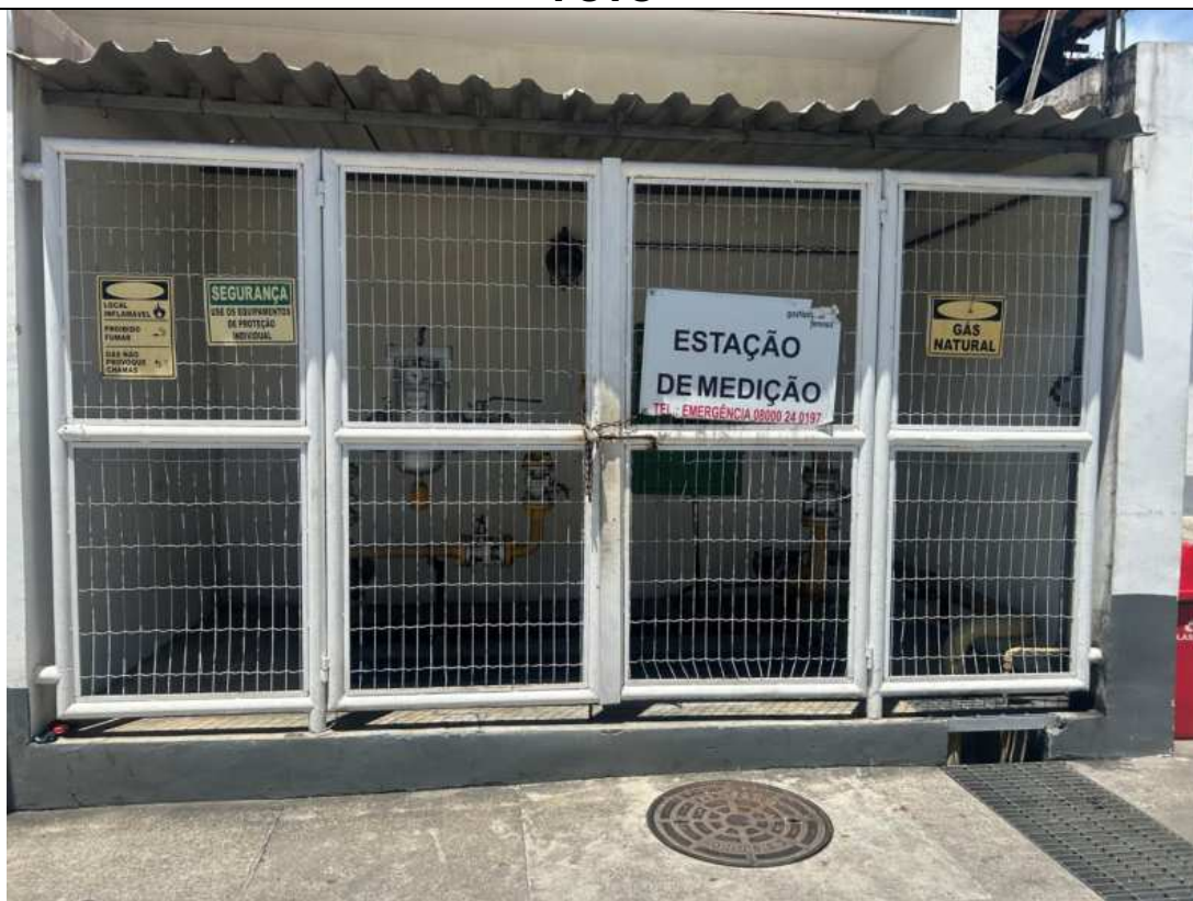
Foto 6: Entrada da estação de medição do Posto Monsenhor Escrivá Ltda.
