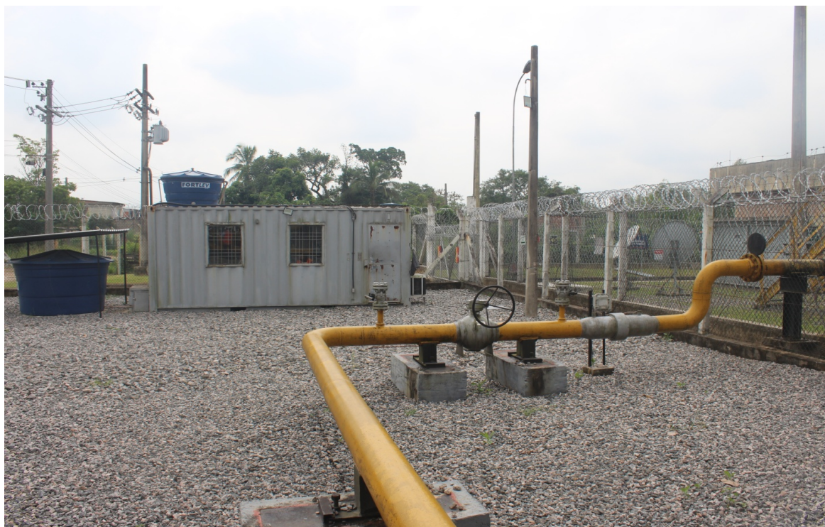
Foto 3: Tubulação de entrada
