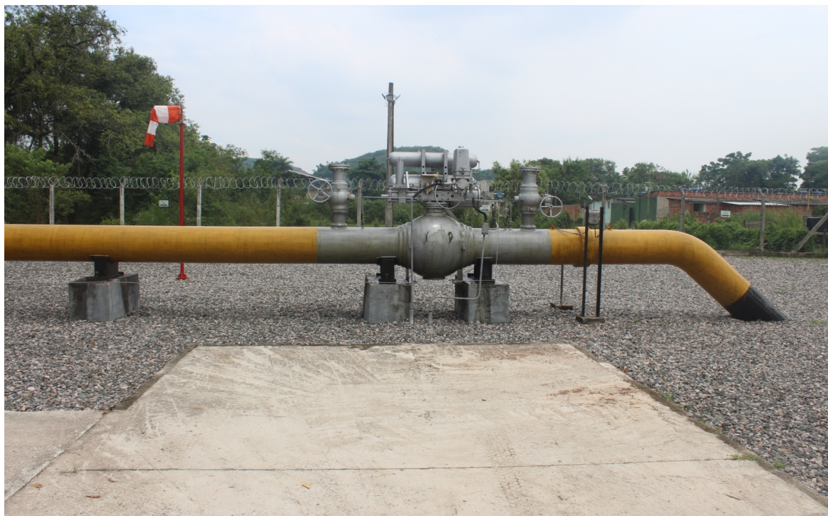
Foto 17: Válvula telecomandada e rede de saída
