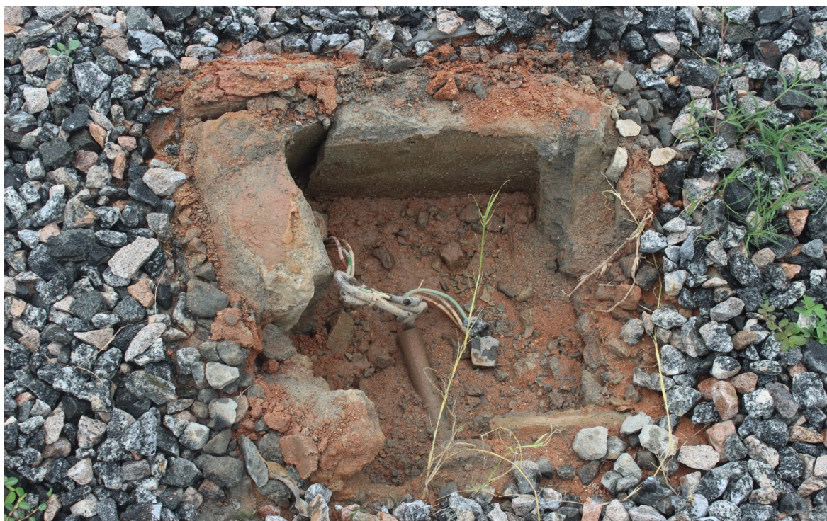
Foto 9: Caixa de passagem danificada (antes)
