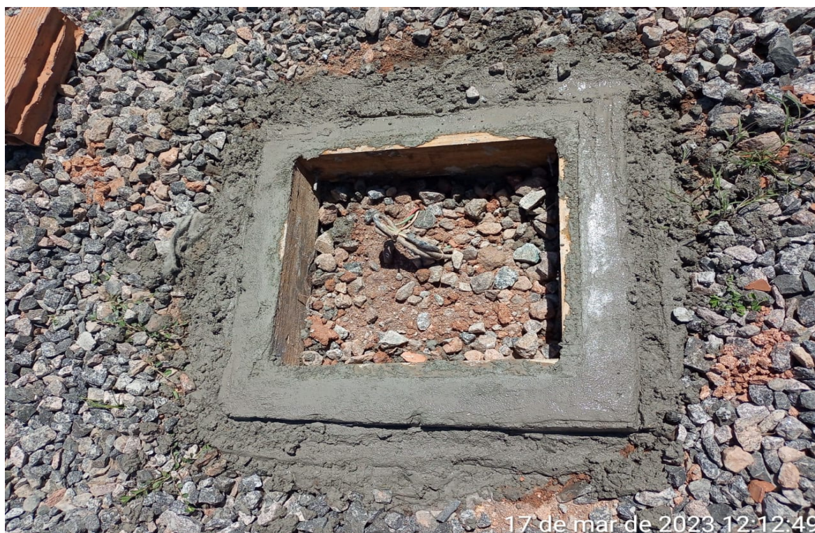
Foto 10: Caixa de passagem danificada (depois)
