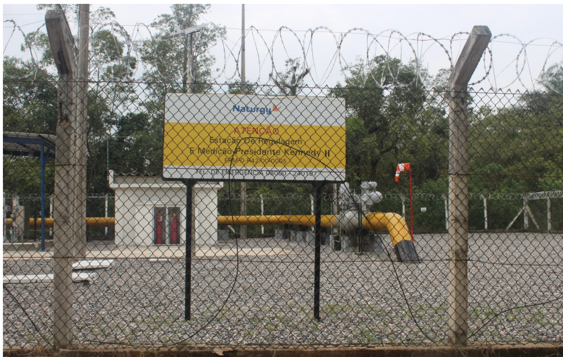
Foto 1: Placa de identificação da Estação
