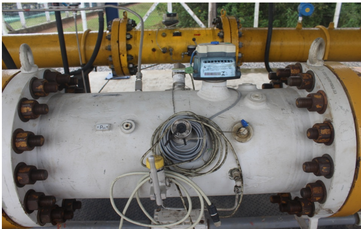
Foto 14: Medidor de vazão
