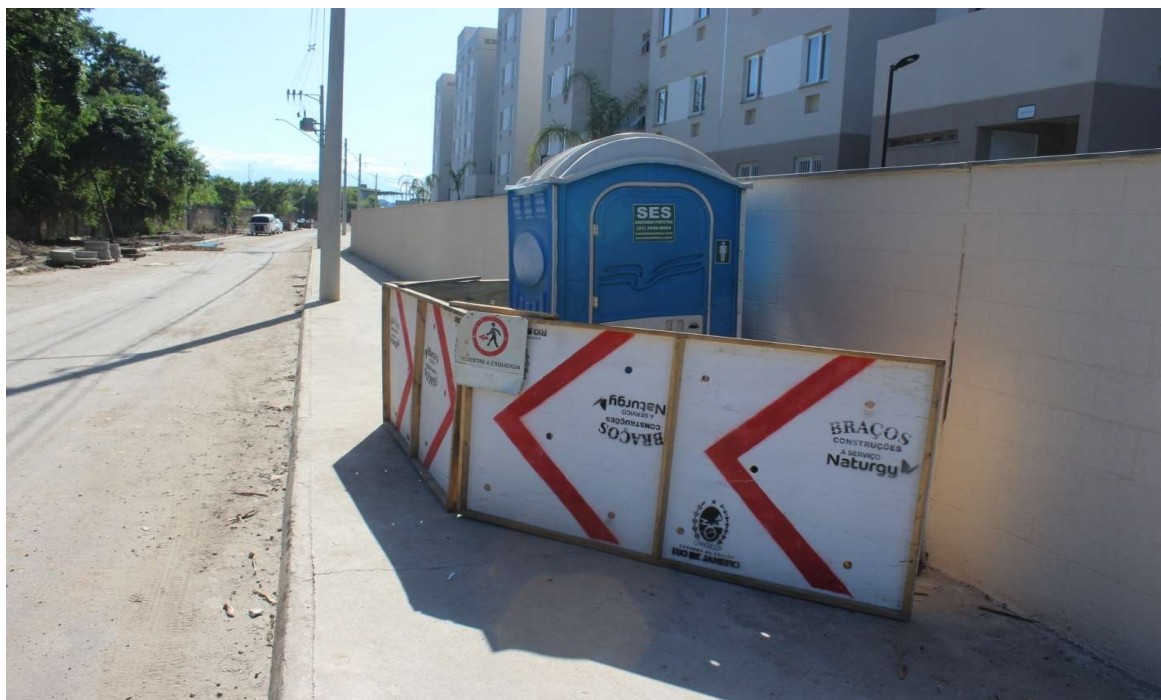
Foto 3 : Banheiro químico para atender os funcionários da Concessionária.
