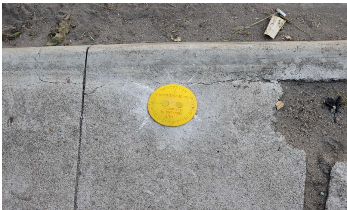
Foto 4 : Marco plano identificando a existência de rede de gás natural
