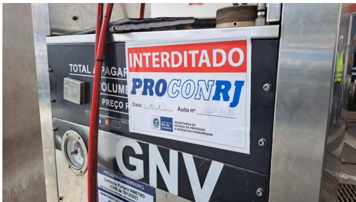
Foto 11: Posto Progresso – Bomba GNV Lacrada
