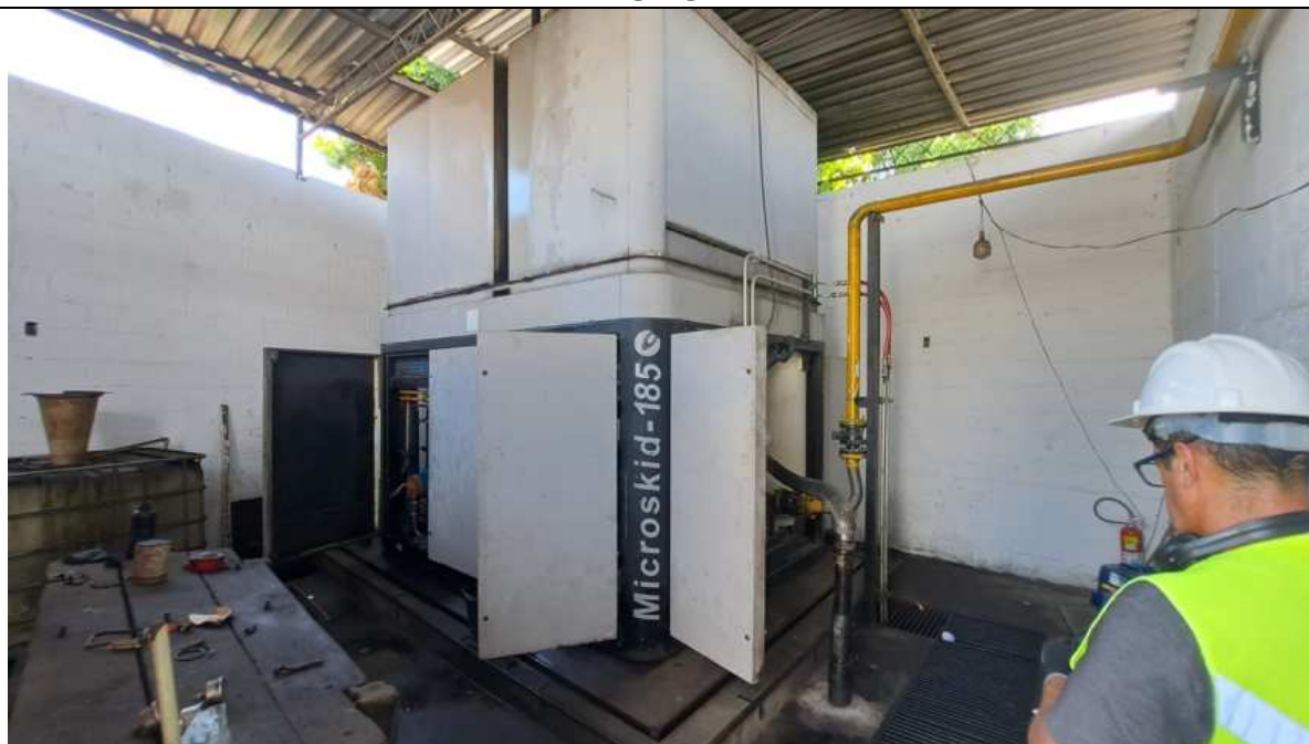
Foto 7: Posto Progresso – Compressor 4 estágios
