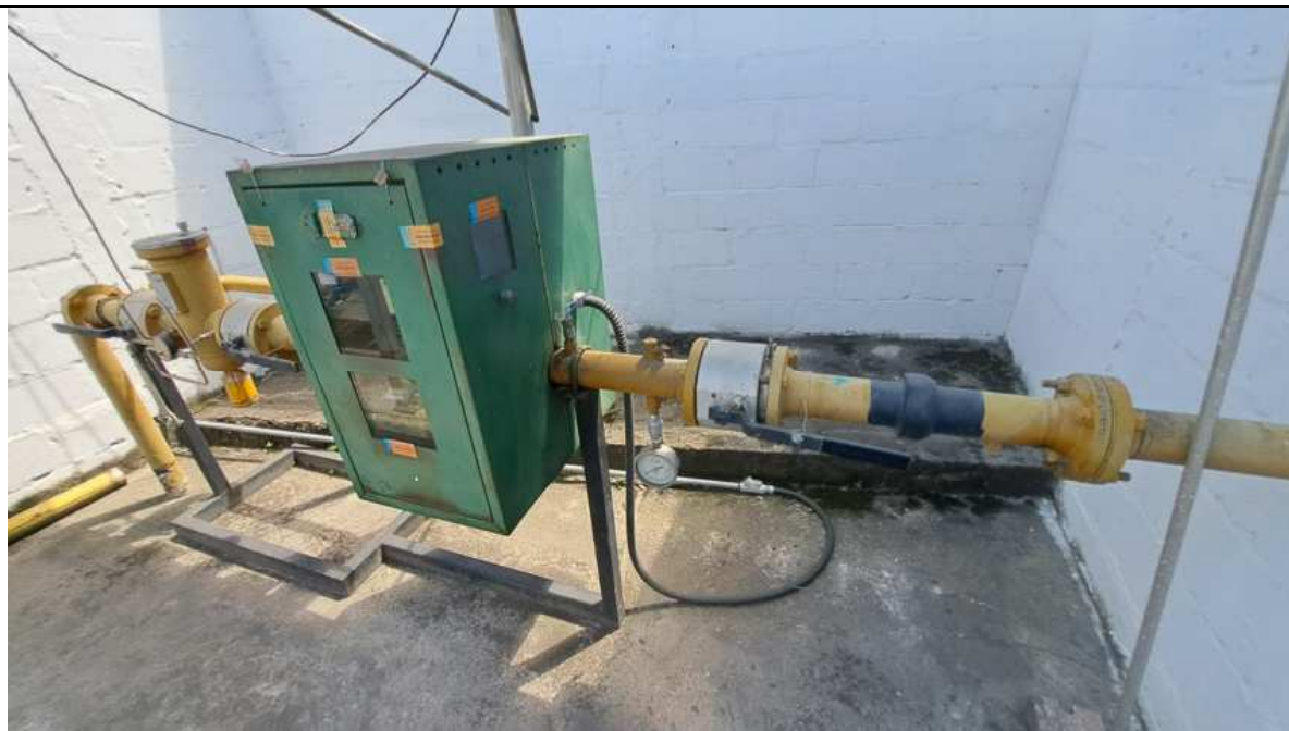
Foto 6: Posto Progresso – Módulo de Medição
