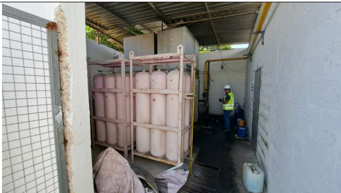
Foto 9: Posto Progresso – Cilindros de estocagem em alta pressão
