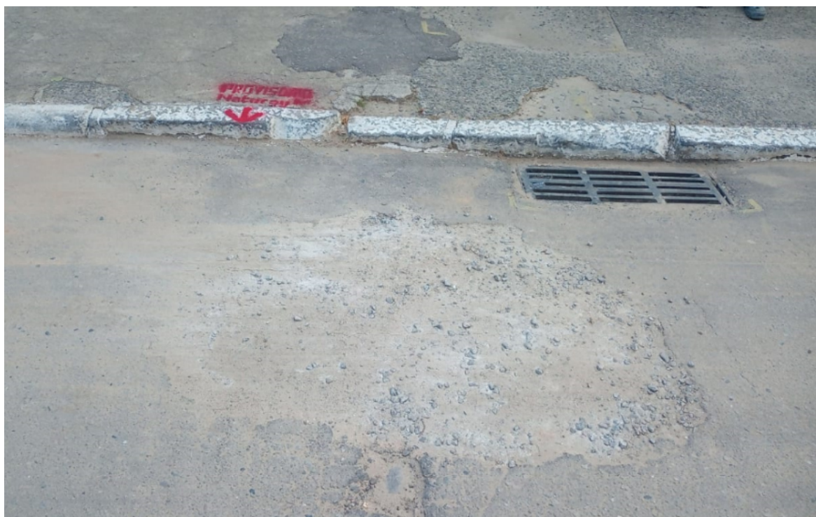
Foto 7: Recomposição provisória após calço hidráulico
