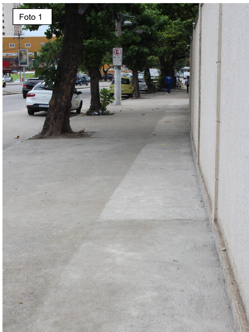
Foto 1: calçamento da Av. Dom Hélder Câmara, nº 3443
