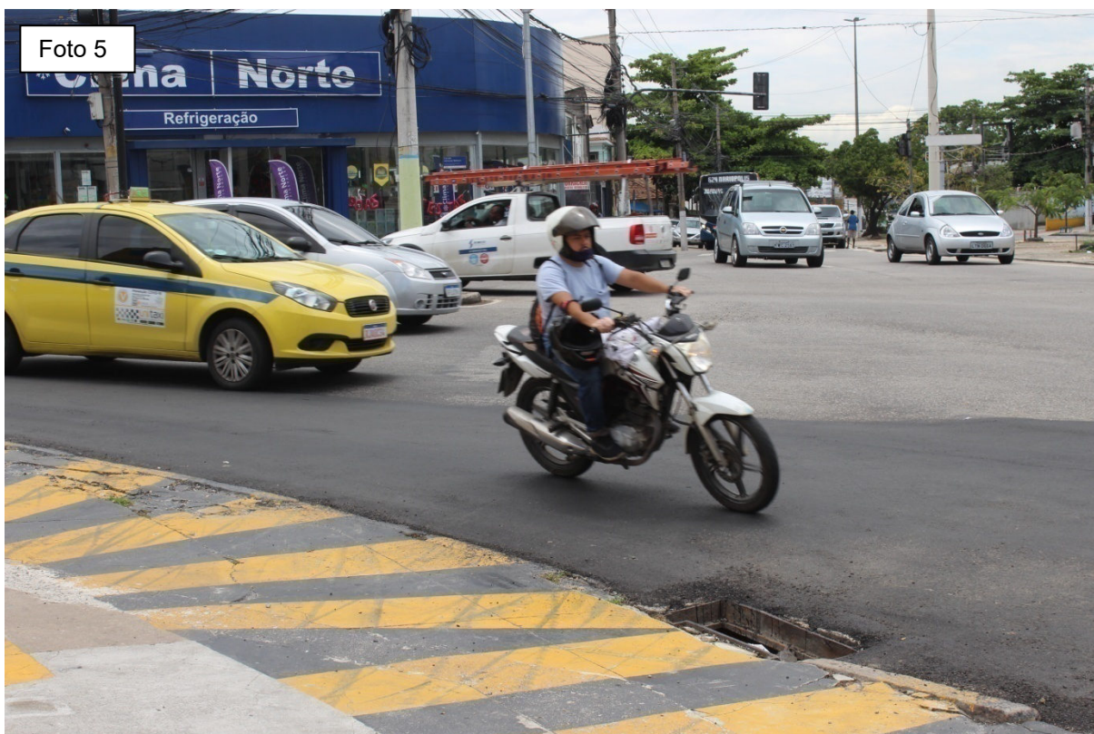
Foto 5: avaria em “boca de lobo” na Estrada Adhemar Bebiano com a Avenida Dom Hélder Câmara
