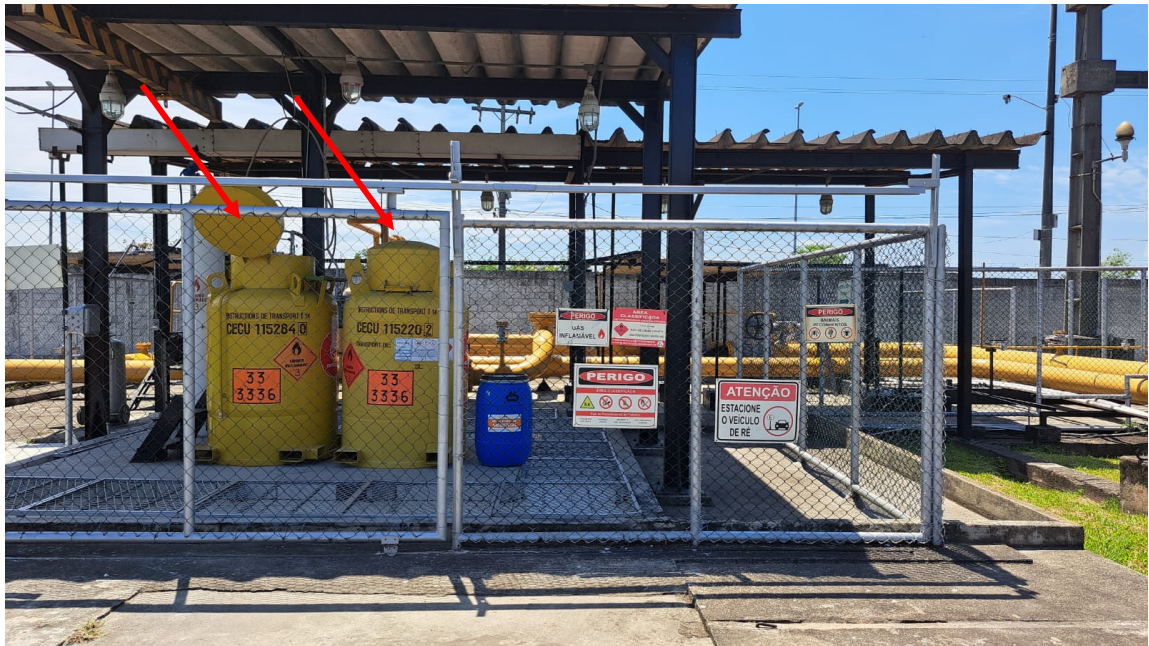
Foto 3: Sistema de Odorização composto por dois containers de mercaptana.
