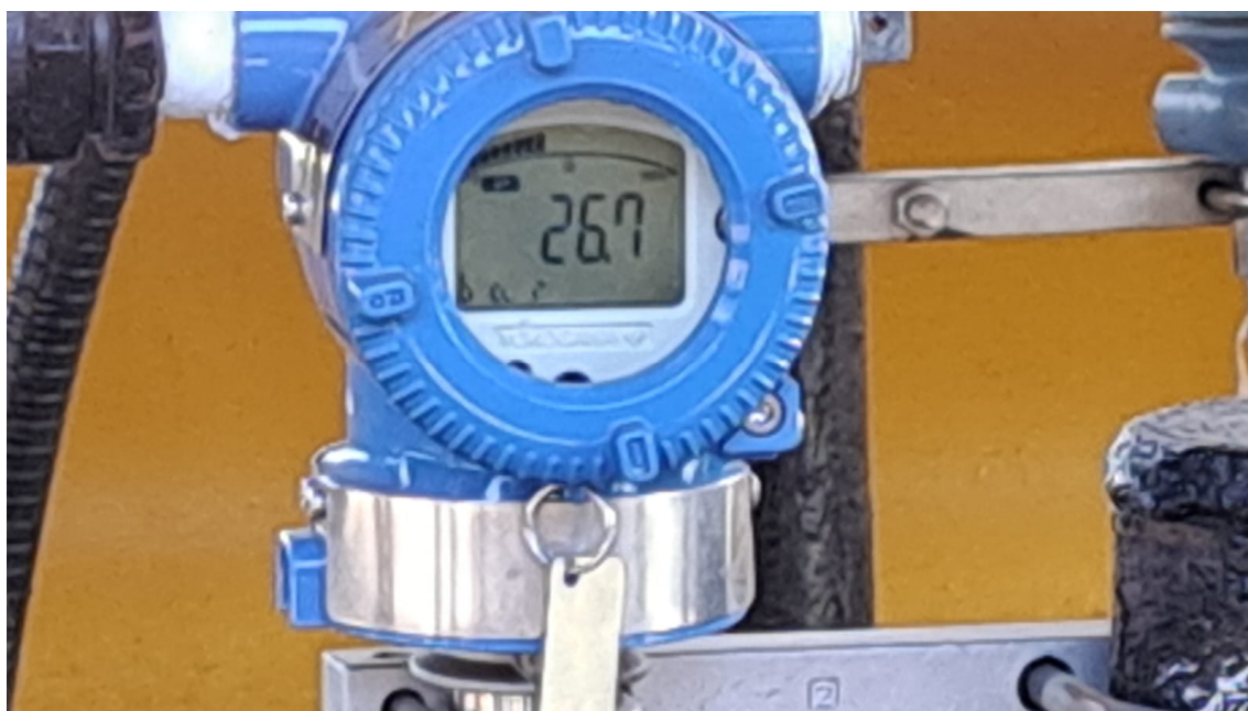
Foto 8: Medidor de pressão no Módulo de Medição.
