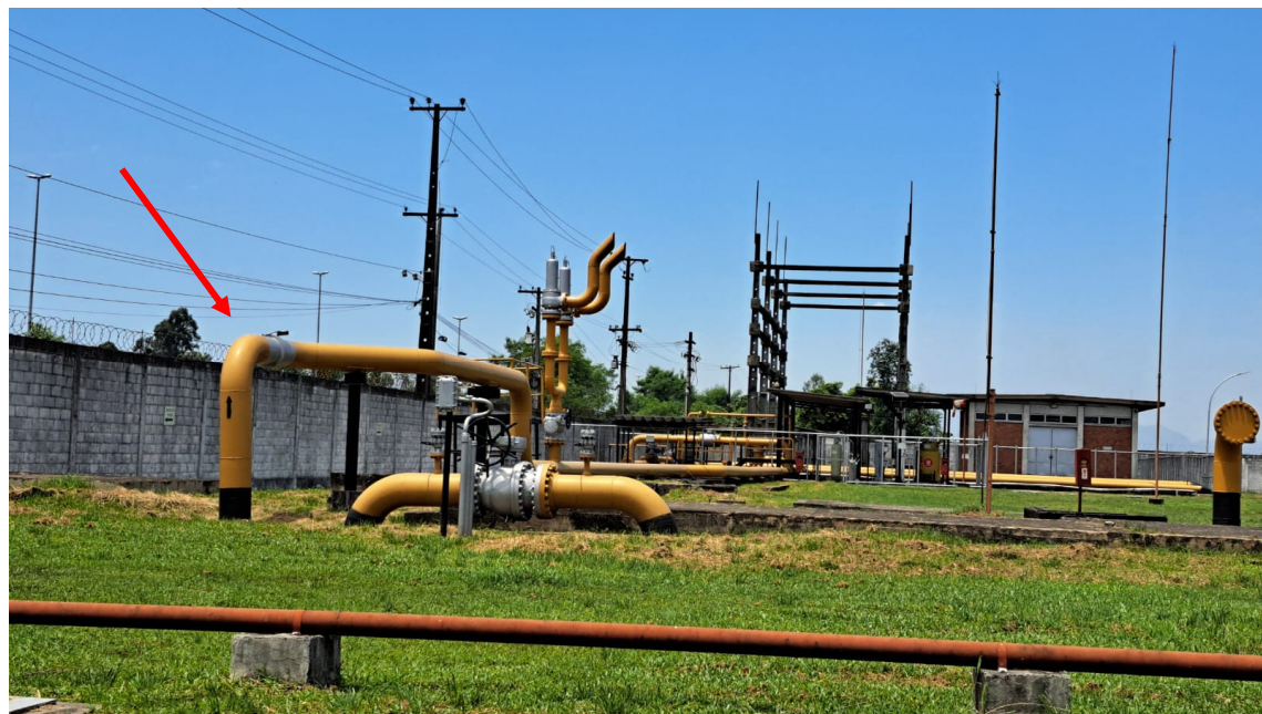
Foto 2: Linha de entrada da Estação, proveniente da Estação de Transferência localizada em Campos Elíseos, Duque de Caxias.
