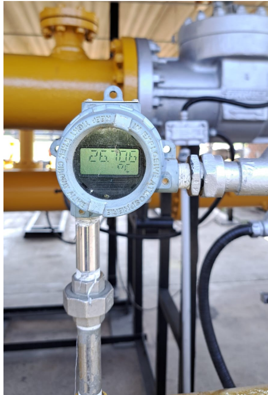
Foto 9: Medidor de temperatura no Módulo de Medição.
