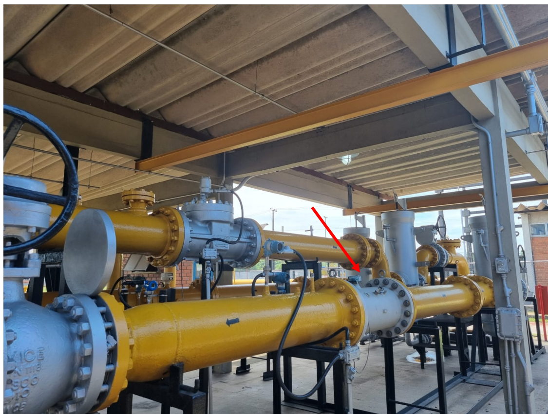
Foto 7: Medidor tipo turbina.
