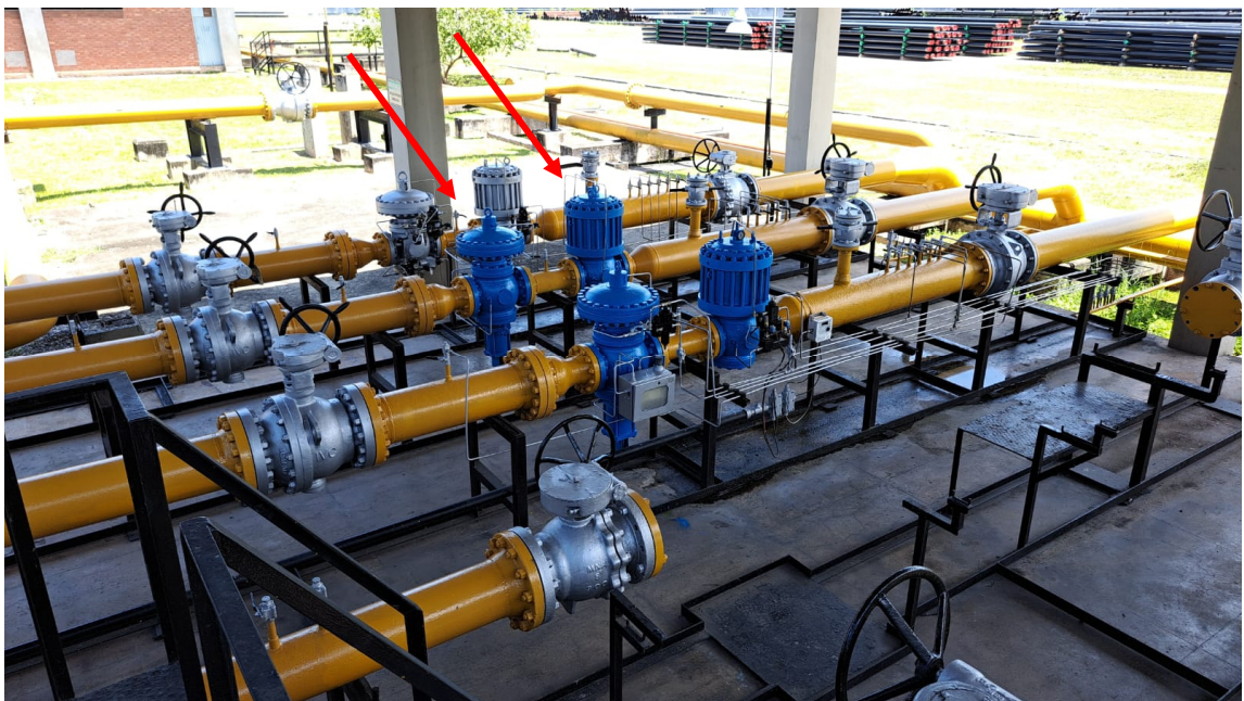
Foto 10: Módulo de Regulagem de Pressão, com destaque para as válvulas que reduzem a pressão de 26 para 12 bar.
