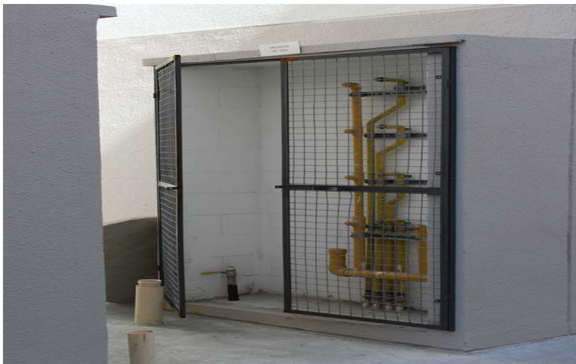
Foto 3 : instalação para regulador e medidores
