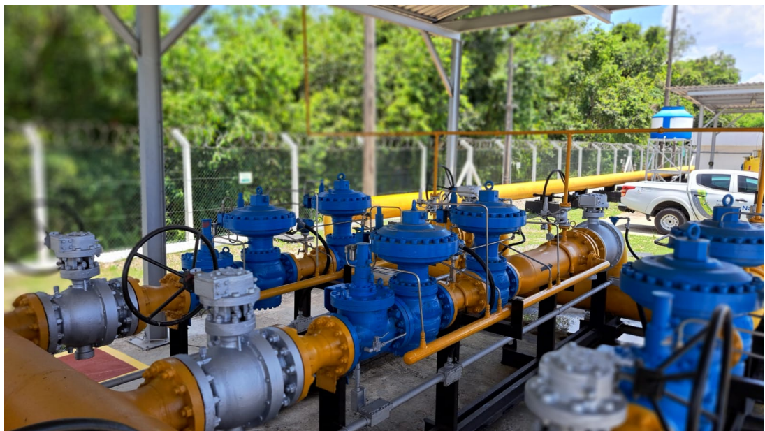
Foto 4: Módulo de Regulação de Pressão.
