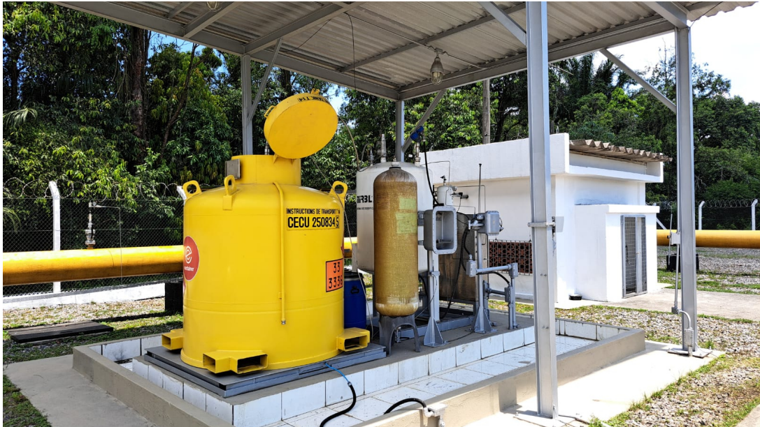
Foto 5: Sistema de Odorização.
