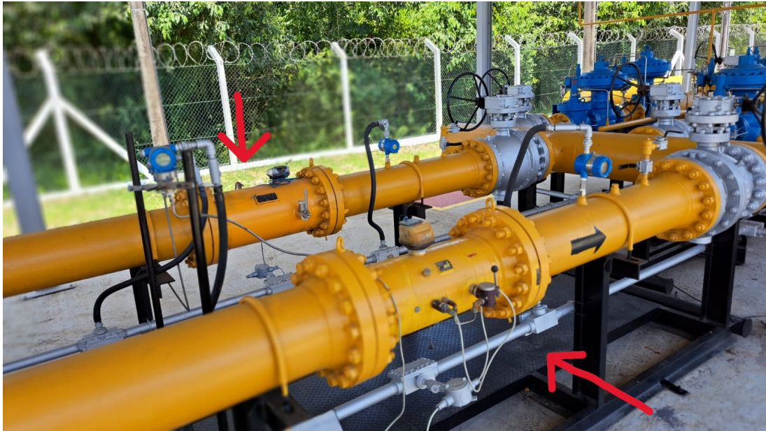
Foto 3: Medidores de Vazão Tipo Turbina.
