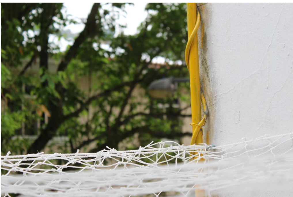
FOTO 6: Dreno de ar condicionado entrelaçado ao tubo de Gás Natural
