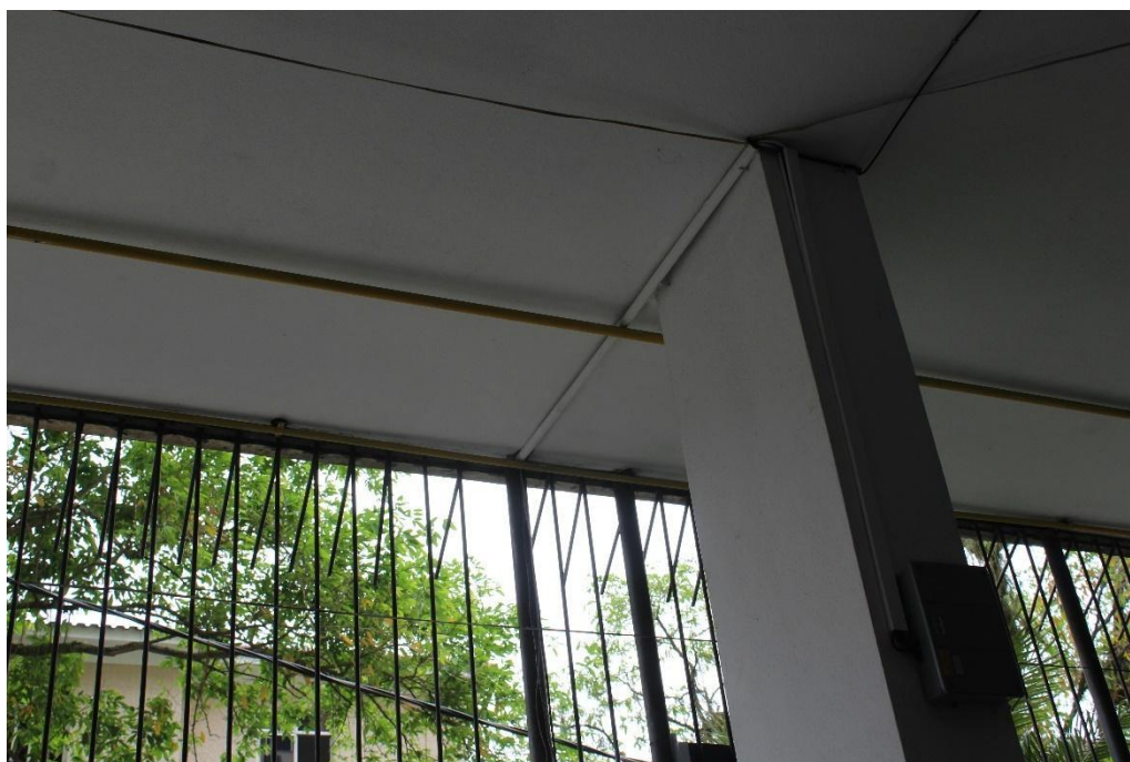
FOTO 14: Instalações de natureza elétrica a menos de 20 centímetros da tubulação de Gás Natural.
