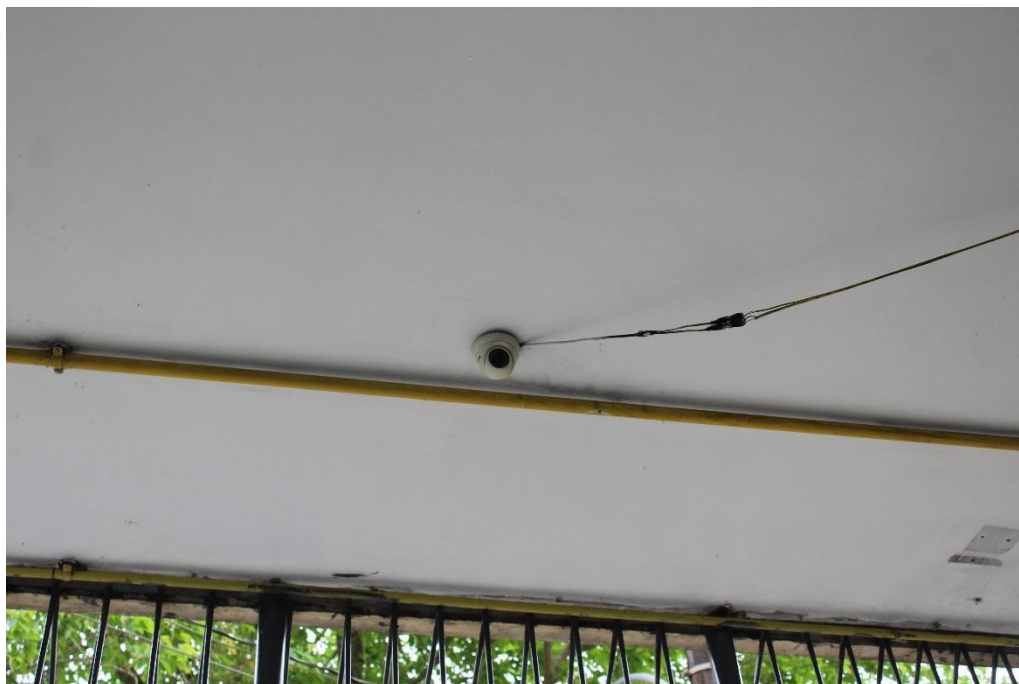
FOTO 13: Instalação de natureza elétrica a menos de 20 centímetros da tubulação de Gás Natural
