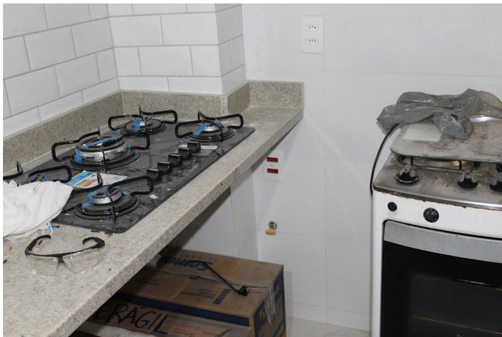
FOTO 1: Ponto de Gás Natural e ponto de energia elétrica.
