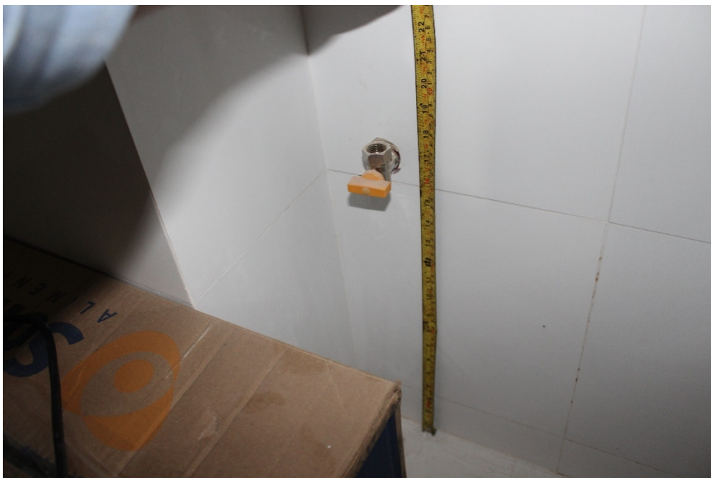
FOTO 3: Ponto de Gás Natural com altura de 48 centímetros do chão.
