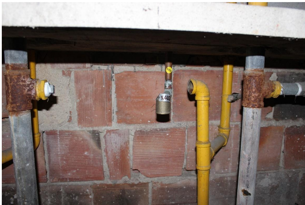
FOTO 15: Instalações da cabine de medidor do cliente. Sem o medidor.
