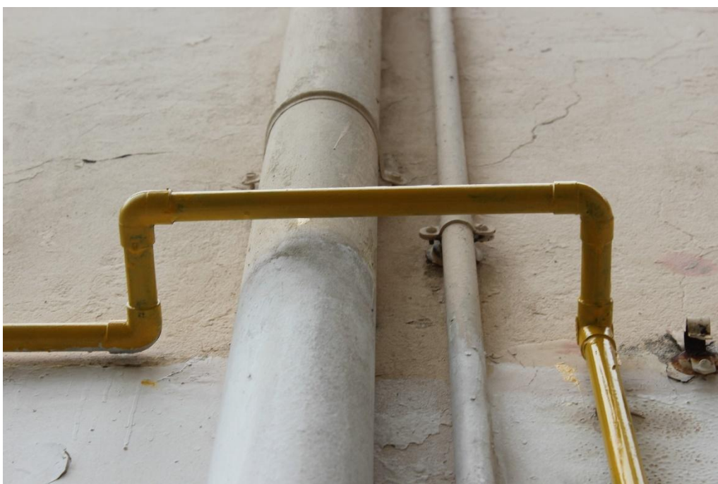
FOTO 4: Tubulação de água pluvial do prédio a menos de 20 centímetros das tubulações de Gás Natural.
