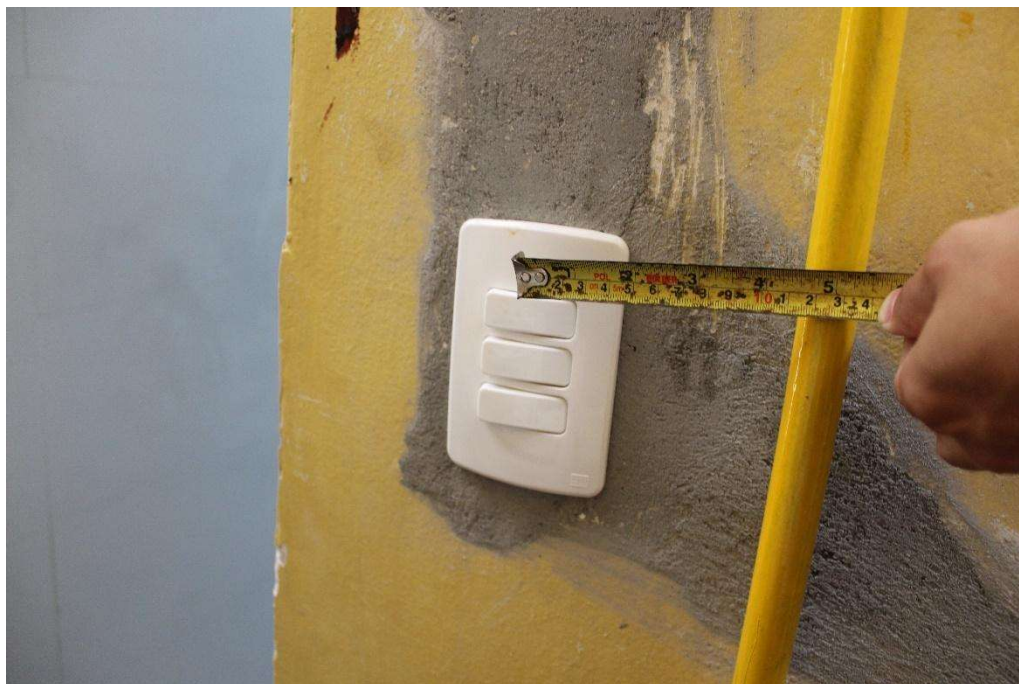
FOTO 7: Ponto de energia elétrica a menos de 20 centímetros da tubulação de Gás Natural.
