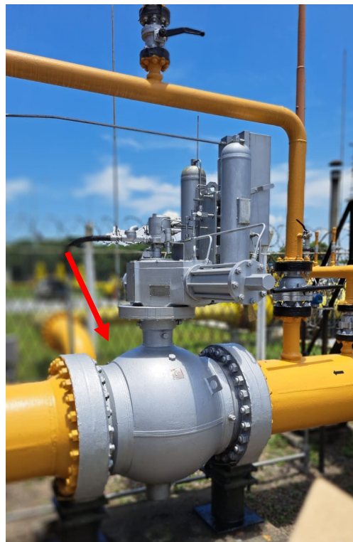
Foto 10: Válvula de bloqueio telecomandada.
