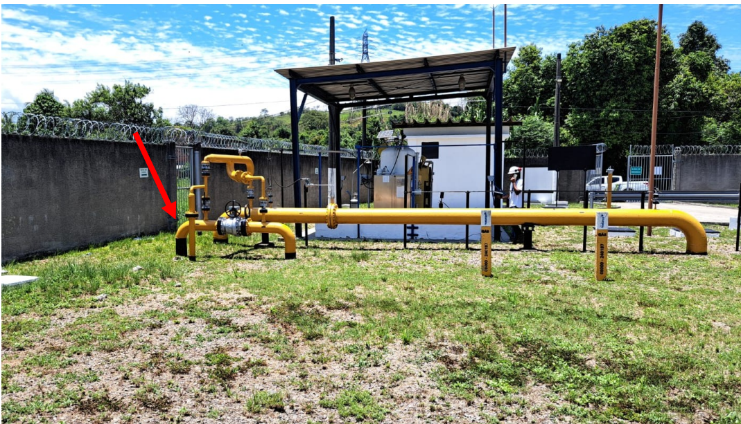
Foto 6: Saída da Segunda linha, destinada à Usina Termelétrica Termorio.
