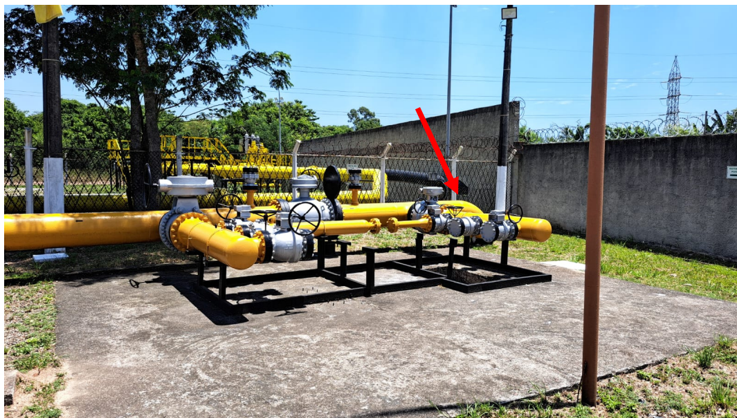
Foto 4: Saída da primeira linha, destinada à Estação de Modulação na Av. Washington Luiz.
