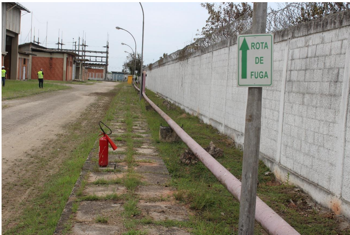
FOTO 19: Única sinalização de rota de fuga ao longo desta via – extintor de incêndio utilizado no combate às chamas.
