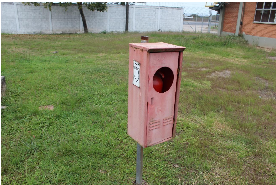
FOTO 25: Caixa de proteção de extintor em mal estado de conservação e etiqueta de identificação apagada.
