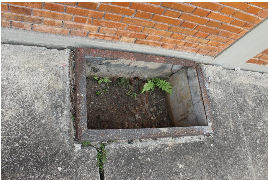
FOTO 13: Outra caixa de passagem de águas pluviais sem tampa.
