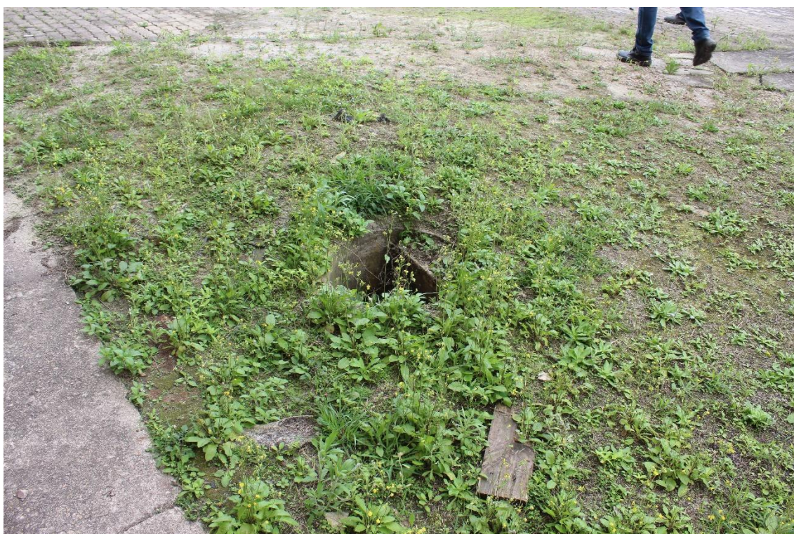
FOTO 14: Caixa de passagem de águas pluviais sem tampa em meio a vegetação.
