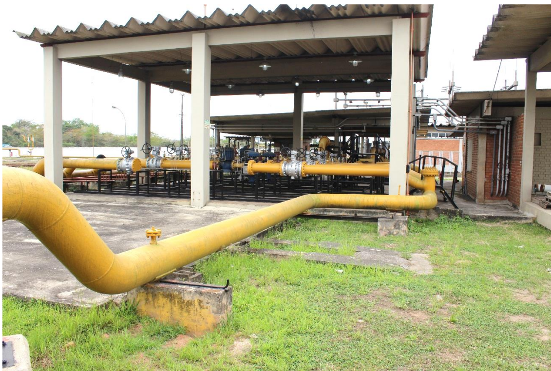
FOTO 21: Estação de Regulação e Medição - ERM.
