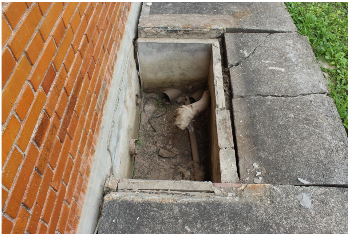
FOTO 11: Caixa de passagem de águas pluviais sem tampa.
