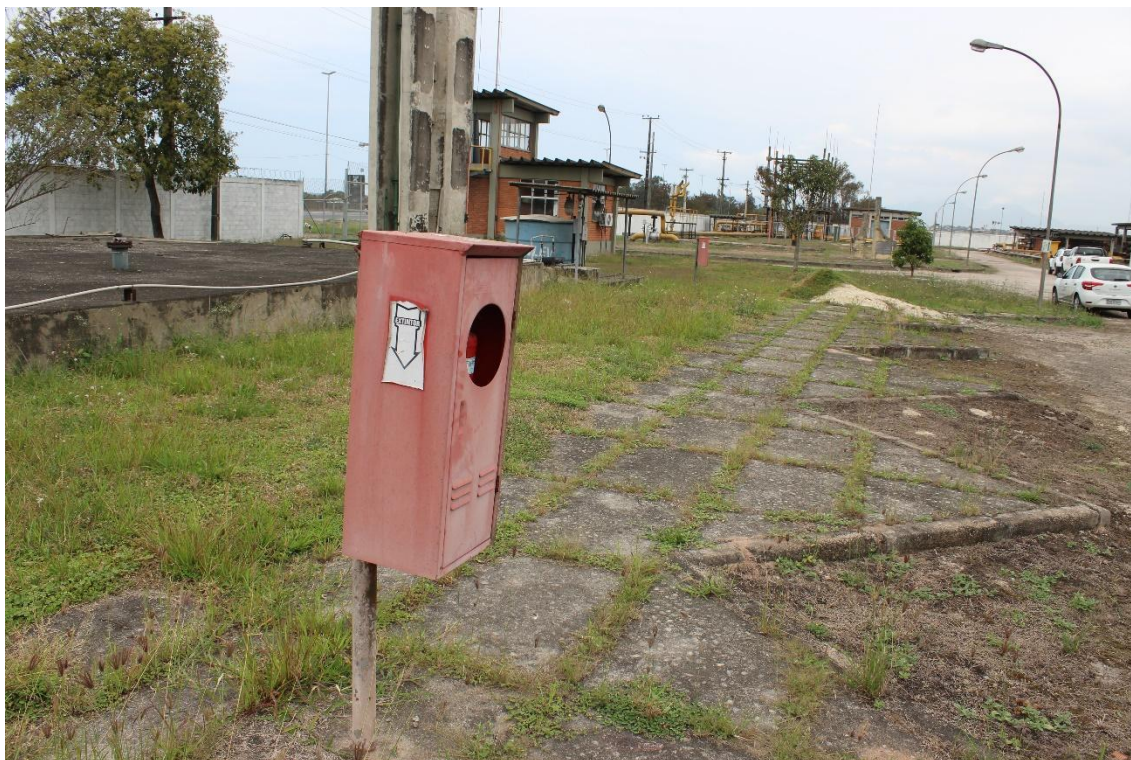
FOTO 26: Caixa de proteção de extintor em mal estado de conservação e etiqueta de identificação apagada.
