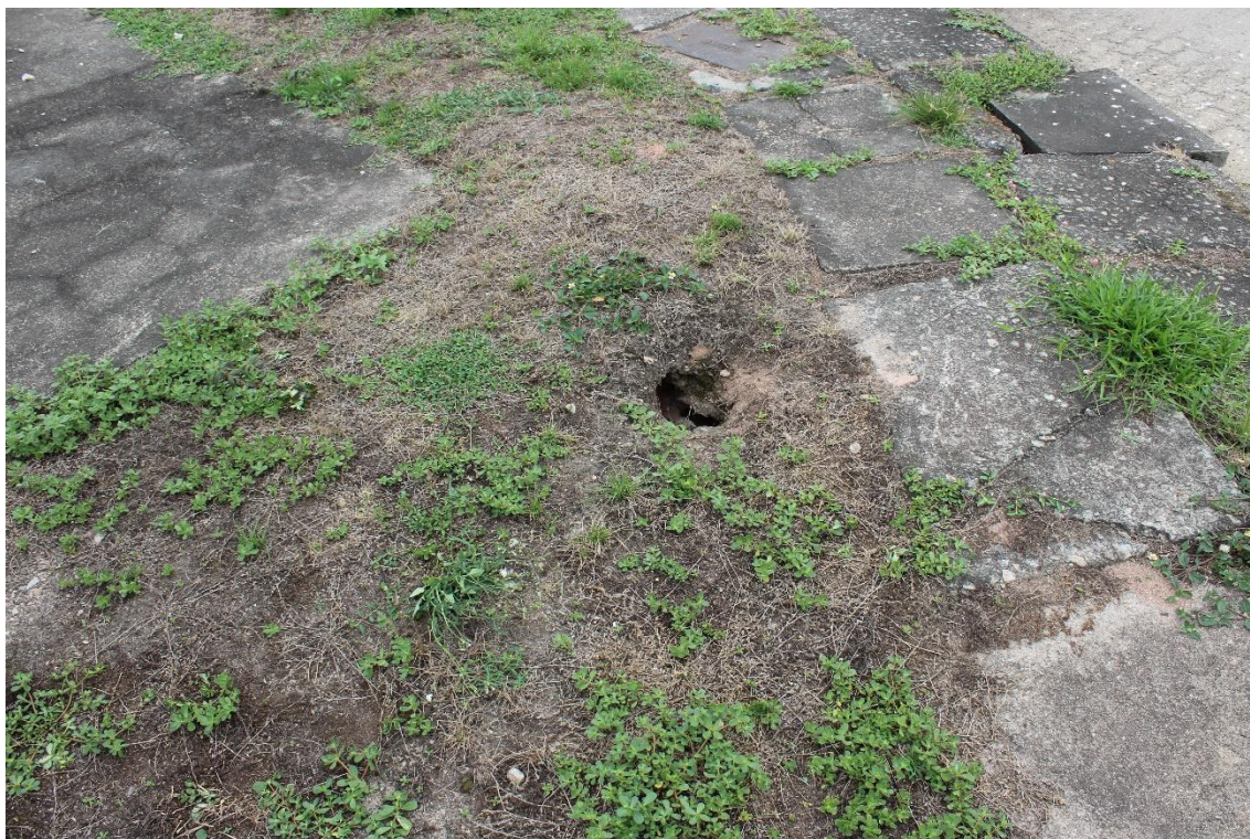
FOTO 17: Buraco em terreno, próximo ao calçamento, oferecendo riscos aos transeuntes.
