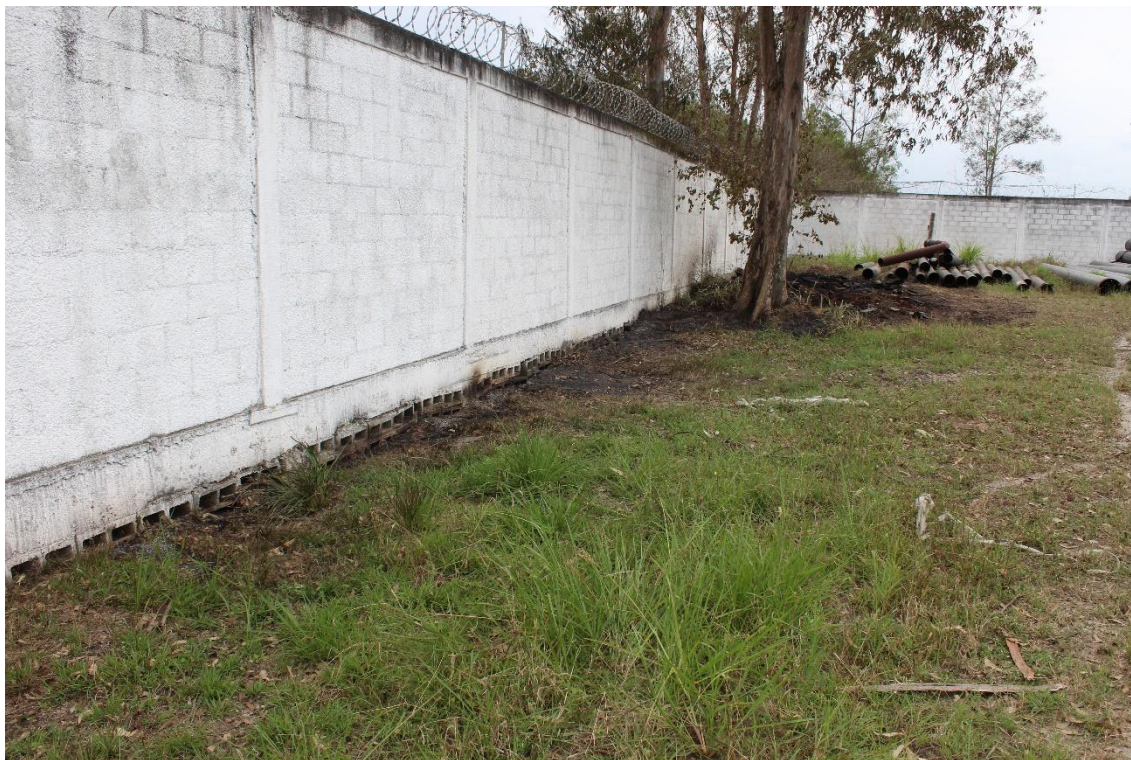
FOTO 1: Um dos focos de incêndio que se originou da propagação das chamas pelos furos de escoamento instalados no muro.
