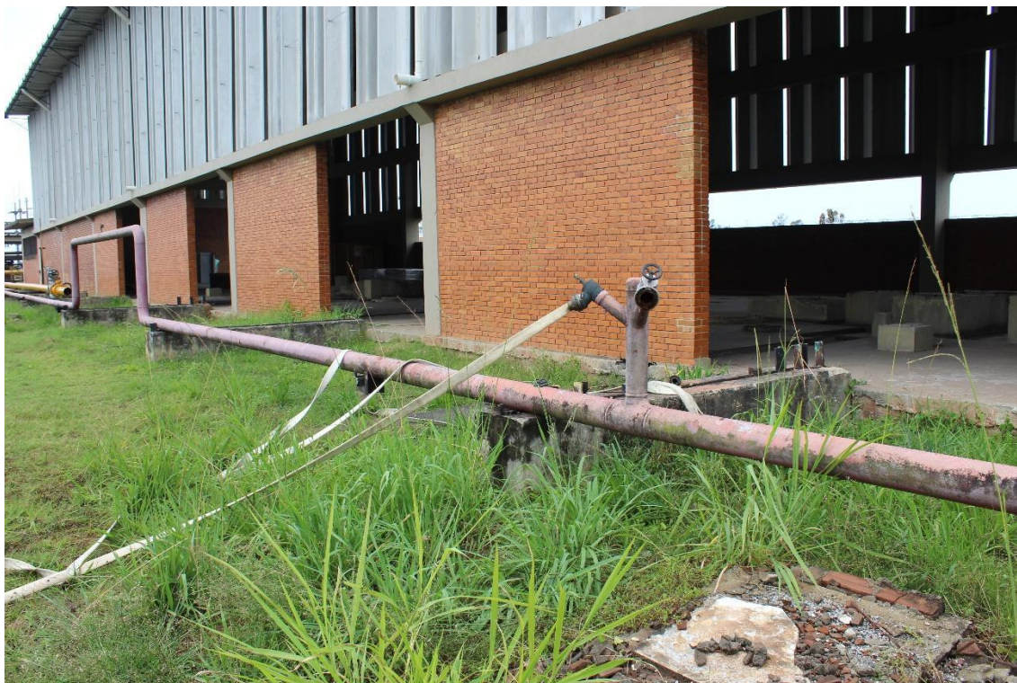
FOTO 9: Sistema de combate a incêndio utilizado.
