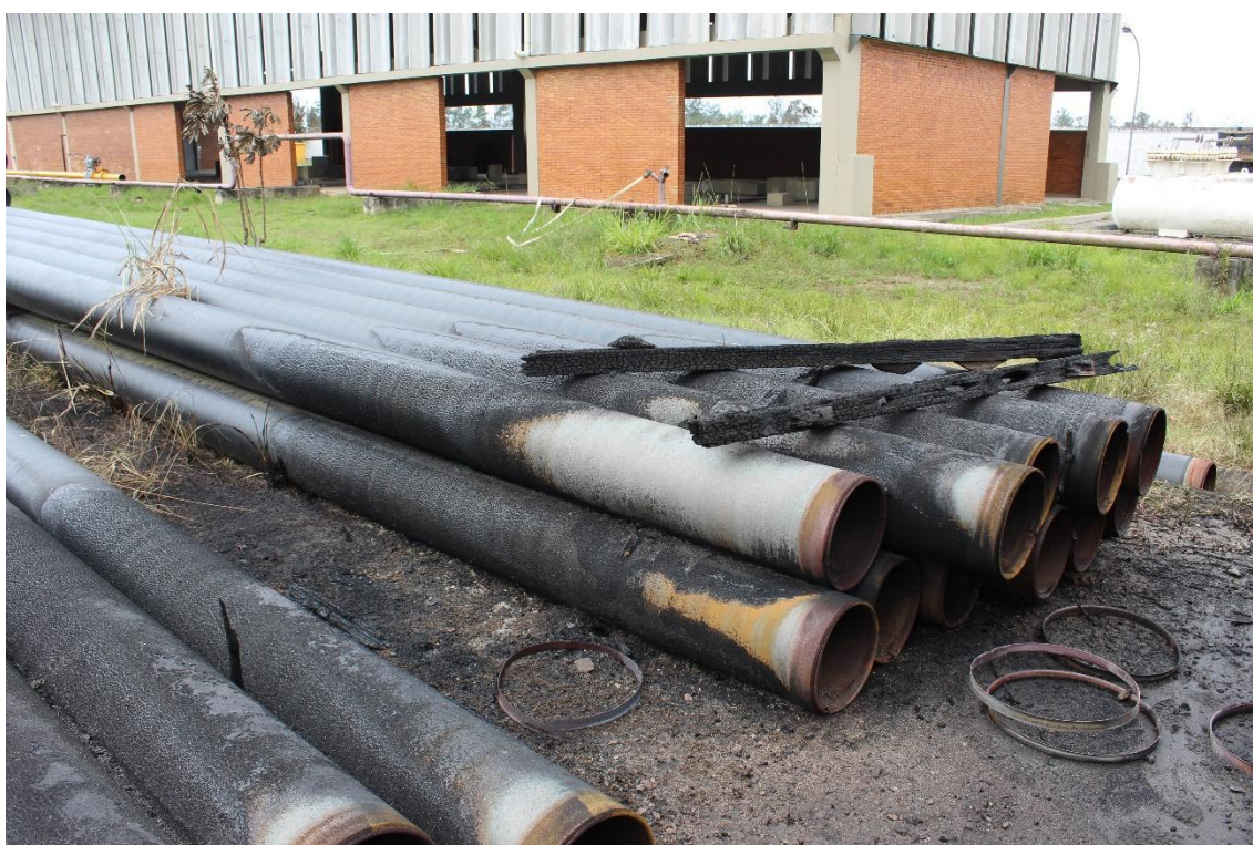
FOTO 8: Detalhe de parte da tubulação danificada.
