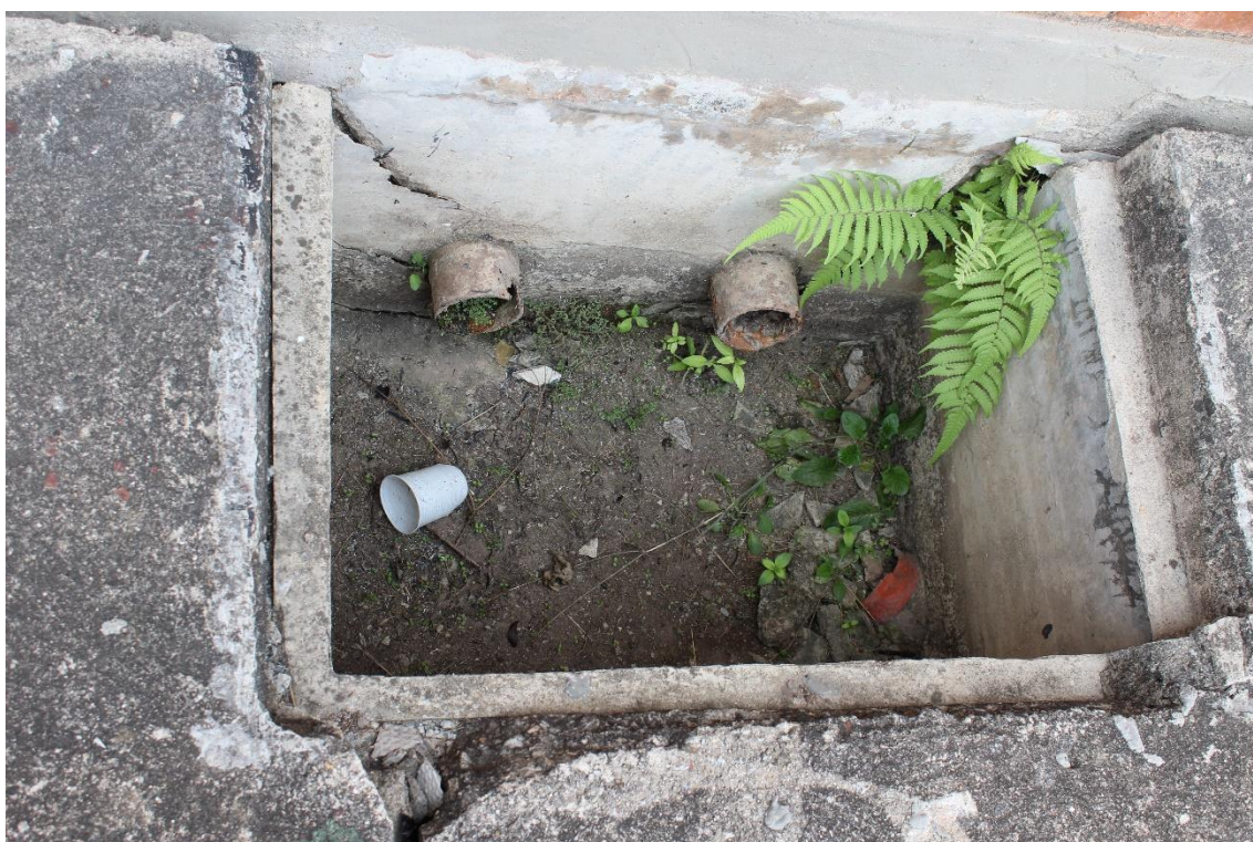
FOTO 12: Outra caixa de passagem de águas pluviais sem tampa.
