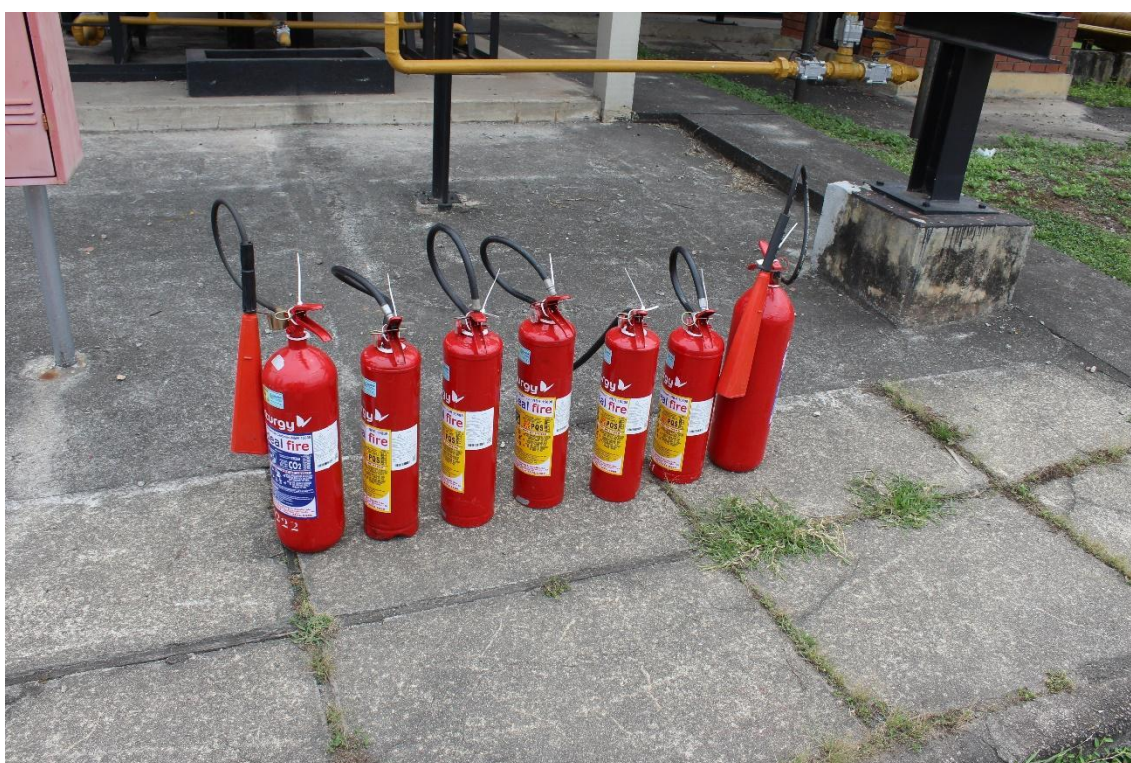
FOTO 10: Novos extintores de incêndio para substituição dos que foram utilizados.
