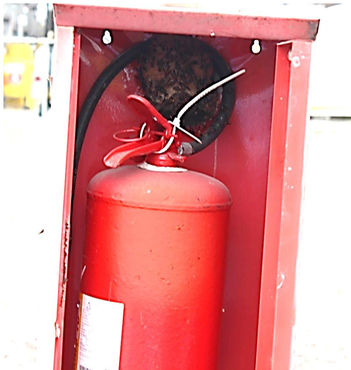
FOTO 24: Ninho de marimbondo no interior da caixa de proteção de extintor.
