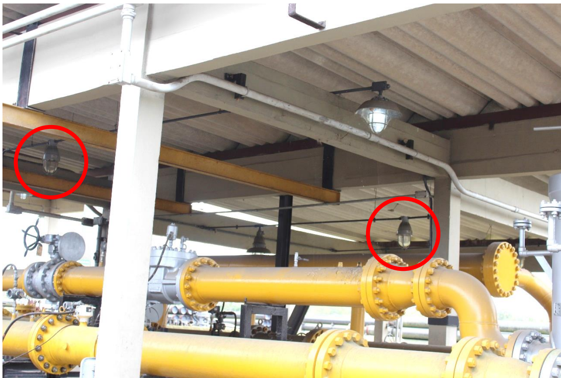
FOTO 23: Iluminação acesa durante o período diurno e com lâmpadas queimadas.
