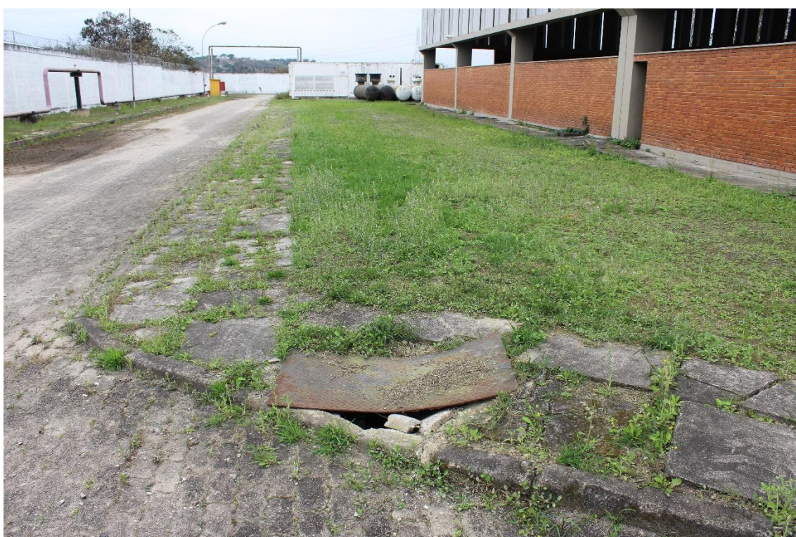
FOTO 16: Chapa de proteção danificada, oferecendo riscos aos transeuntes.
