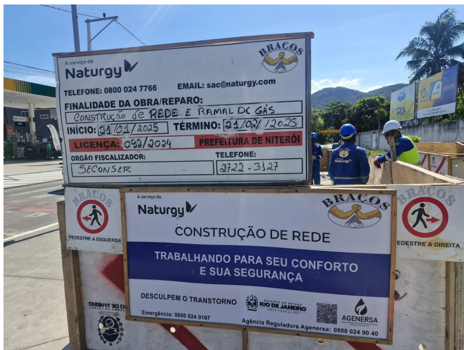
Foto 1: Placa de identificação.
