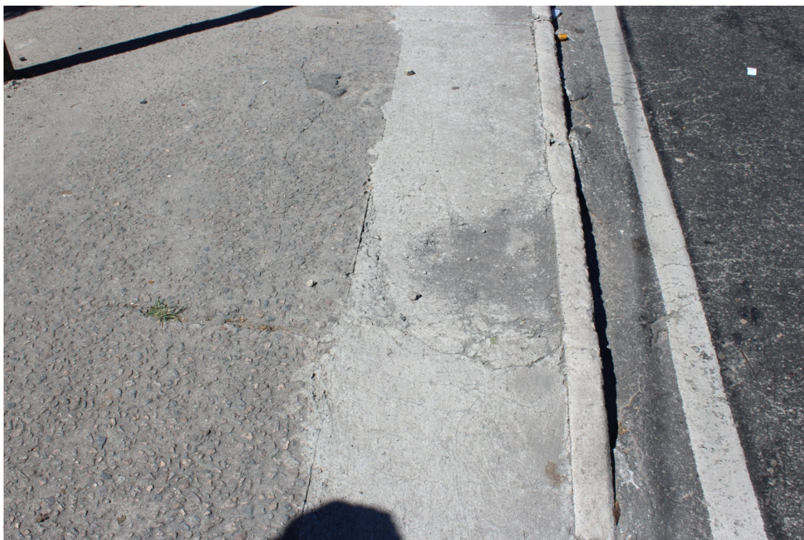
FOTO 7: Afundamento em recomposição de calçada.
