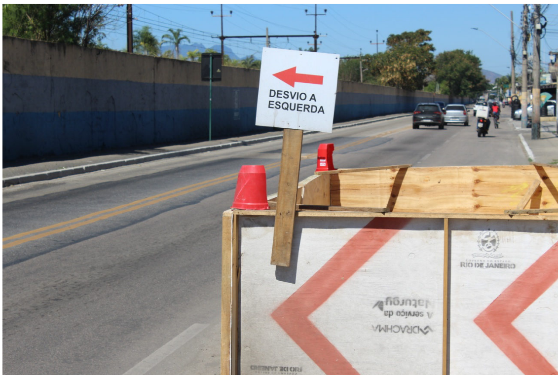
FOTO 11: Ausência de sinalização noturna.
