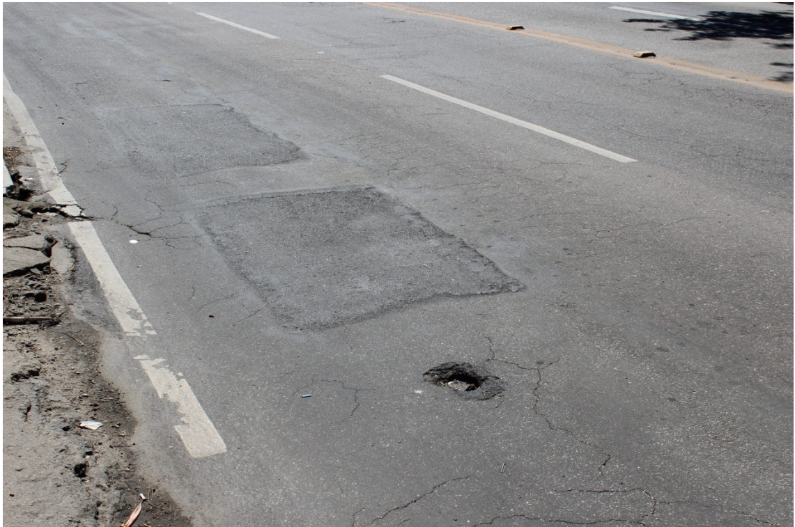
FOTO 13: Buraco em pista de rolamento devido a perda de material da recomposição asfáltica
