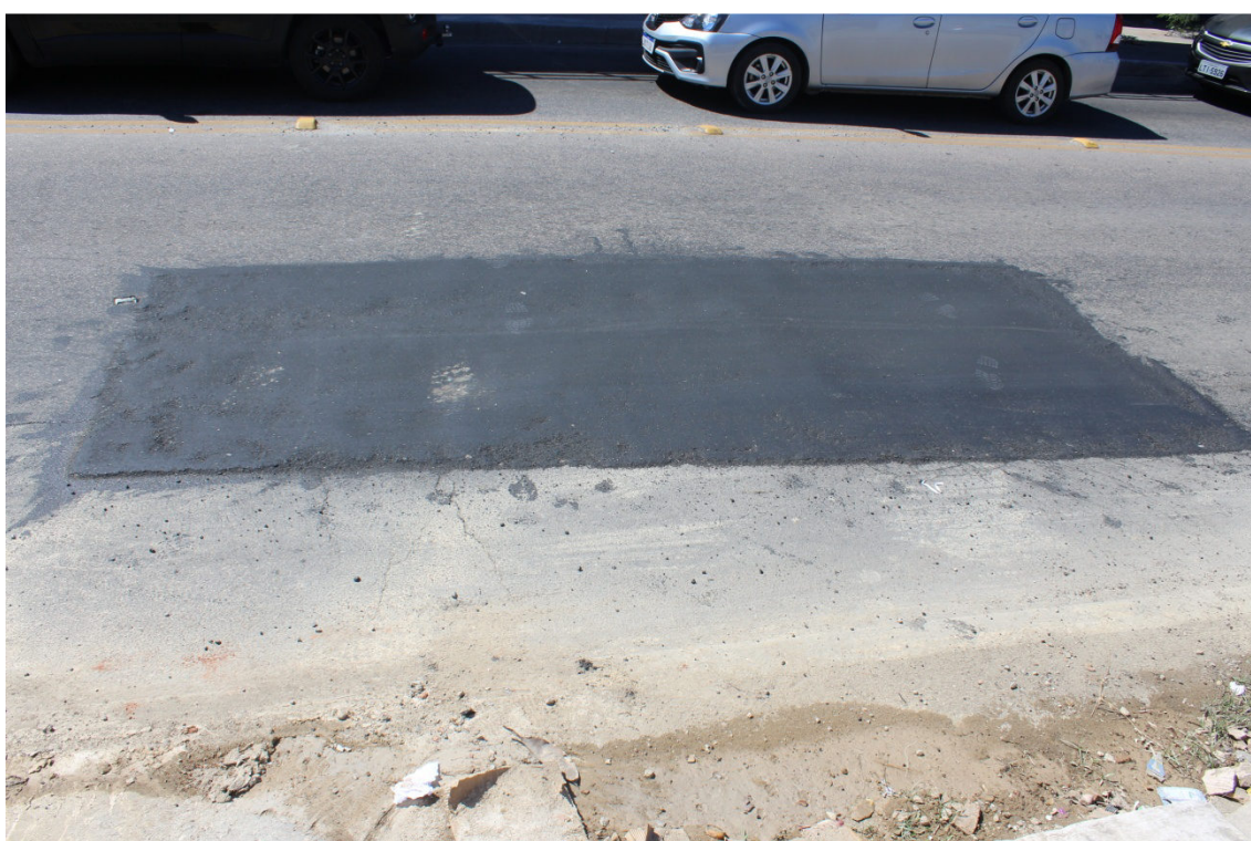
FOTO 8: Recomposição asfalta em elevado desnível em relação a pista de rolamento.
