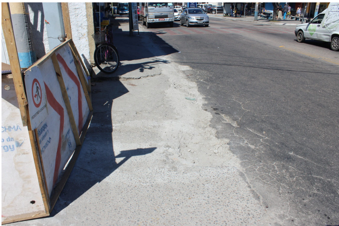
FOTO 3: Sinalização de pedestre posicionada de forma indevida não promovendo a sinalização adequada ao sentido do fluxo de pessoas
