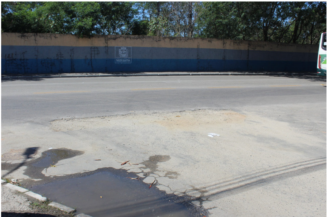
FOTO 14: Intervenção da CEDAE para reparo em tubulação de água avariada pela Concessionária CEG – foi solicitado que a CEG proceda com a recomposição da pista de rolamento.
