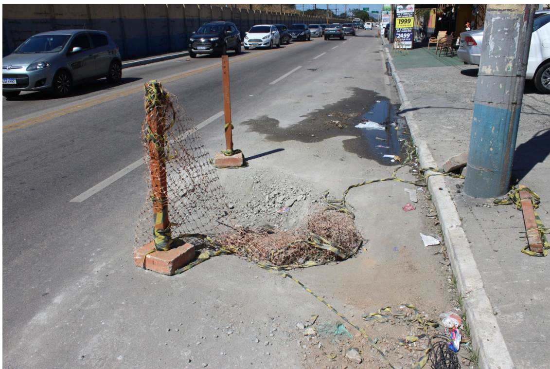
FOTO 9: Intervenção da CEDAE para reparo de vazamento em tubulação de água sem responsabilidade da Concessionária CEG, ficando o reparo a cargo da CEDAE.
