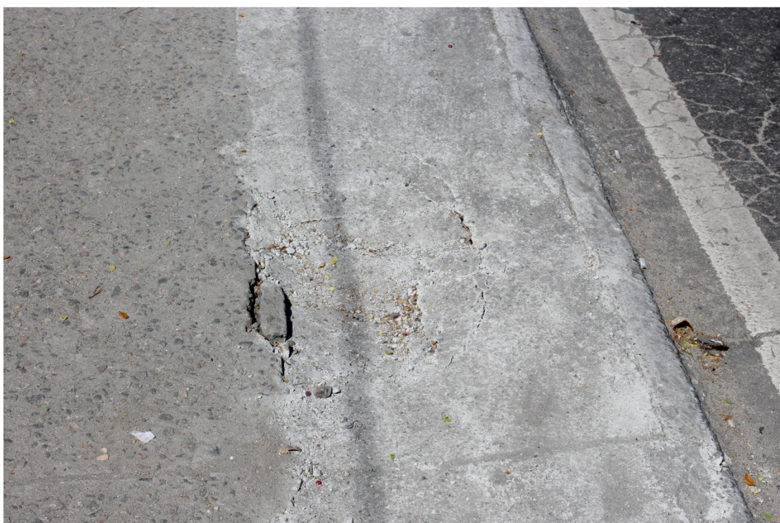
FOTO 6: Afundamento em recomposição de calçada.
