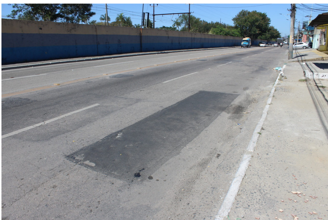
FOTO 12: Recomposição asfáltica apresentando perda de material.
