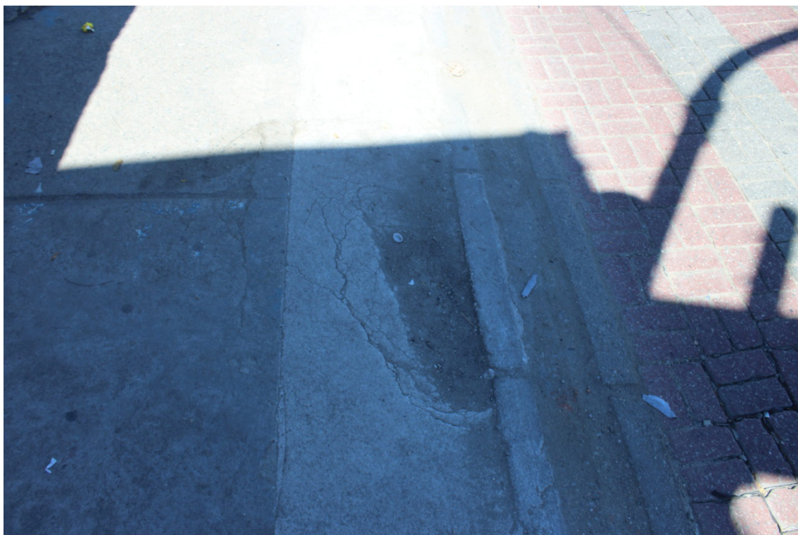
FOTO 5: Afundamento em recomposição de calçada.
