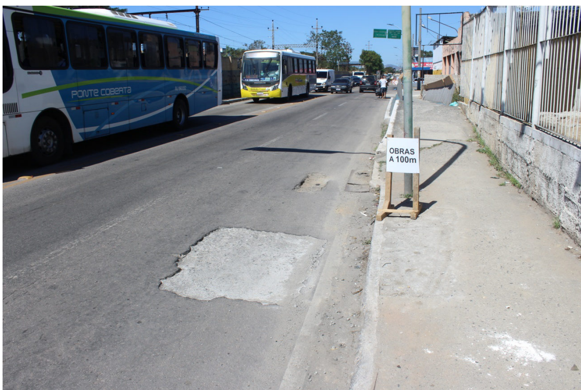
FOTO 10: Recomposição provisória em desnível com a pista de rolamento.
