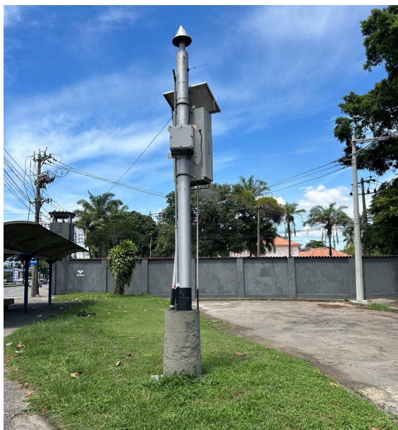
Foto 4: Caixa de telemetria.
