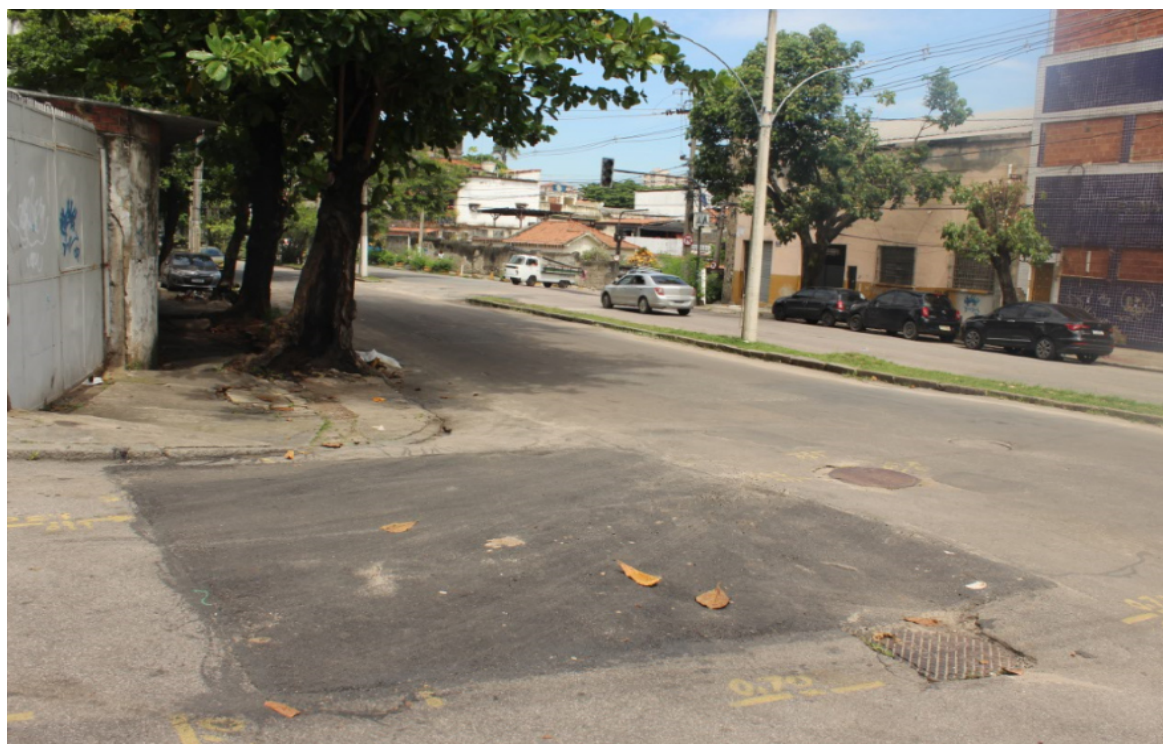
Foto 2: Recomposição com desnível e perda de material
