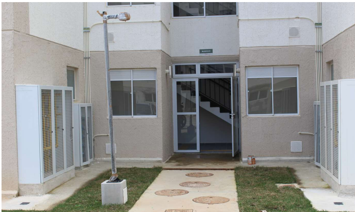
Foto 3 : instalação para regulador e medidores
