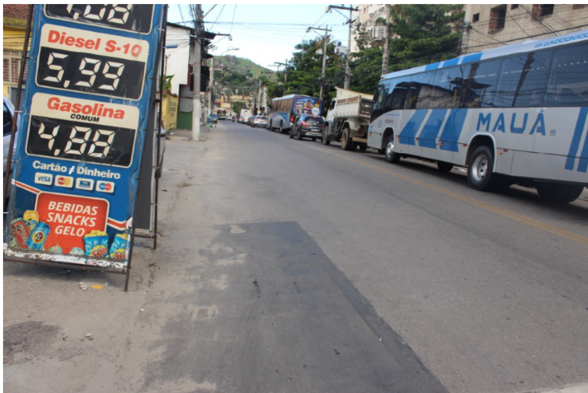
Foto 8: Recomposição provisória não sinalizada (antes)
