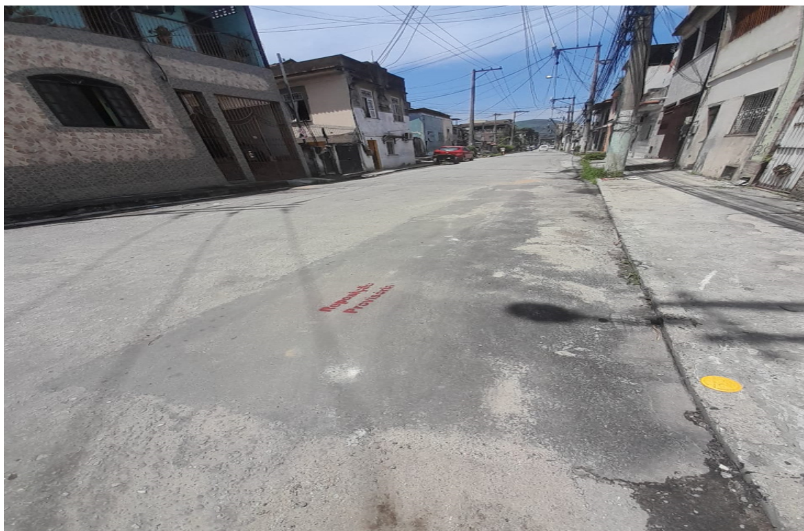
Foto 10: Recomposição provisória não sinalizada (depois)
