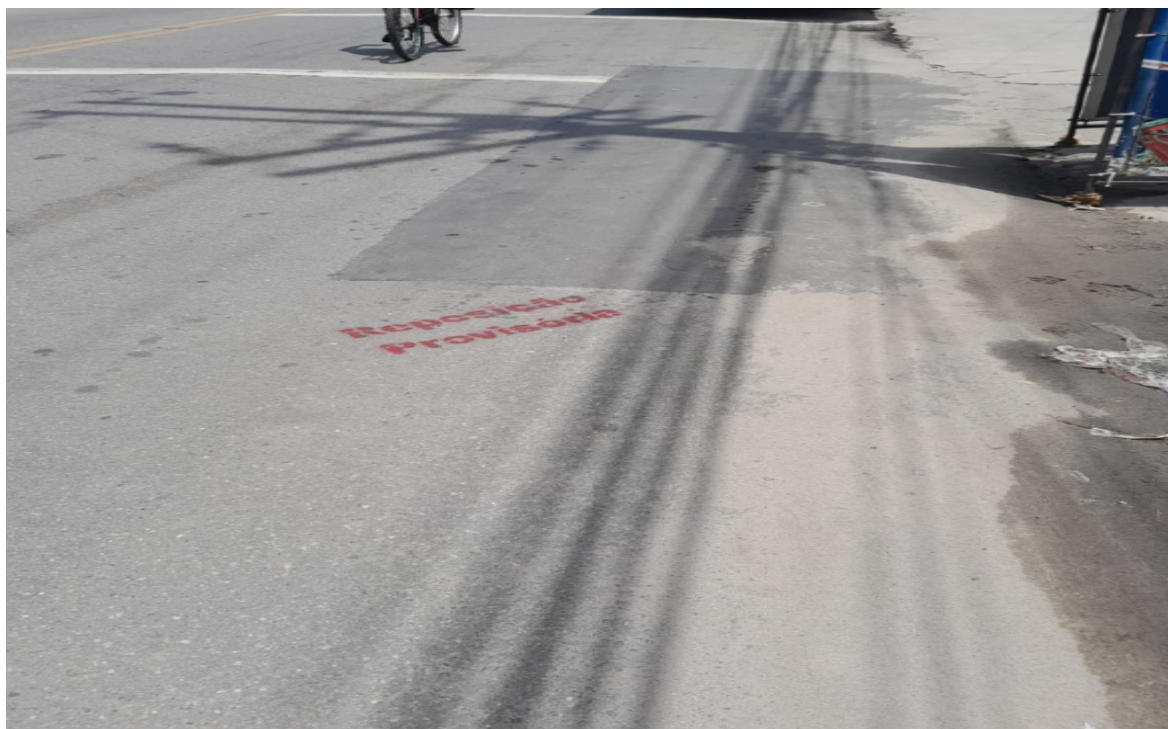
Foto 9: Recomposição provisória não sinalizada (depois)
