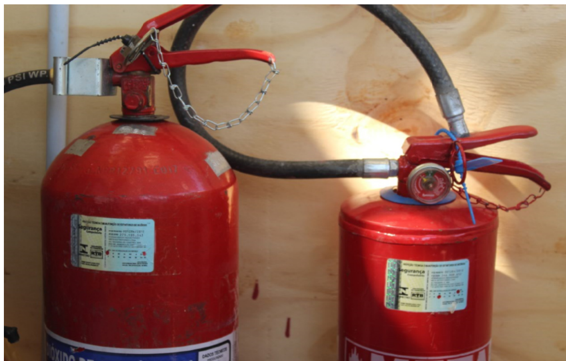
Foto 2: Extintores de incêndio
