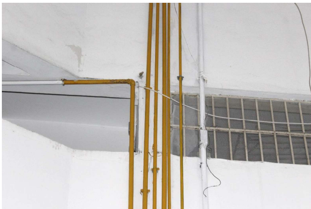
FOTO 16: Instalações de natureza elétrica em meio a tubulação de Gás Natural.
