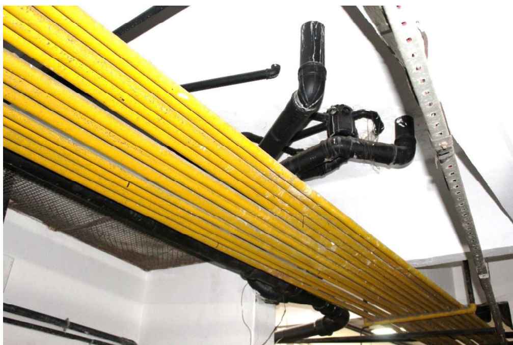
FOTO 8: Tubulação de esgoto do prédio acima da tubulação de Gás Natural.
