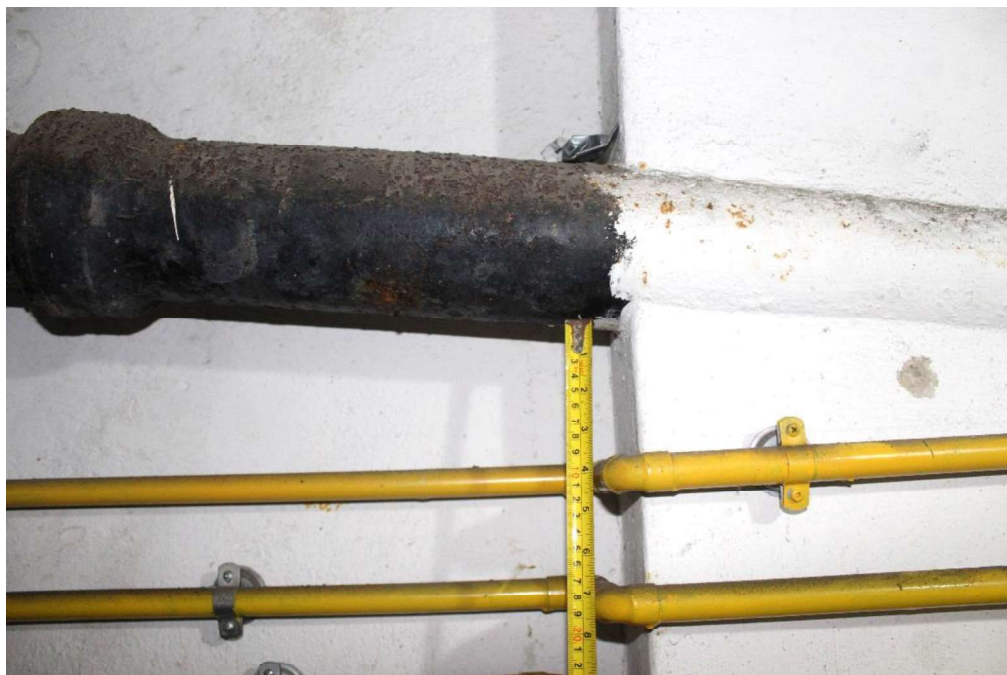
FOTO 3: Tubulação de esgoto do prédio acima da tubulação de Gás Natural e a uma distância menor que 20 centímetros.
