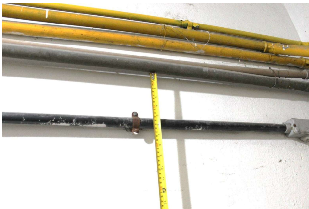
FOTO 4: Instalação elétrica a menos de 20 centímetros - PI.
