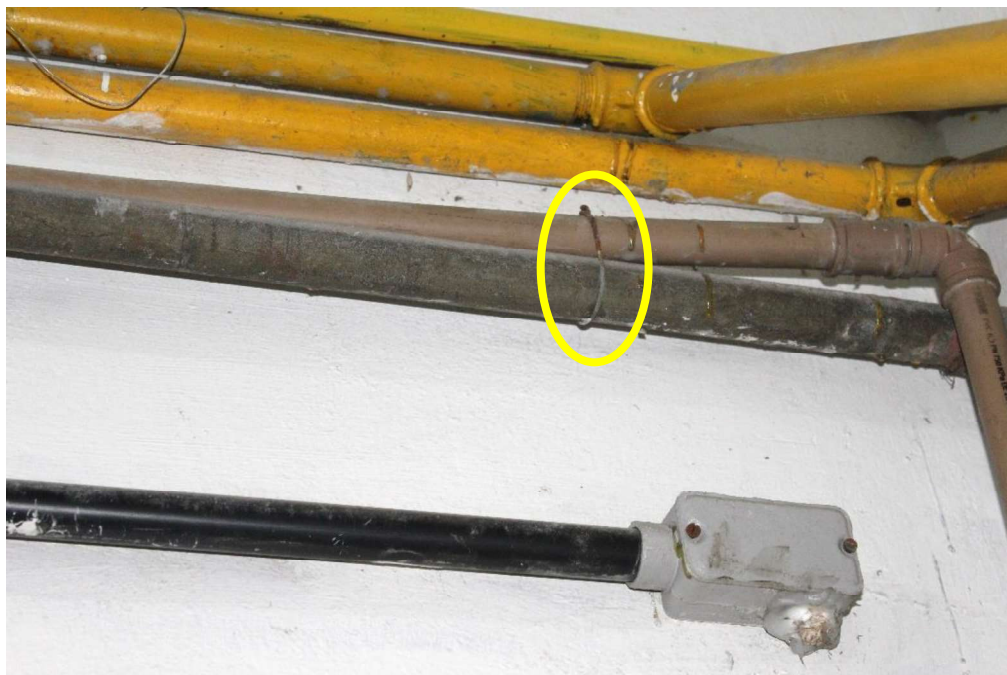
FOTO 5: Instalações de outra natureza amarrada junto com tubulação de Gás Natural – PI.
