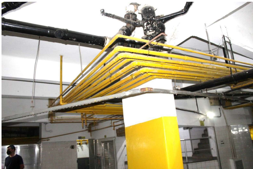
FOTO 11: Tubulação de esgoto do prédio, apresentando vazamento, acima da tubulação de Gás Natural.
