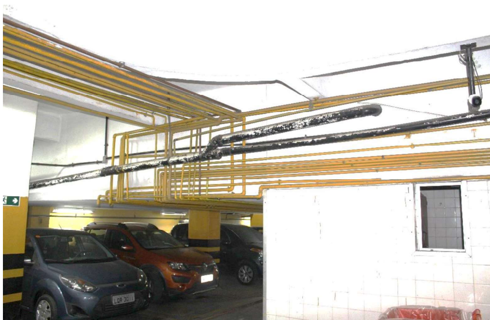
FOTO 10: Tubulação de esgoto do prédio passando junto com a tubulação de Gás de Natural.
