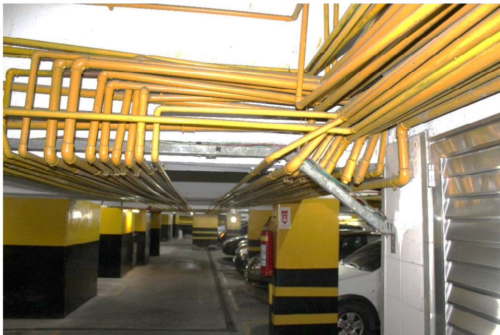
FOTO 7: Eletrocalha passando entre as instalações de Gás Natural.
