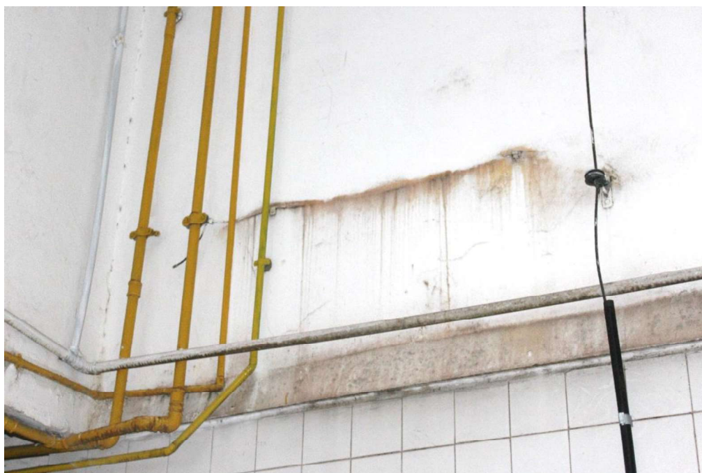
FOTO 14: Instalações de outra natureza em meio a tubulação de Gás Natural e cabo de equipotencialização do para raio com a tubulação de Gás Natural rompido.
