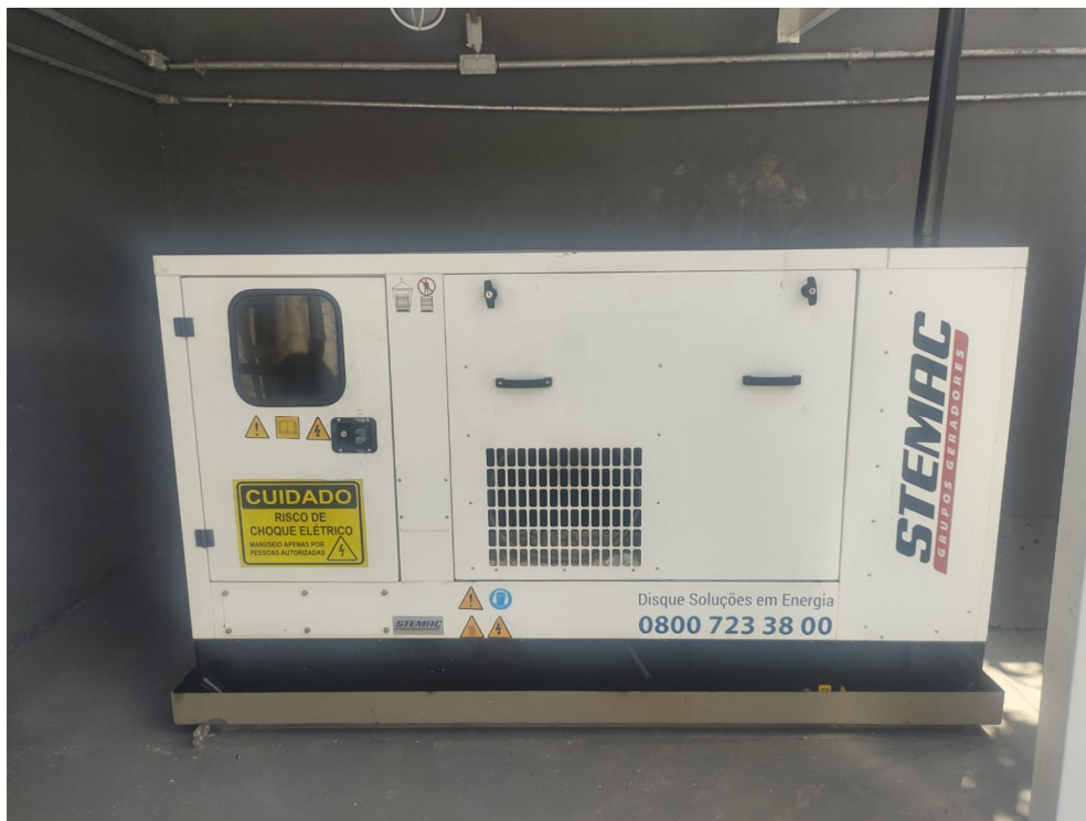
Foto 8: Gerador a diesel com sinalização de risco.
