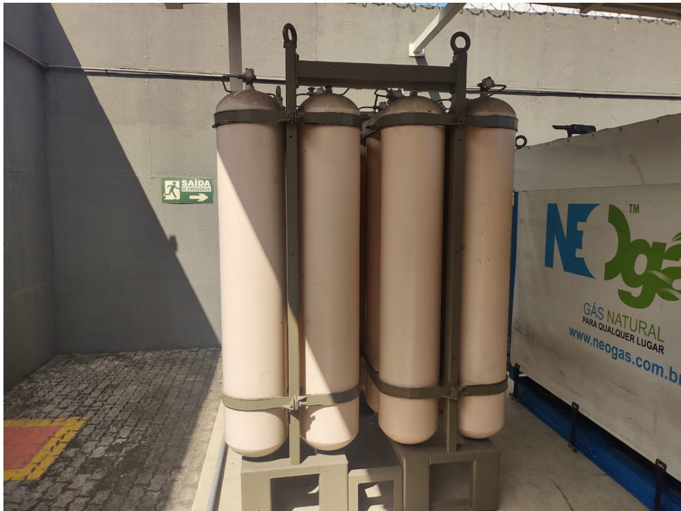
Foto 9: Cilindros de estocagem.
