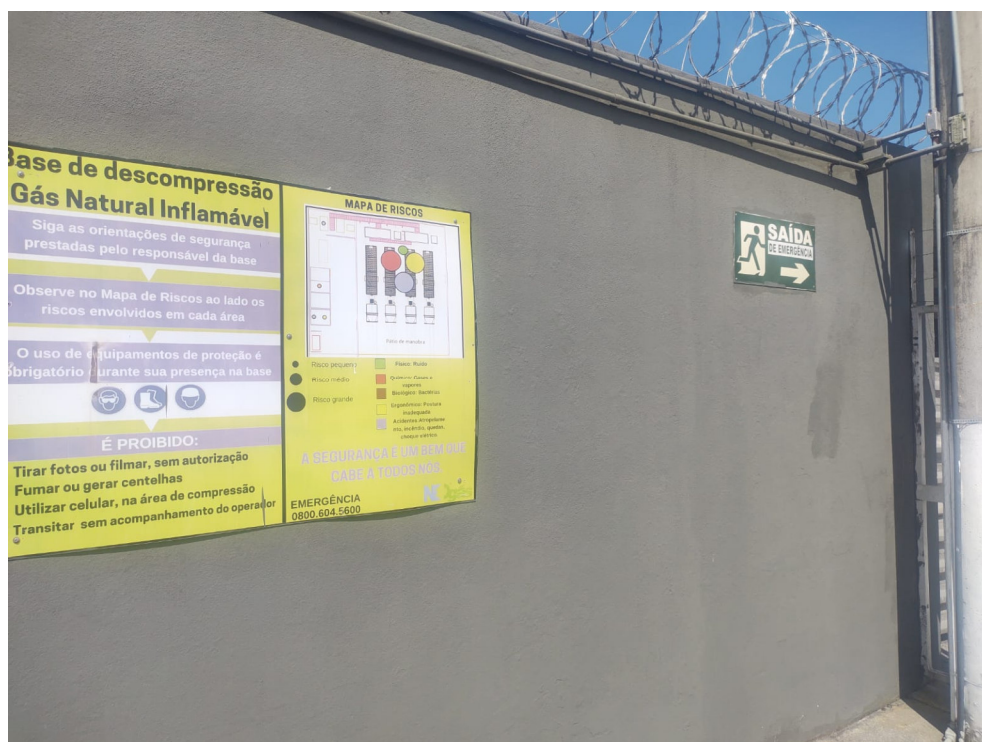
Foto 12: Mapa de riscos da estação de descompressão e sinalização de rota de fuga.
