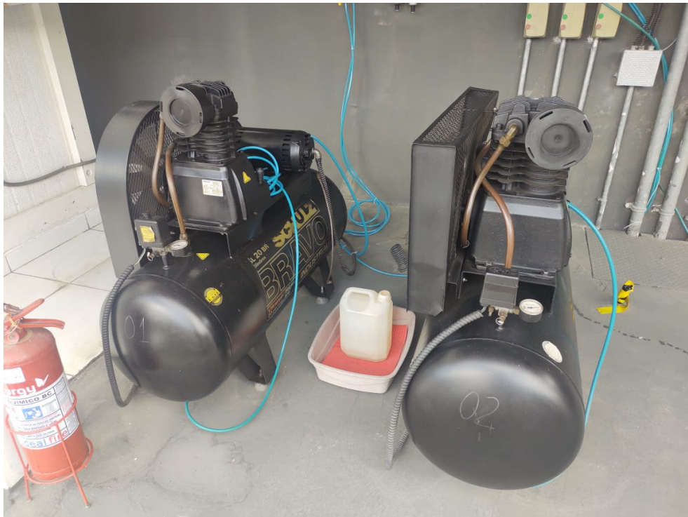
Foto 7: Estação de ar comprimido com dois compressores.
