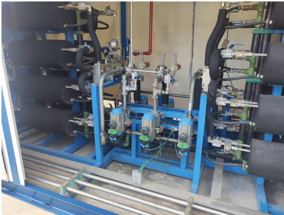
Foto 3: Visão geral da RCU com destaque para os sistemas de aquecimento (lados direito e esquerdo) e para a segunda válvula de redução (centro)
