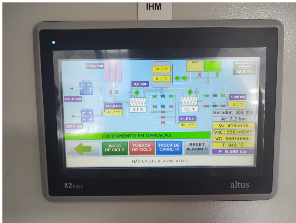
Foto 10: Painel de controle da sala de comando da Neogás.
