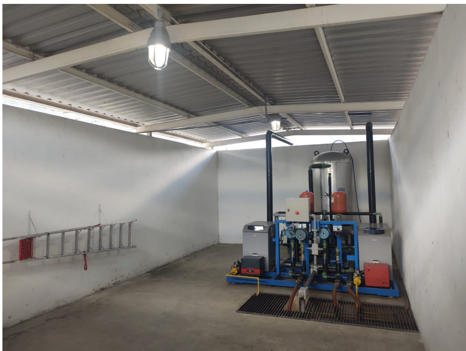
Foto 6: Sistema de aquecimento de gás e reservatório de água.
