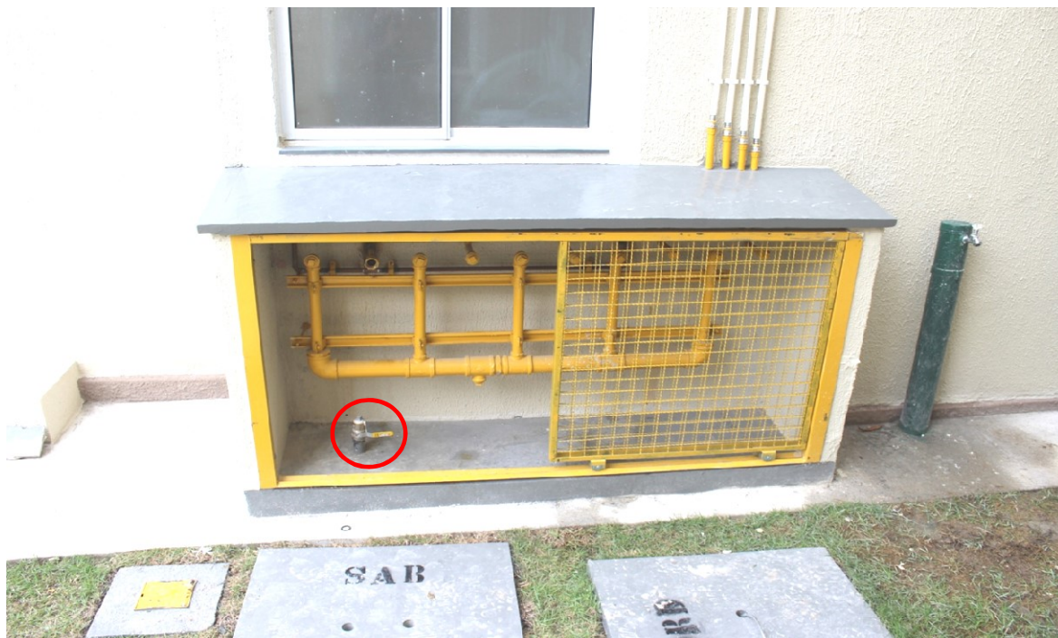
Foto 3 : Ponto de entrega de gás para alimentação dos medidores. Em destaque a saída do ramal para alimentar a flauta onde serão instalados os medidores.
