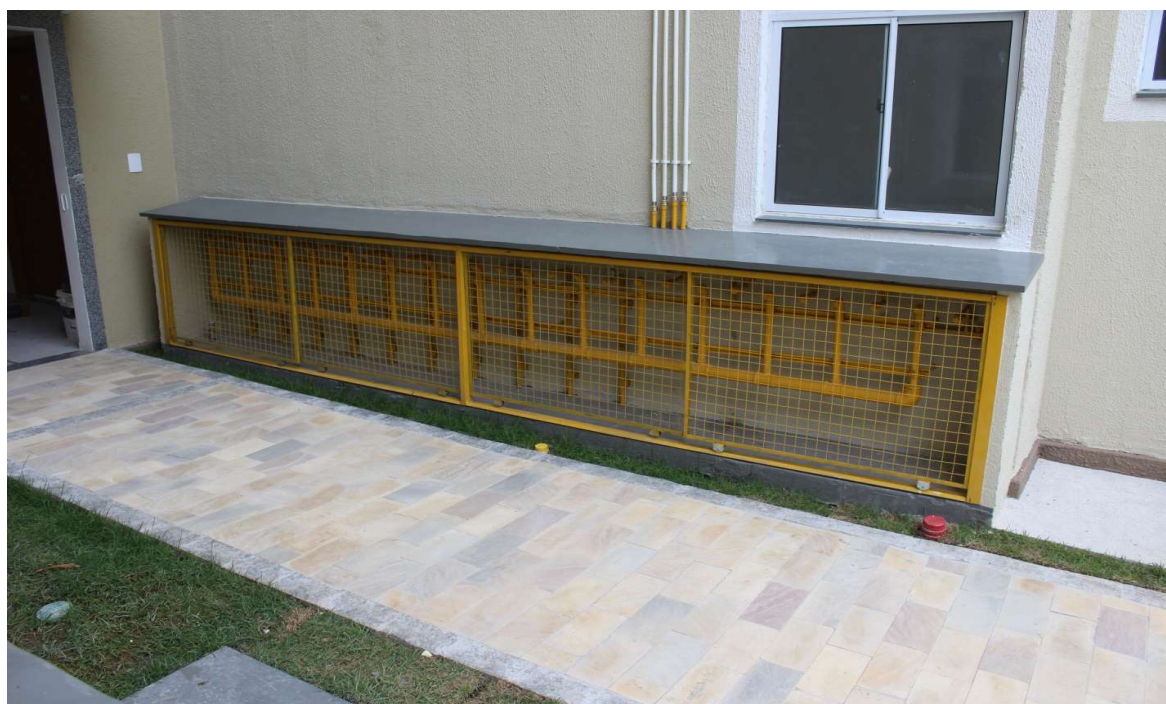
Foto 2 : Instalações internas preparadas para receber os reguladores e os medidores
