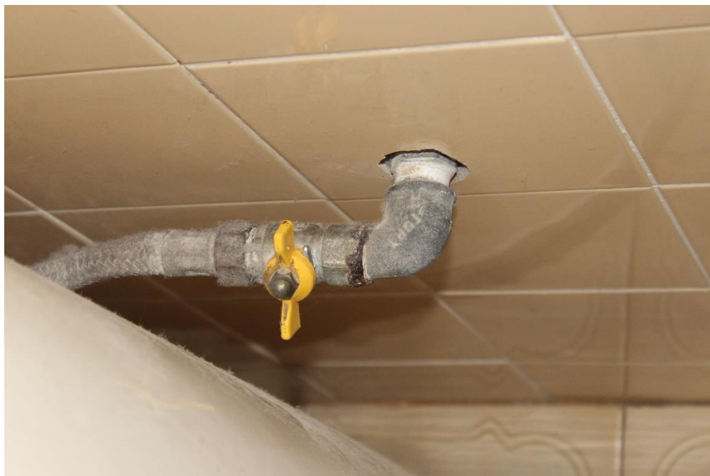
FOTO 3: Válvula do ponto de entrega do boiler em posição de fechada.
