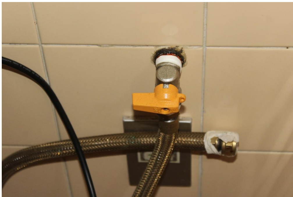
FOTO 2: Válvula do ponto de entrega do fogão em posição de fechada.
