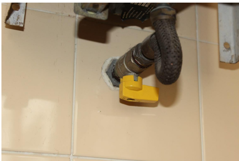
FOTO 4: Válvula do ponto de entrega do aquecedor em posição de fechada.
