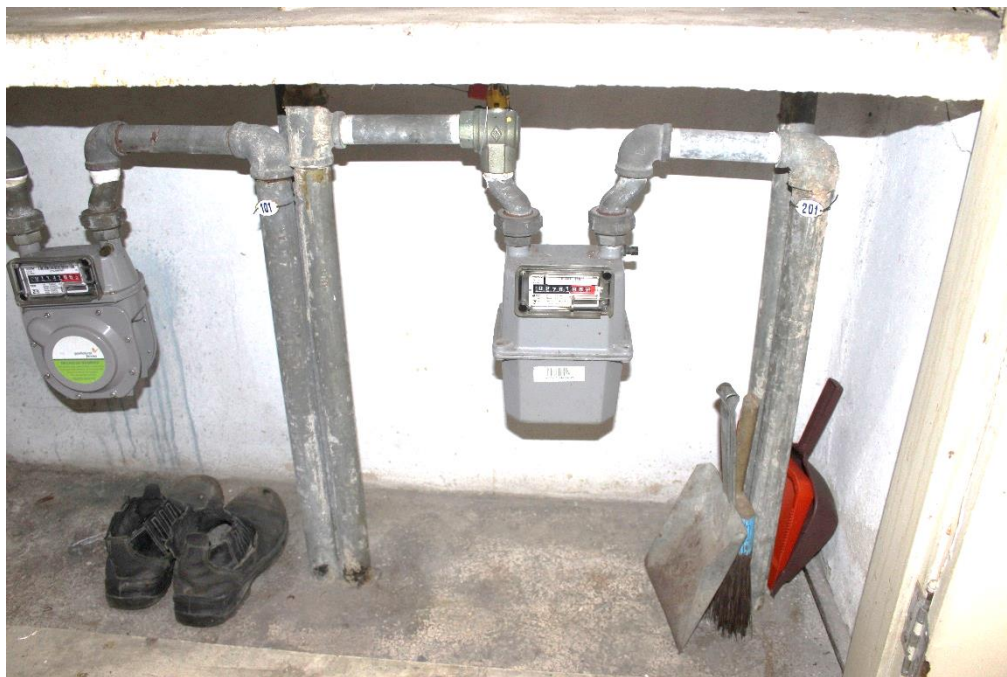
FOTO 1: Medidor do cliente com lacre
