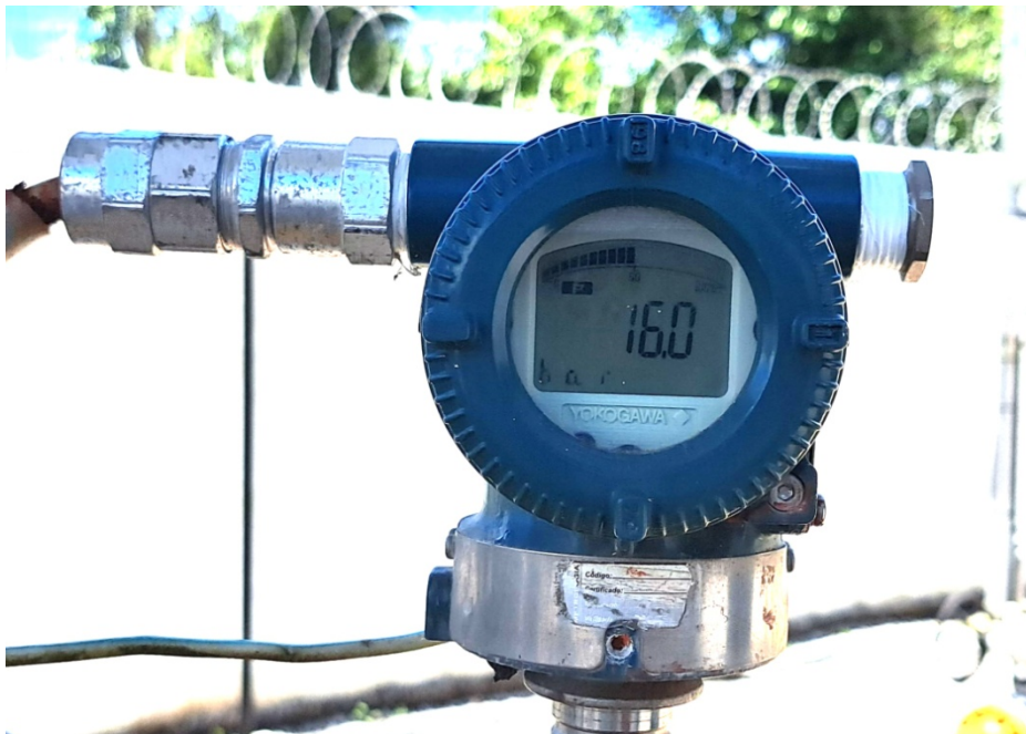
Foto 6: Medição pressão de saída
