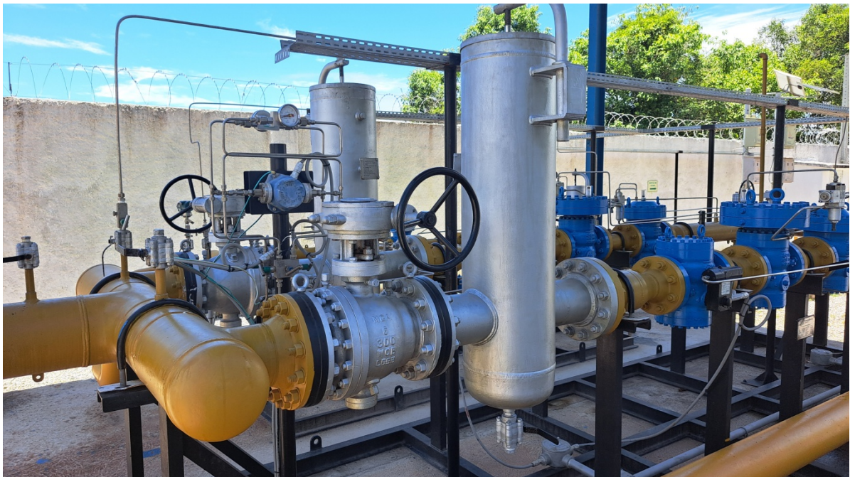
Foto 4: Detalhe duplicação da linha. Filtros (cor prata) e reguladores (cor azul)
