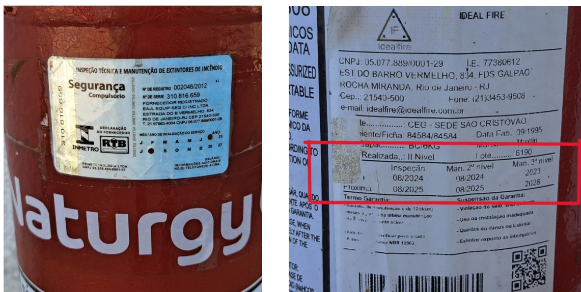
Foto 9: Extintor 2 - Pó Químico – Validade dos testes
