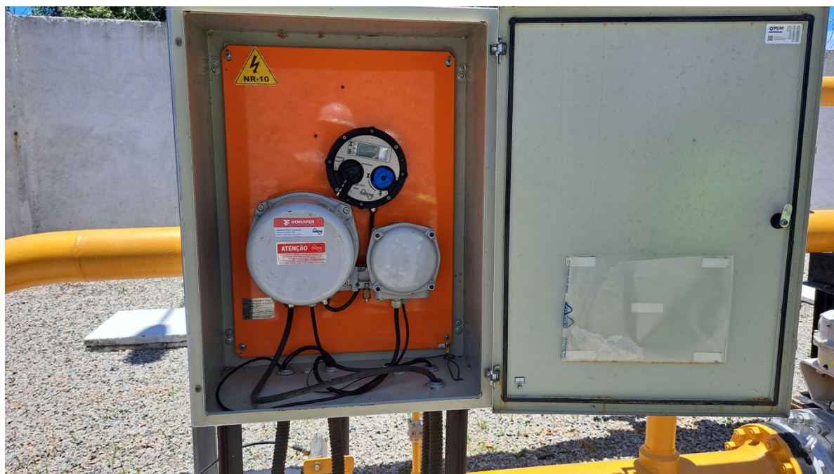
Foto 10: Quadro do Telecomando da Regulação da Estação
