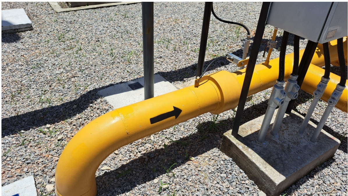
Foto 2: Detalhe linha de entrada 8 pol - 42bar
