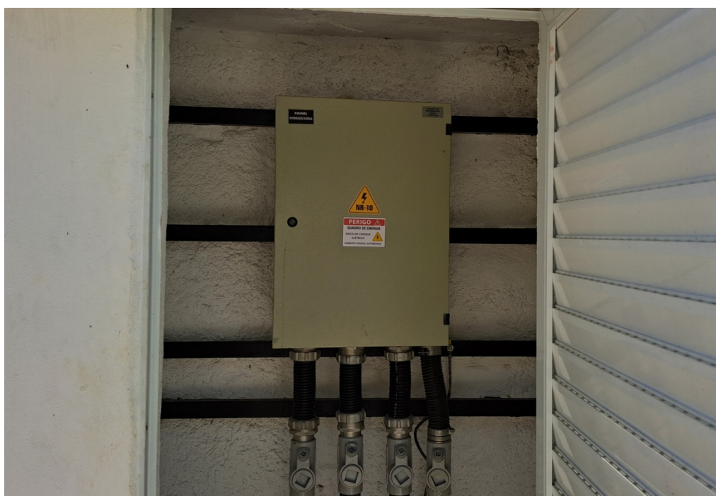
Foto 16: QDF - Quadro de Distribuição Força
