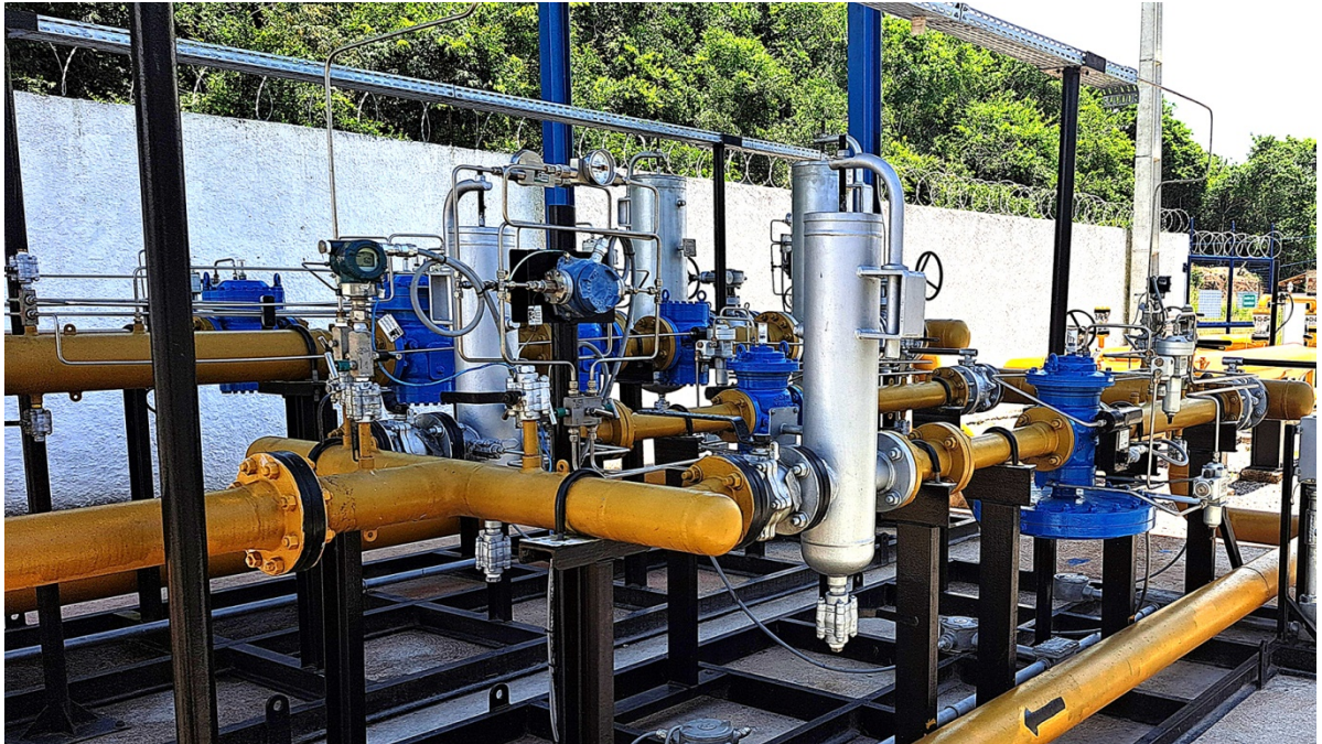
Foto 13: Detalhe do Skid Mounted de Filtragem e Regulação de Pressão
