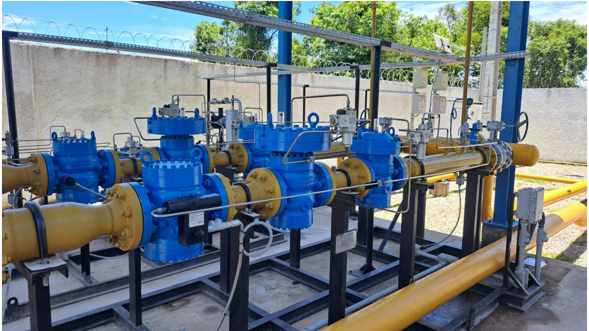
Foto 5: Detalhe dos Reguladores de pressão telecomandados
