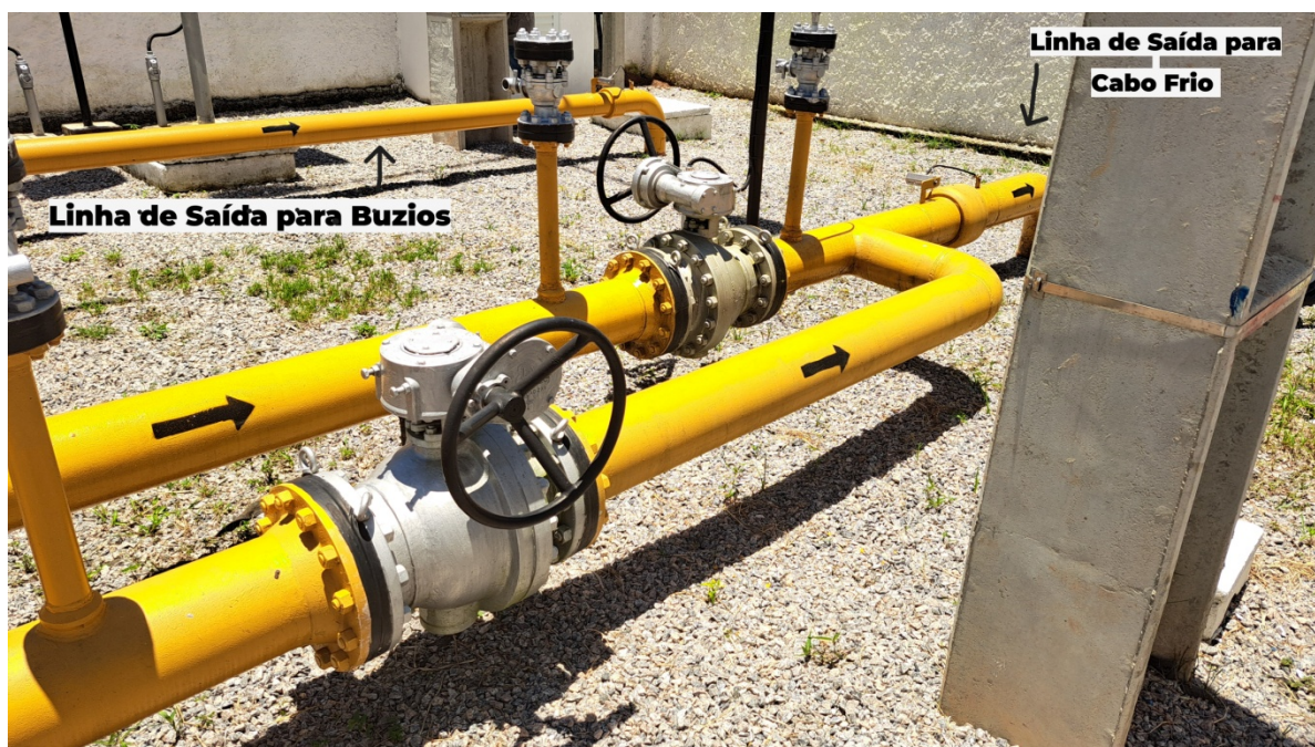
Foto 7: Detalhe linha de saída da estação em direção a XV-05 - Cabo frio
