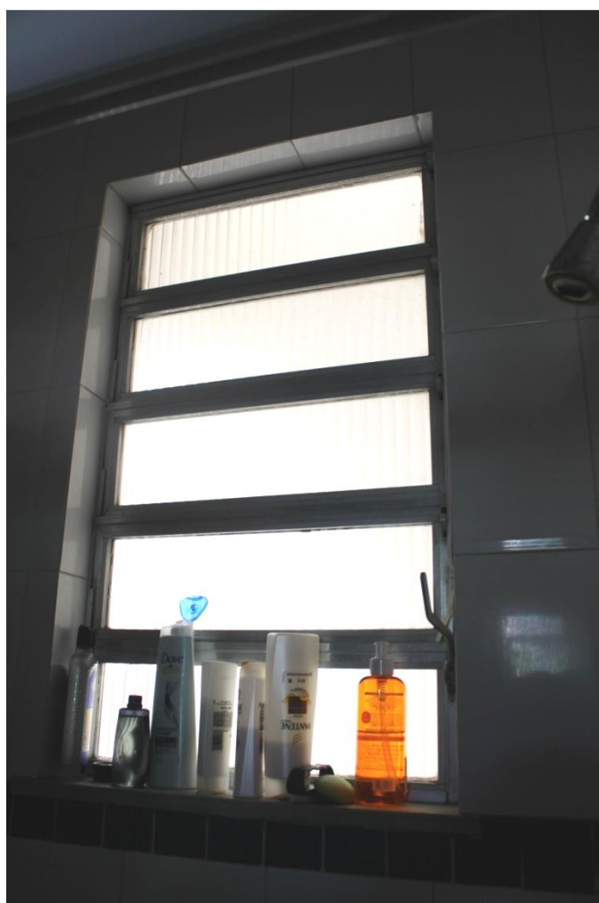
FOTO 8: Vista do basculante do banheiro sem limitador podendo ser totalmente fechado, não garantindo a constante ventilação superior.
