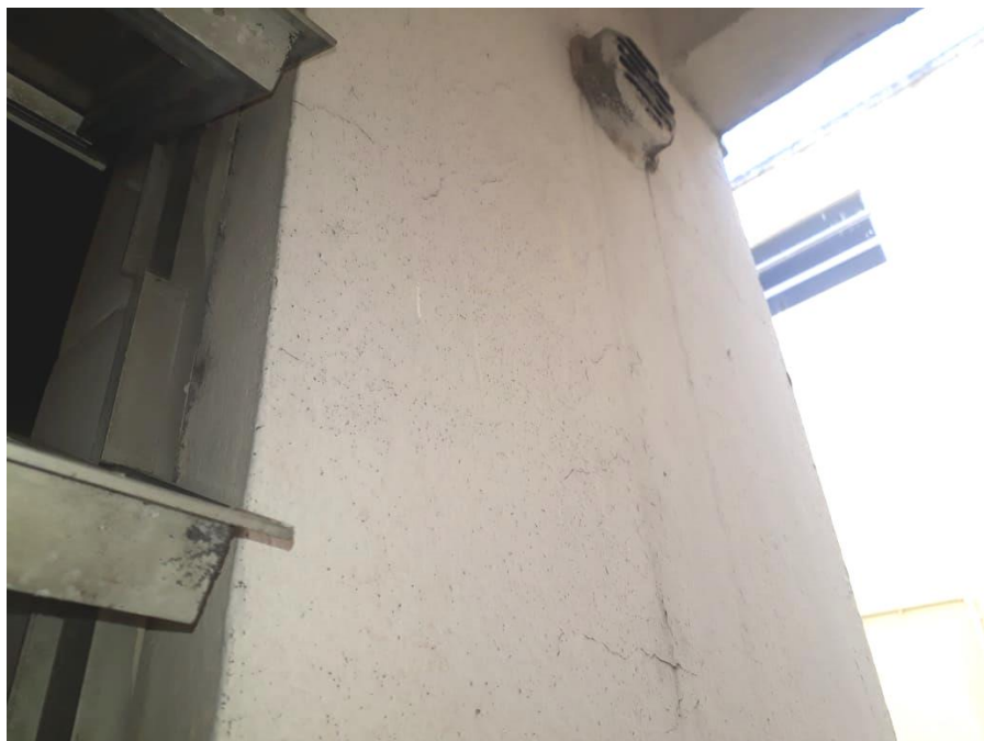
FOTO 7: Vista da saída da chaminé para o prisma de ventilação – Foto cedida pela Concessionária durante a visita.
