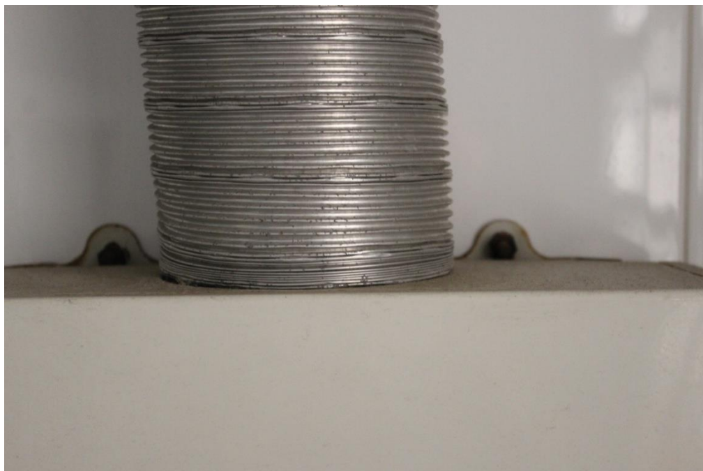
FOTO 5: Vista da conexão da chaminé com a gola do defletor do aquecedor sem sistema de fixação.
