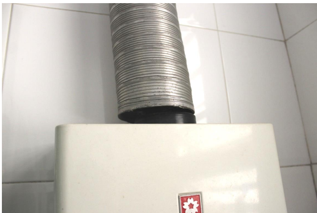
FOTO 6: Vista do duto da chaminé com diâmetro maior que o diâmetro da gola do defletor do aquecedor.
