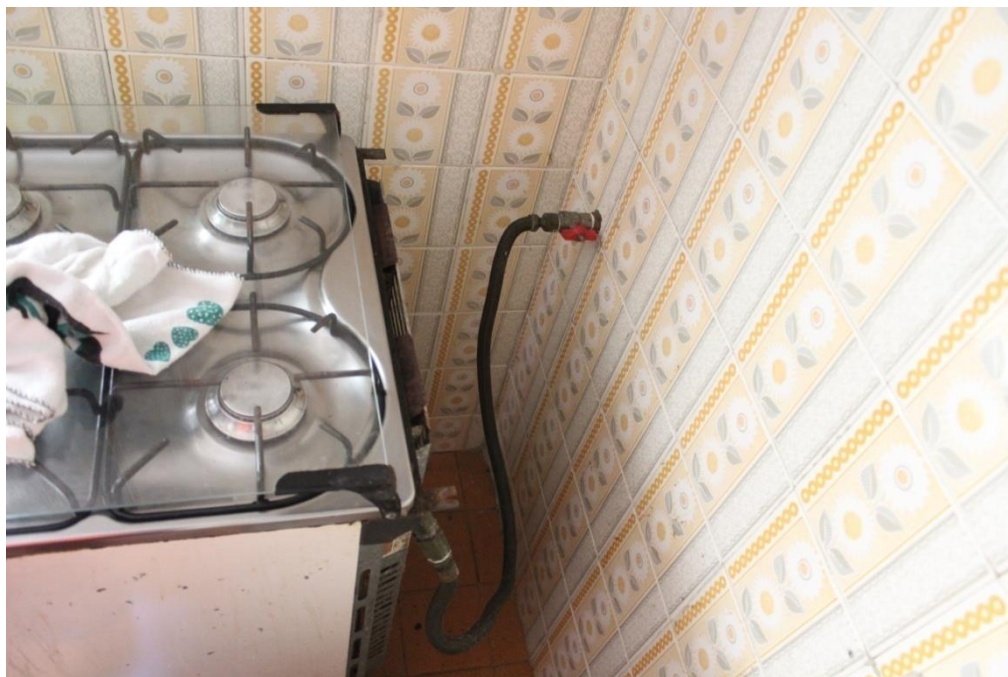
FOTO 11: Detalhe do registro do fogão na cor vermelha.
