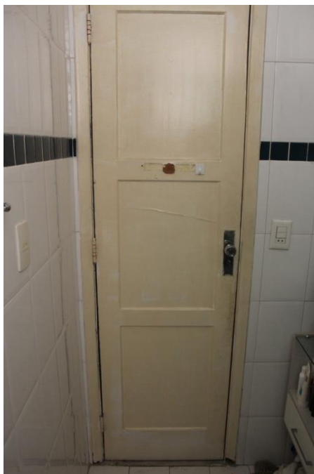
FOTO 9: Vista da porta do banheiro sem sistema de ventilação inferior.
