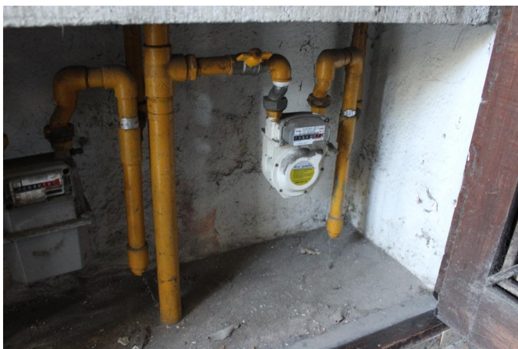
FOTO 12: Detalhe do aquecedor do apartamento 601.
