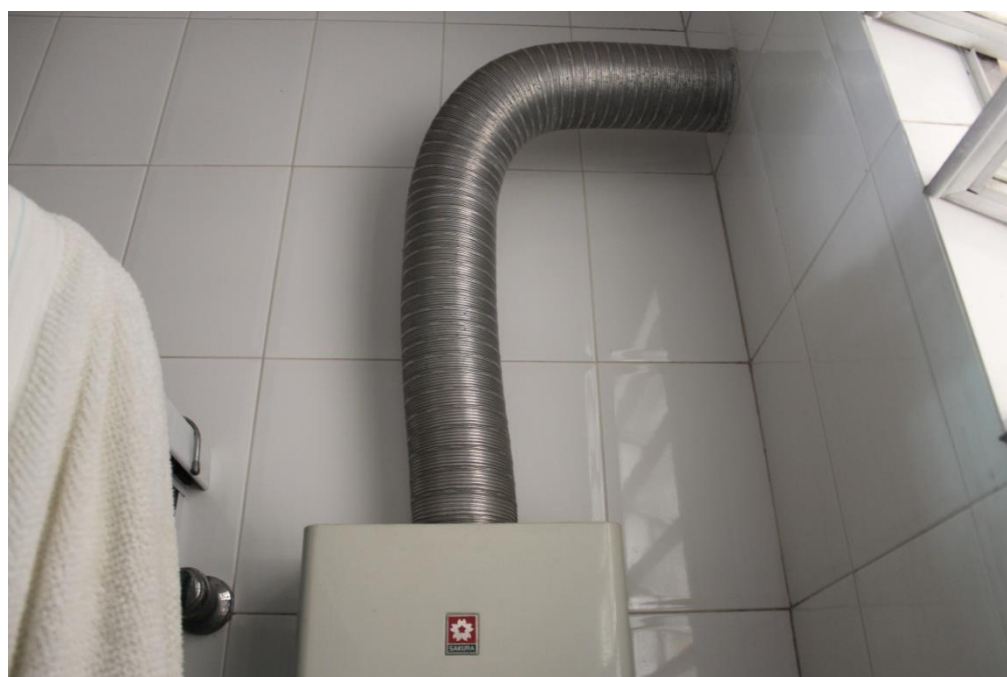
FOTO 4: Sistema de exaustão do aquecedor.
