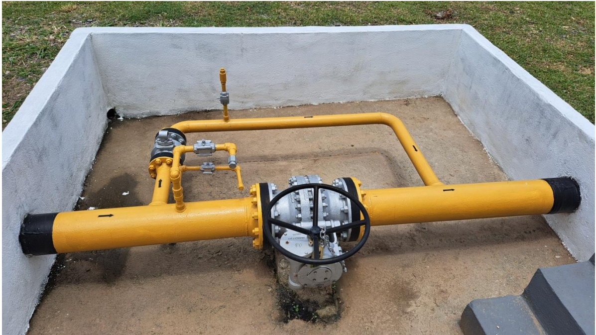
Foto 5: Válvula de bloqueio XV-05
