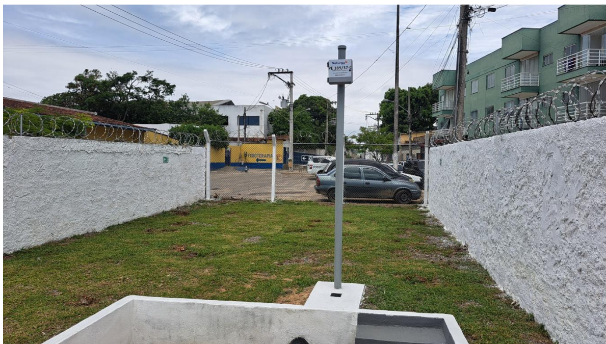
Foto 3: Detalhe proteção catódica
