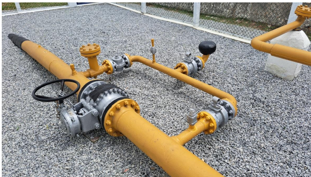
Foto 4 - Detalhe válvula de bloqueio XV-06 na área 1
