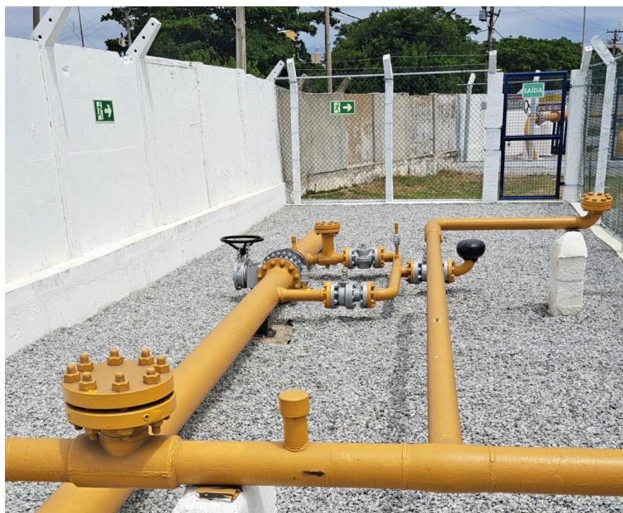
Foto 3: Válvula de bloqueio XV-06 na área 1
