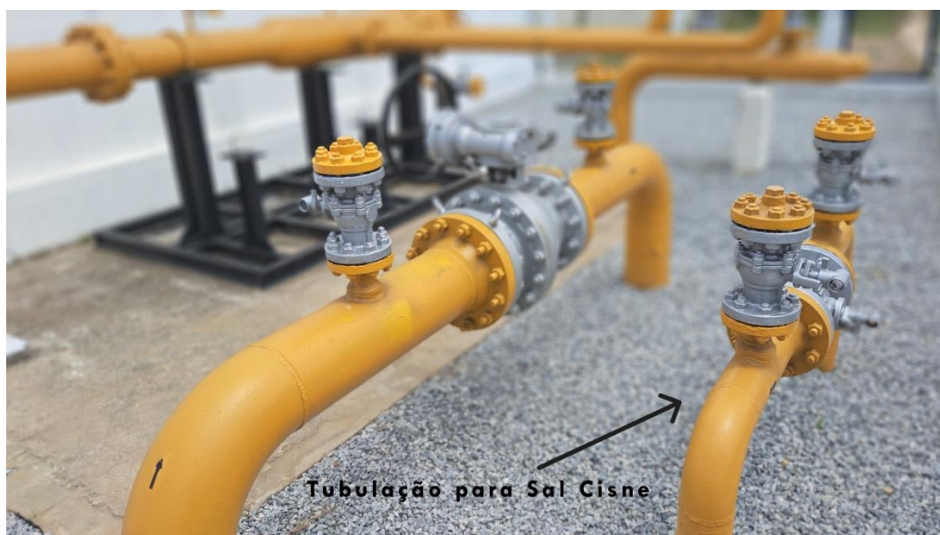
Foto 7: Detalhe tubulação 4 pol para Sal Cisne
