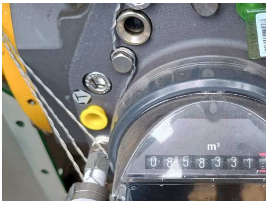
Foto 1: medidor de gás de entrada do posto Aero.
