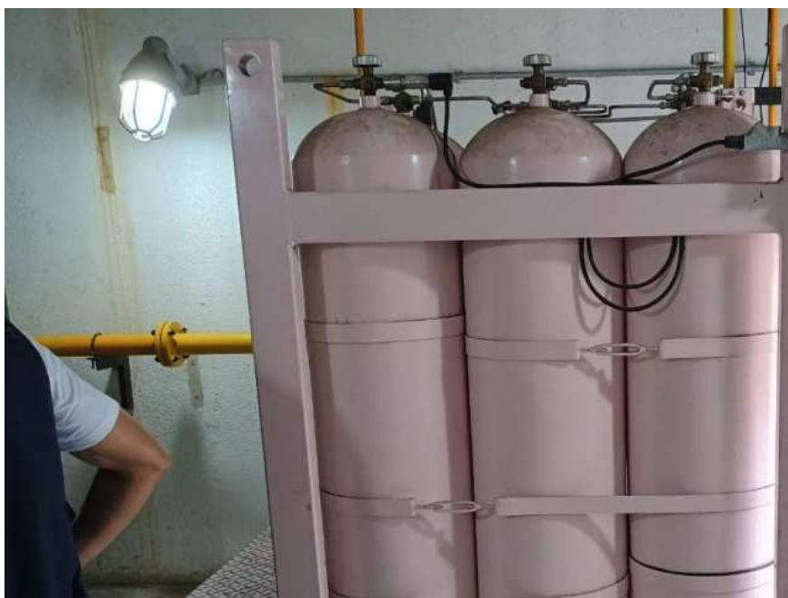
Foto 4: tanques de armazenamento do posto Aero.
