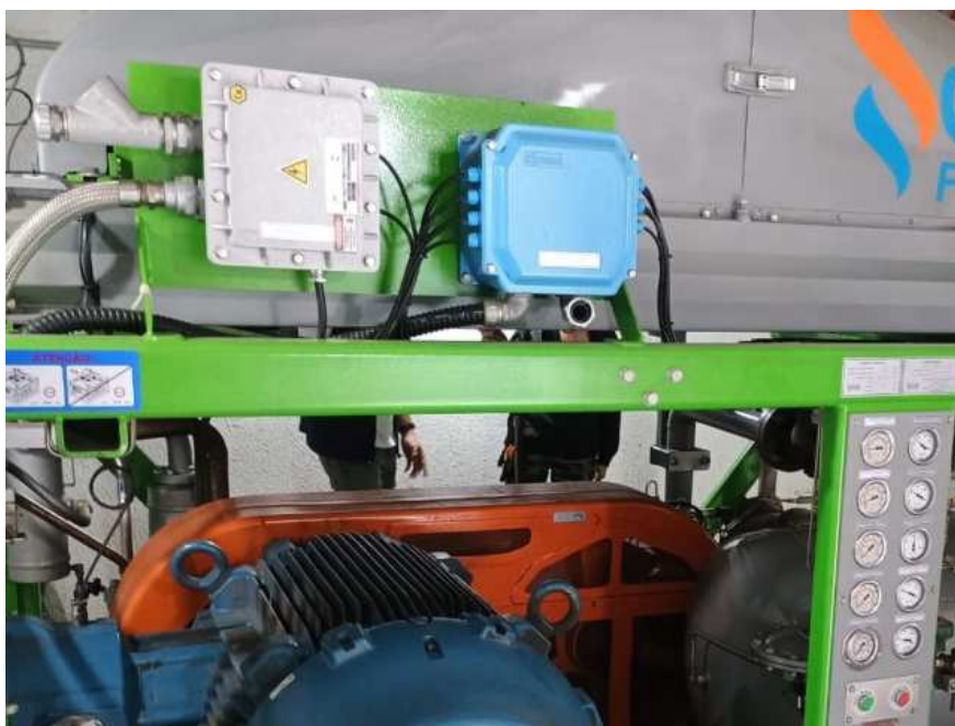
Foto 3: compressor do posto Aero.
