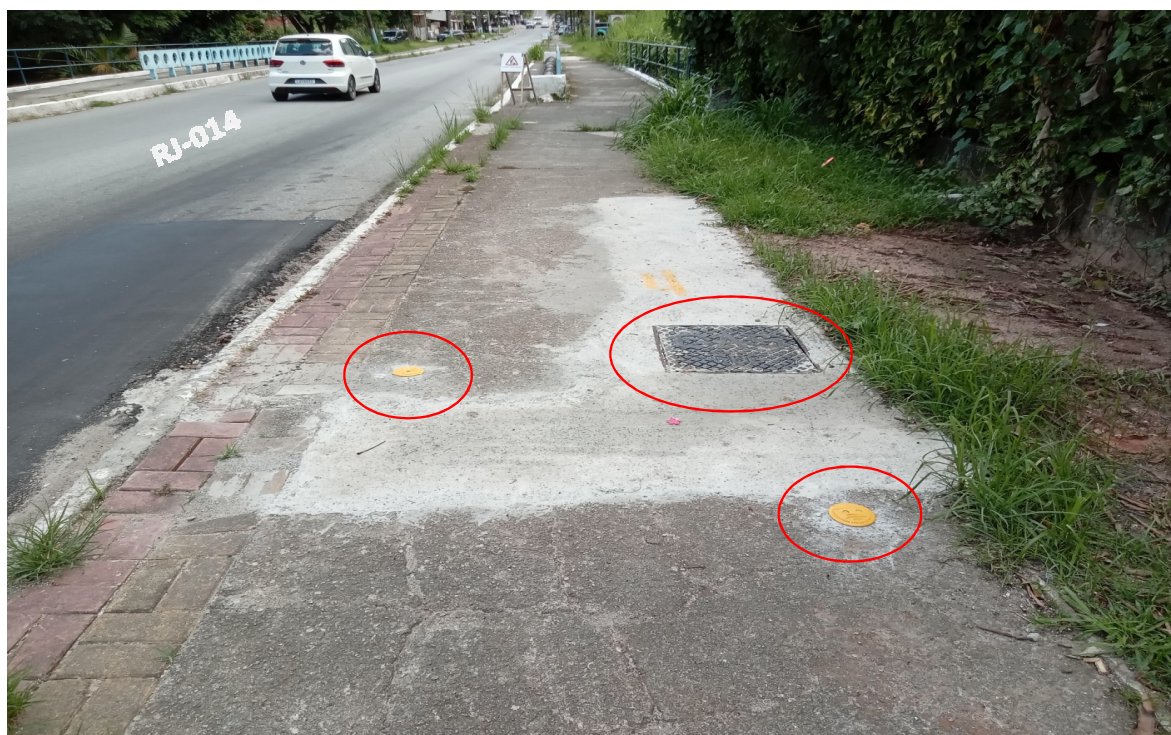
Foto 4: Caixa de válvula de setor e marcos planos indicando presença de rede de gás
