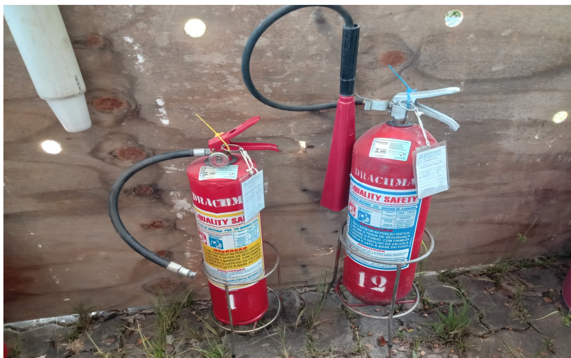
Foto 2: Extintores de incêndio presentes no local de vivência
