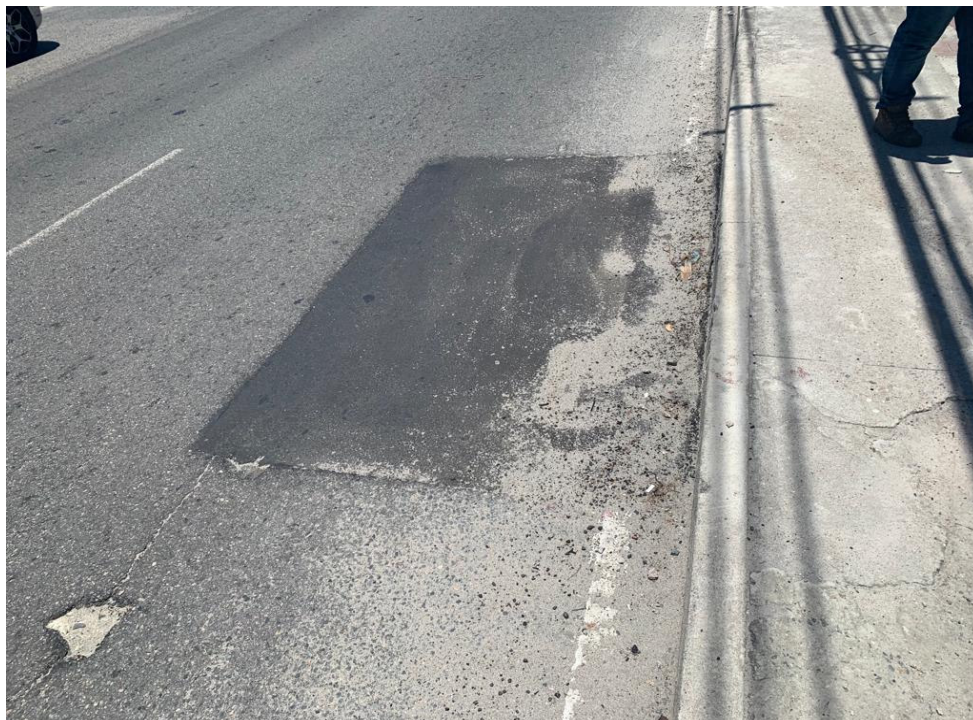
Foto 3: trecho com recomposição provisória sem identificação.
