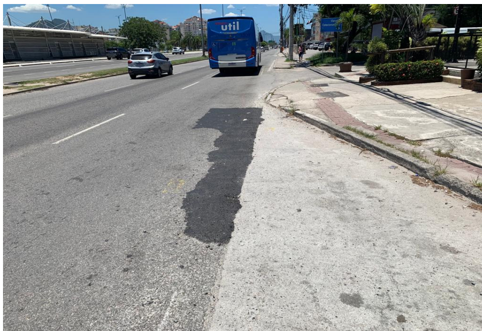
Foto 4: trecho com recomposição provisória sem identificação.
