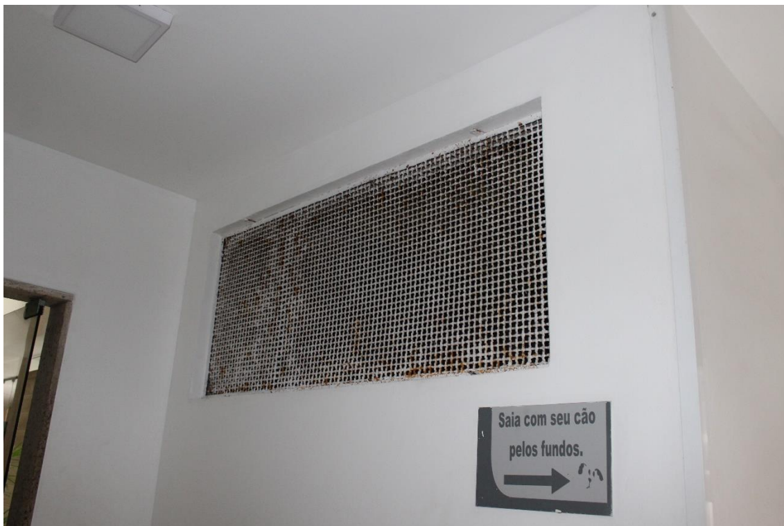
FOTO 3: Shaft das tubulações do PI do BL01.
