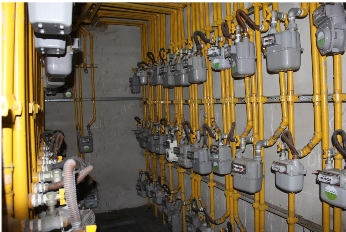
FOTO 1: PI do Bloco 1, responsáveis pela medição e distribuição de gás para os apartamentos.
