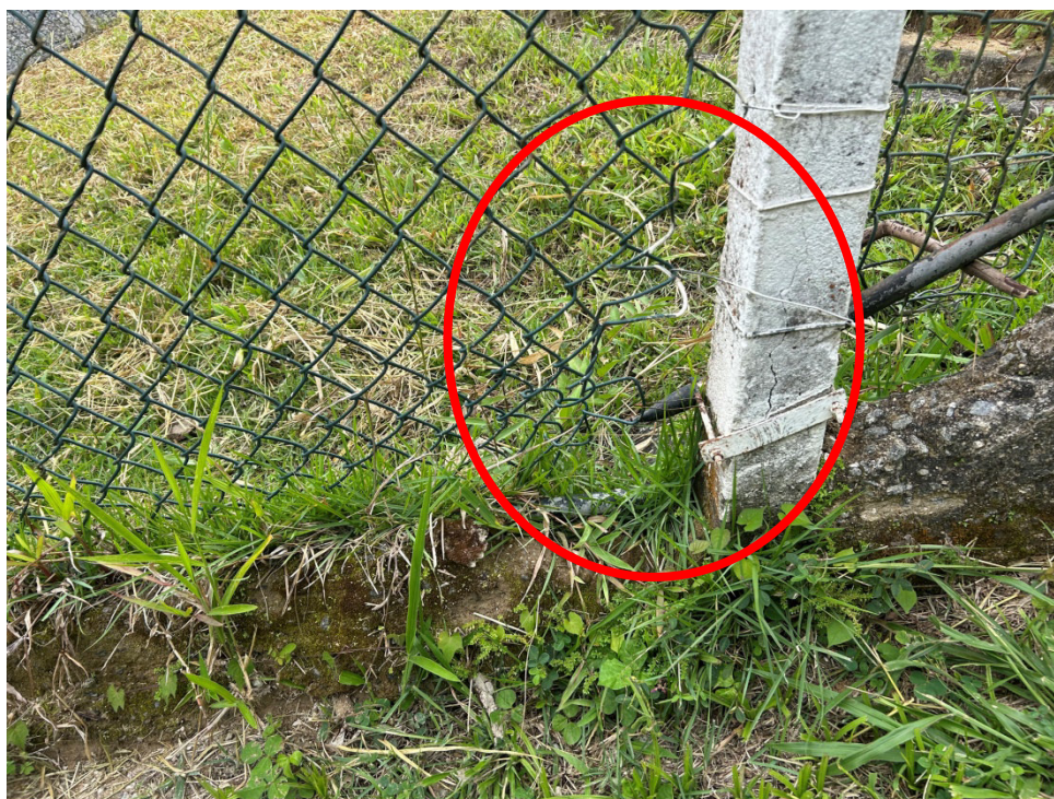
Foto 17: Falha observada na cerca.
