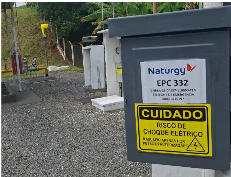
Foto 22: Sinalização de segurança acrescentada ao painel elétrico.
