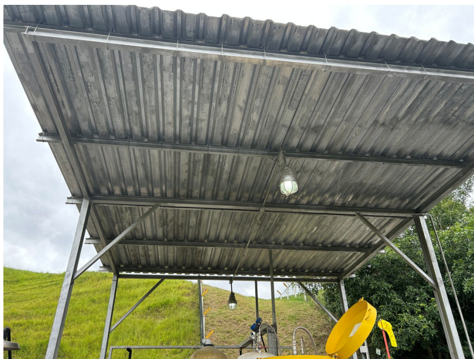
Foto 12: Cobertura da estação e sistema de iluminação da estação.
