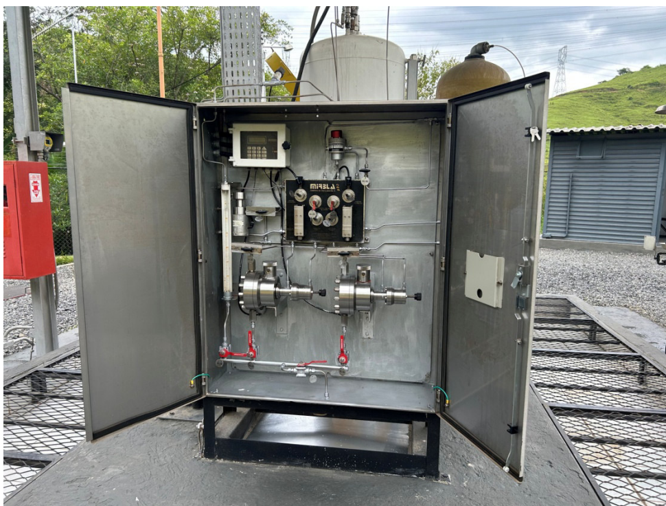
Foto 8: Equipamento de odorização.
