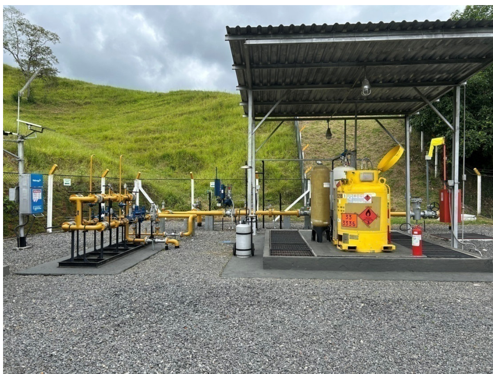
Foto 2: Visão geral da estação.
