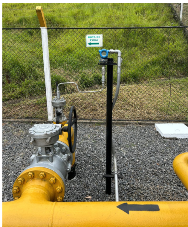
Foto 4: Derivação da linha de saída da ETC.
