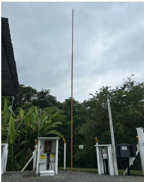
Foto 11: Sistemas elétrico e de proteção contra descargas atmosféricas.
