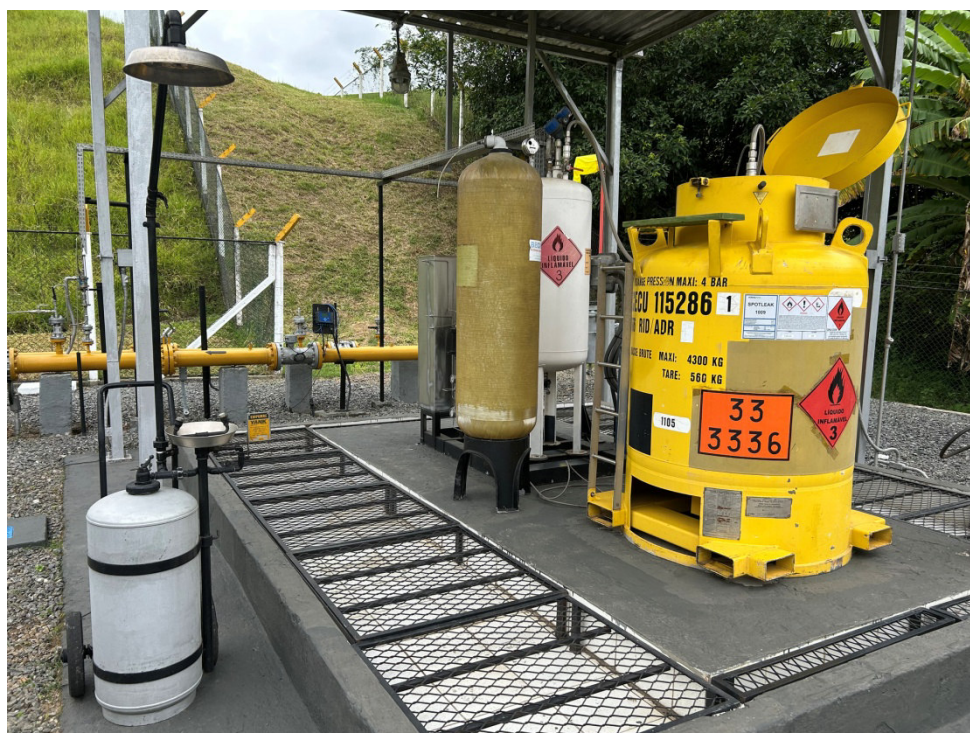
Foto 6: Estação de odorização.
