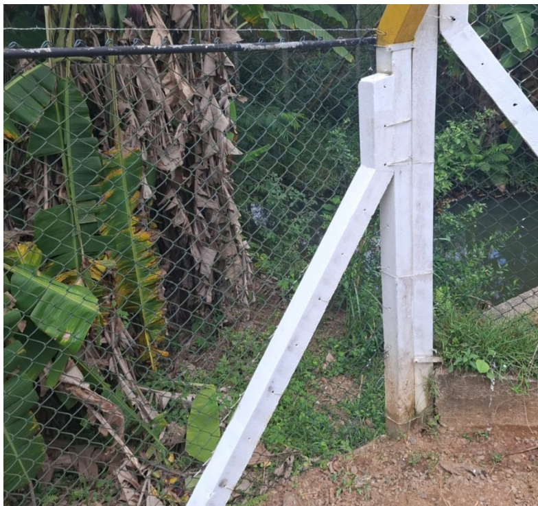
Foto 16: Falhas na cerca corrigidas.
