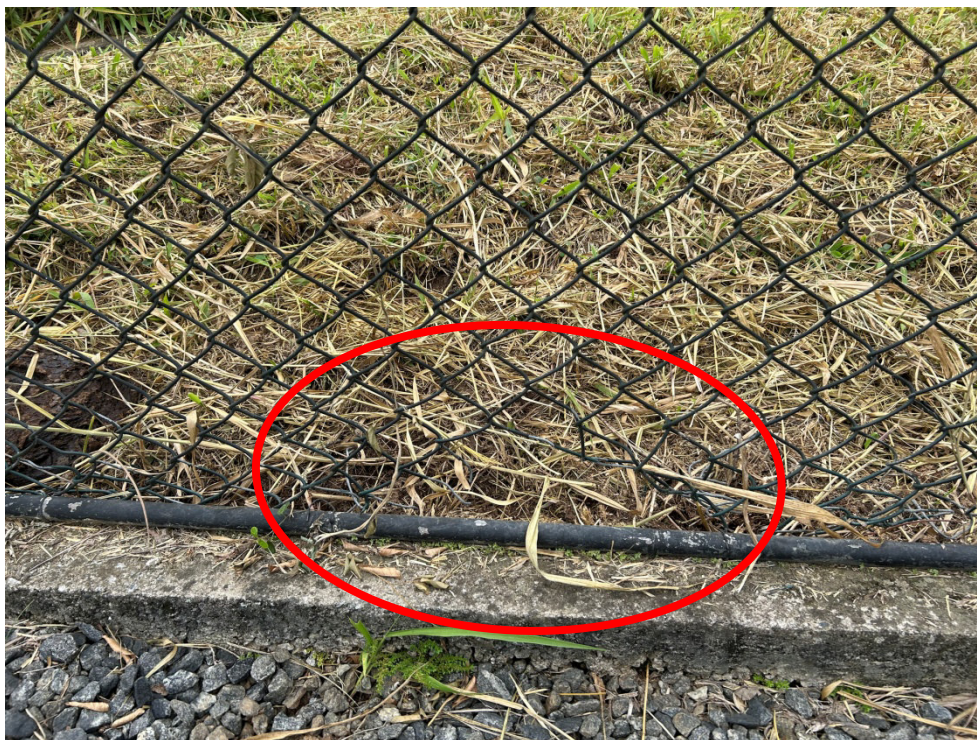
Foto 19: Falha observada na cerca.
