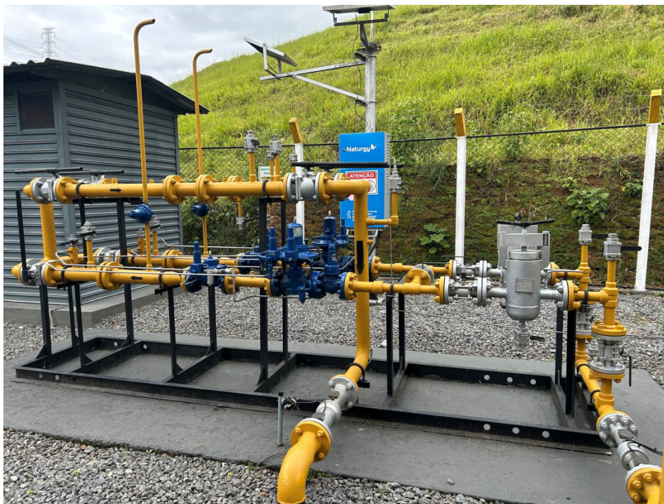
Foto 5: Estação de Regulagem e Medição. Sala de cromatografia e telemetria ao fundo.
