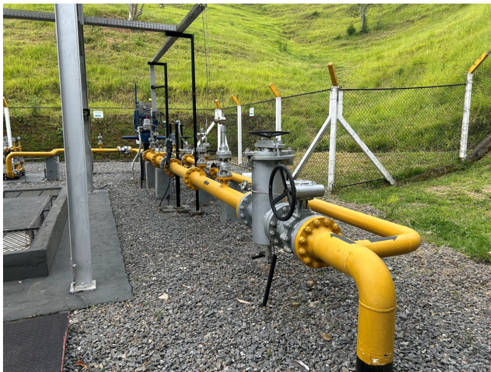
Foto 3: Tubulação de entrada de gás natural (35 bar).
