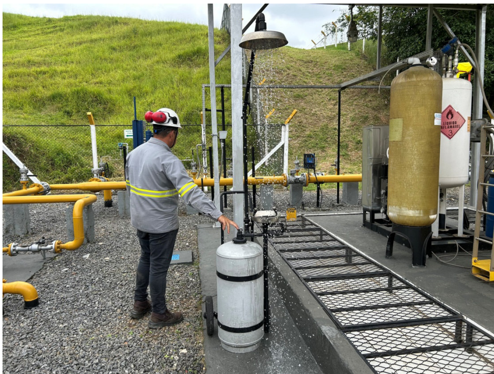
Foto 7: Funcionário da Naturgy mostrando o funcionamento do chuveiro da estação de odorização.
