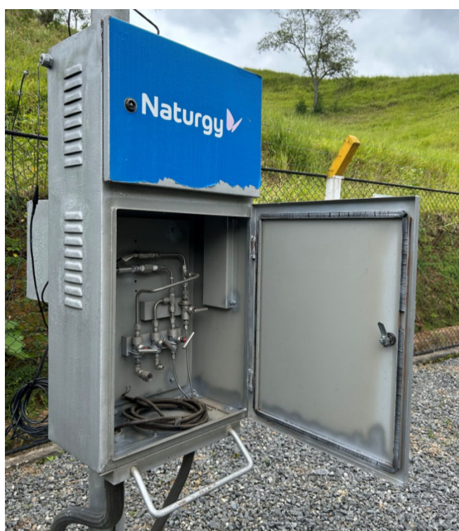
Foto 10: Sistema de telemetria.
