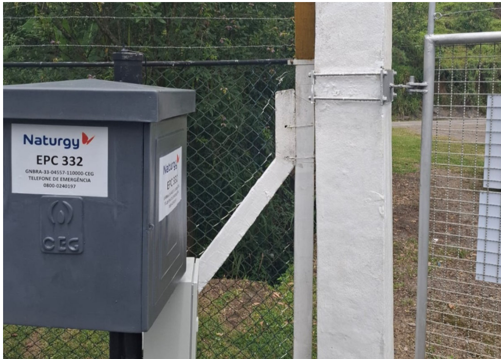
Foto 21: Painel elétrico sem sinalização de segurança.
