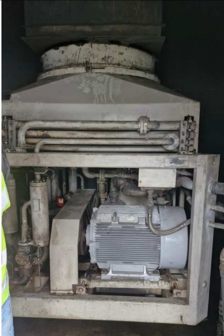
Foto 8: Compressor do Posto Guerreiros de Caxias. Vazamento foi constatado e solucionado posteriormente, mas fornecimento foi interrompido por segurança.
