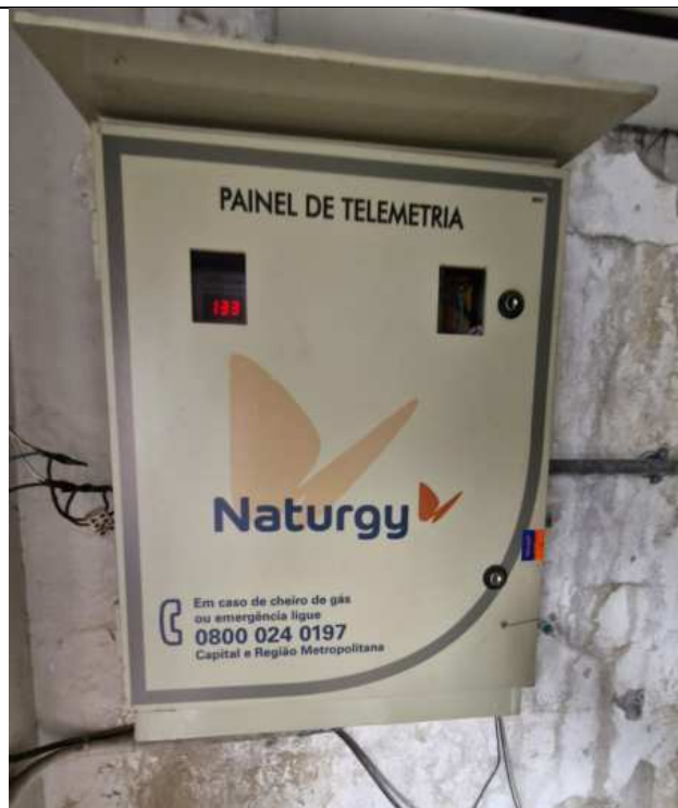
Foto 5: Pannel de telemetria próximo à estação do Posto Guerreiros de Caxias.
