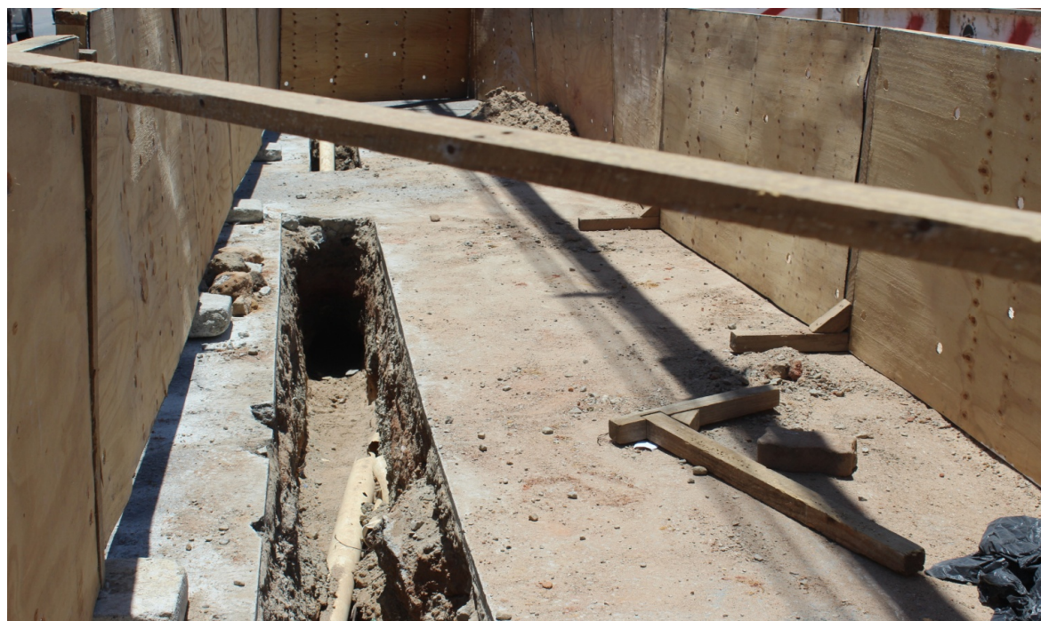
Foto 6: Trechos abertos isolados com barreiras sinalizadas.
