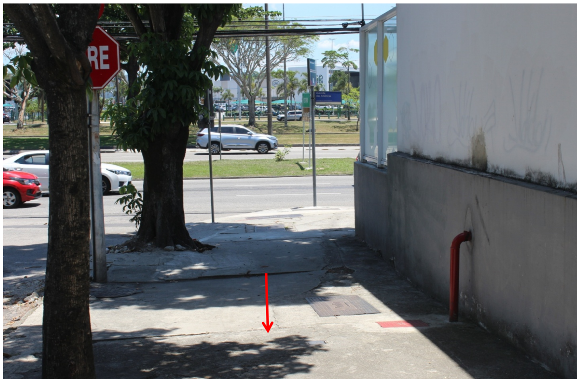
Foto 3: Rede já existente na esquina da Avenida das Américas com a Rua Zoila Abreu Teixeira.
