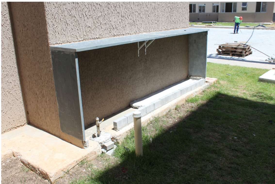
FOTO 7: Pontos de instalação de gás para o PI e válvula (protegida pelo tubo de PVC visto na foto)
