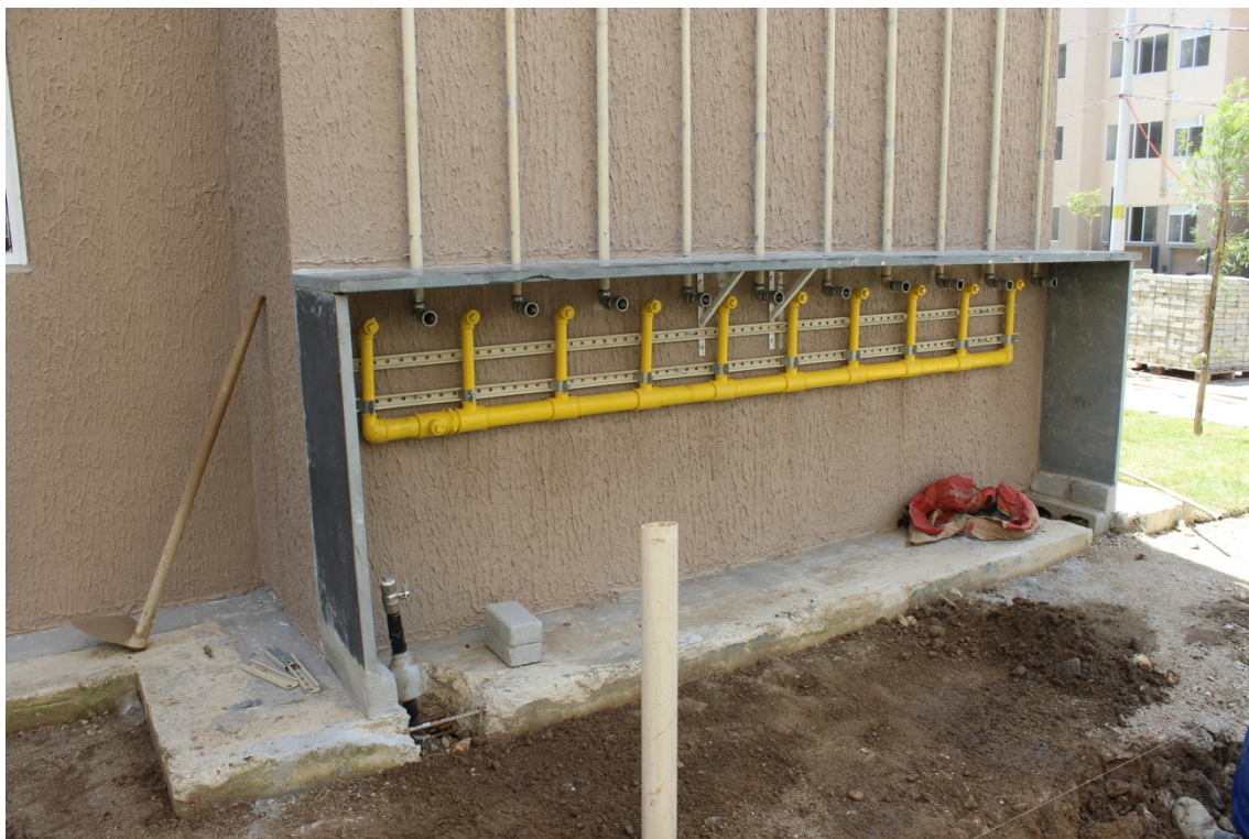
FOTO 5: Cabine de medidor coletiva e o ponto de instalação de gás para o PI.
