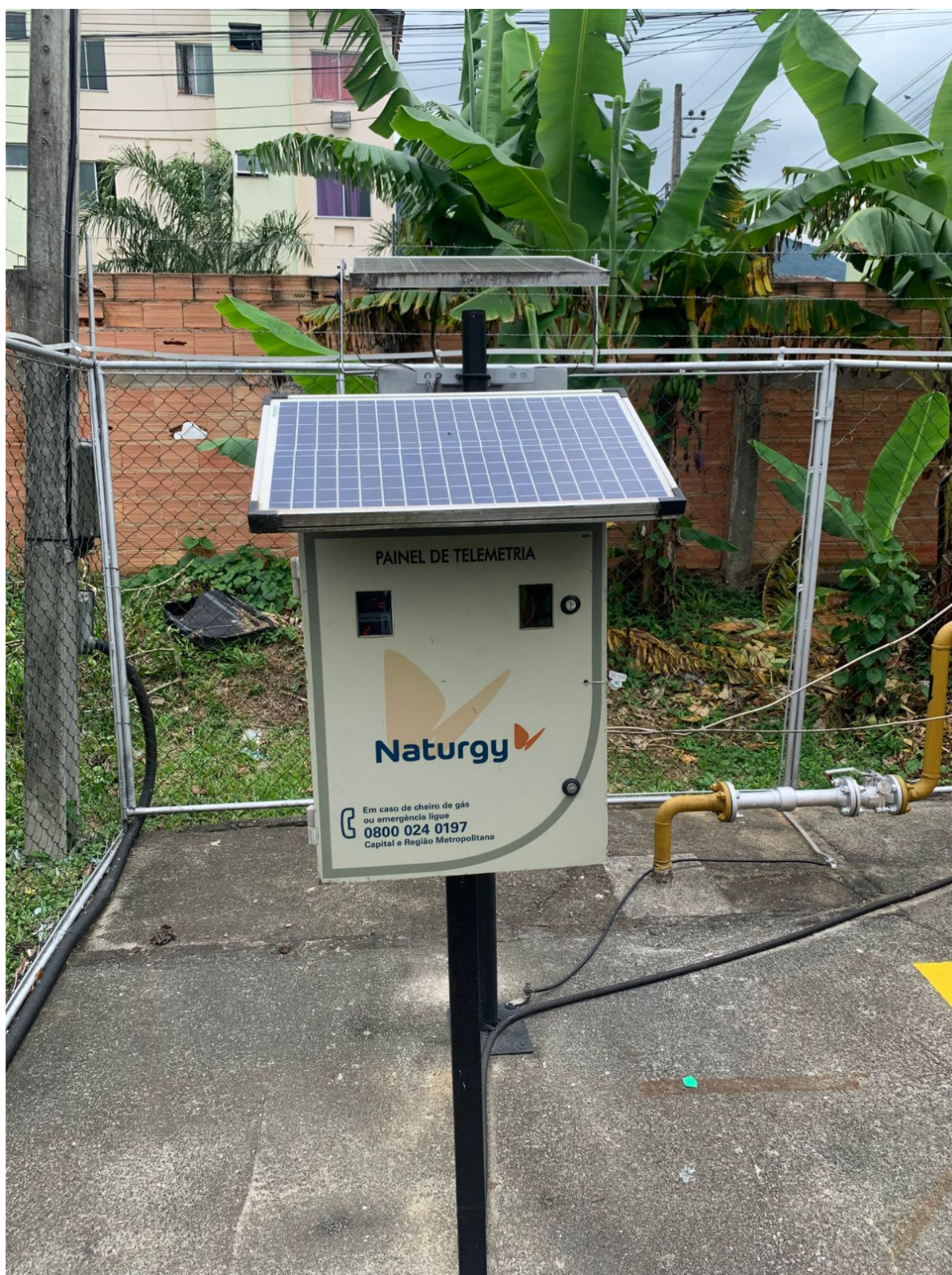
Foto 4: PAINEL DE TELEMETRIA da estação.
