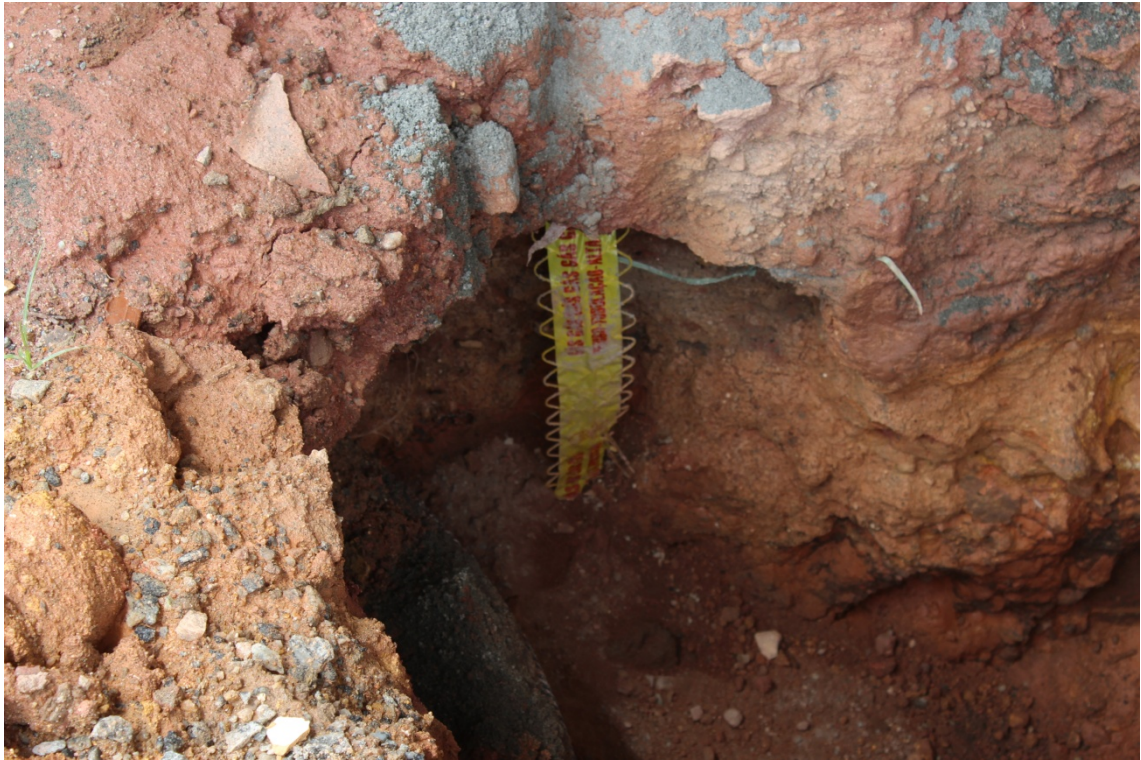
FOTO 5: Fita de sinalização instalada onde há rede de gás.
