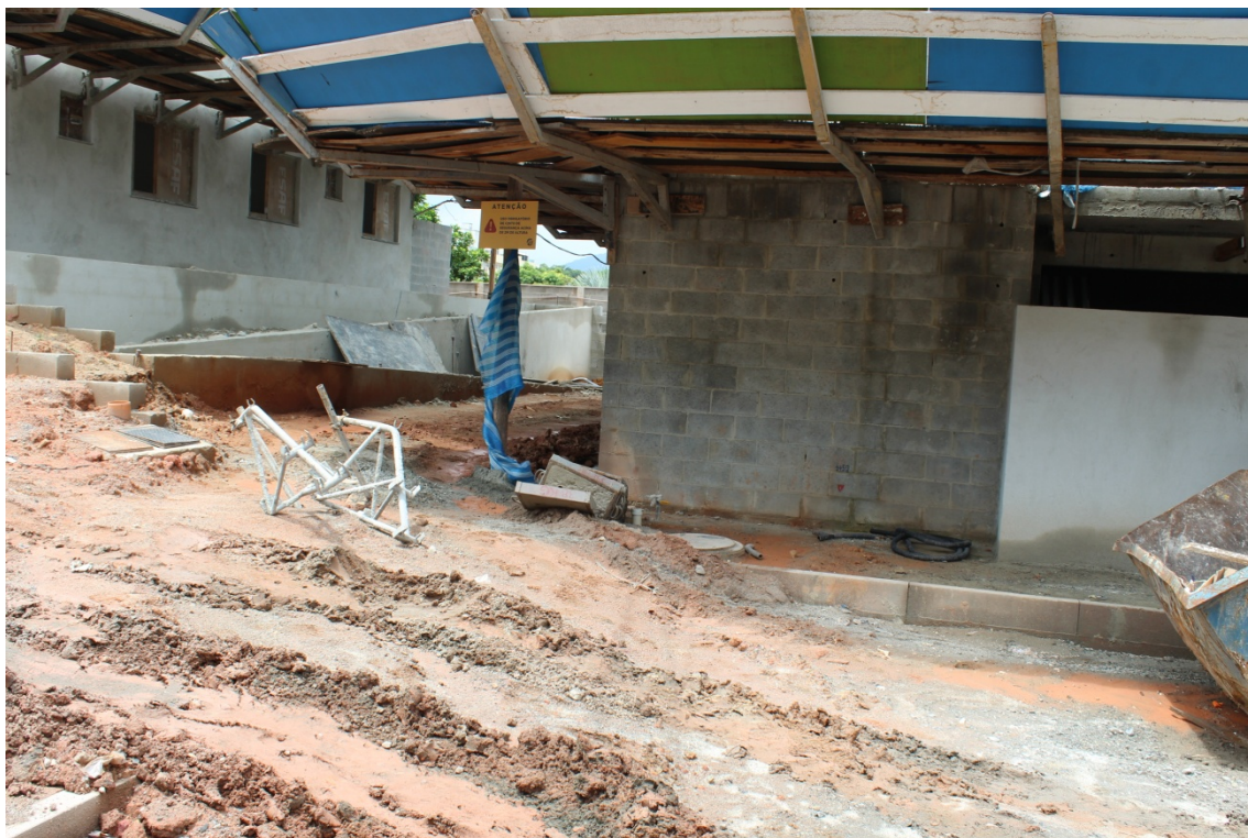
FOTO 3: Local onde será instalado um PI
