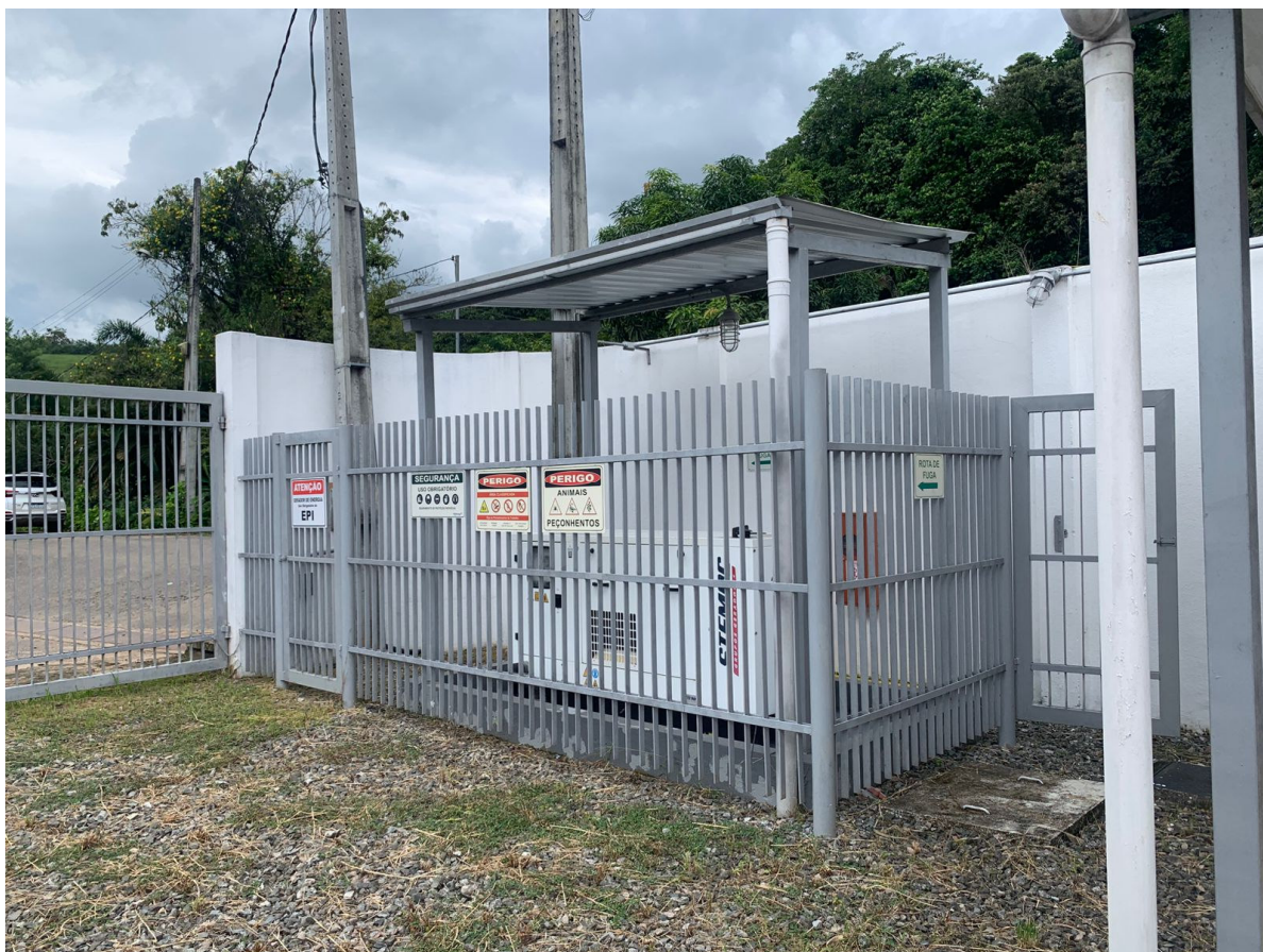
Foto 6: Gerador de Energia da estação.
