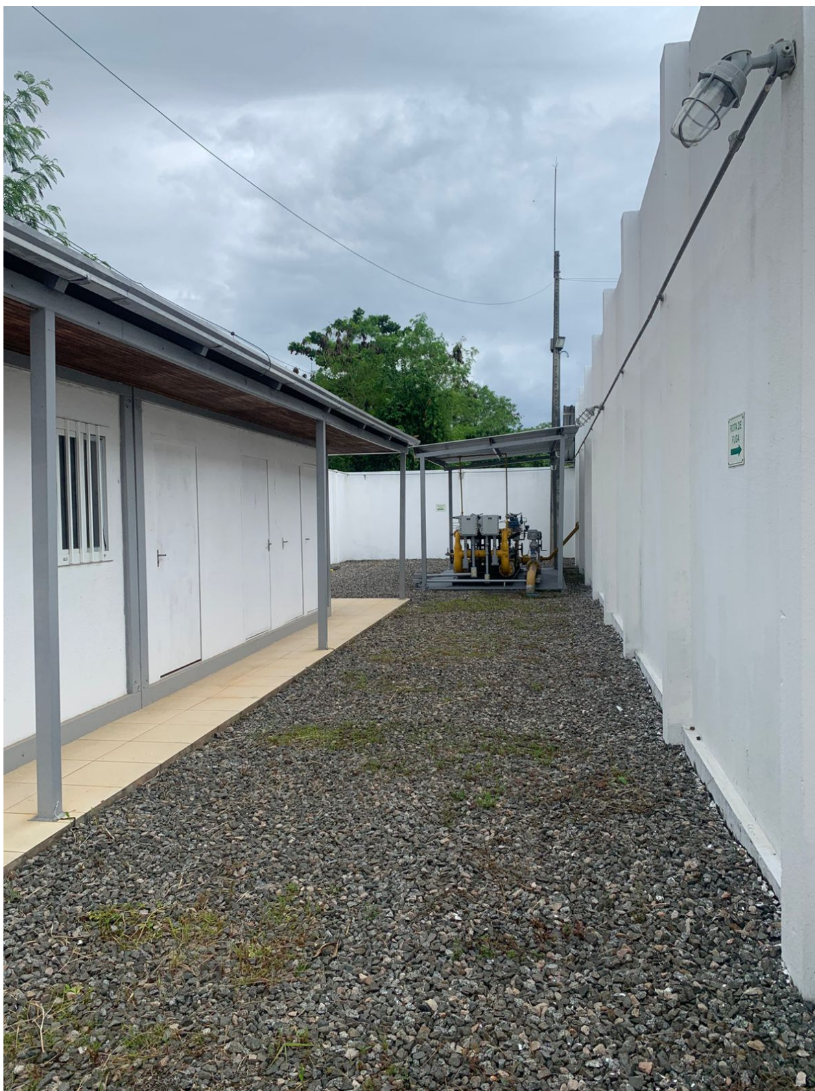
Foto 2: Visão geral da estação.
