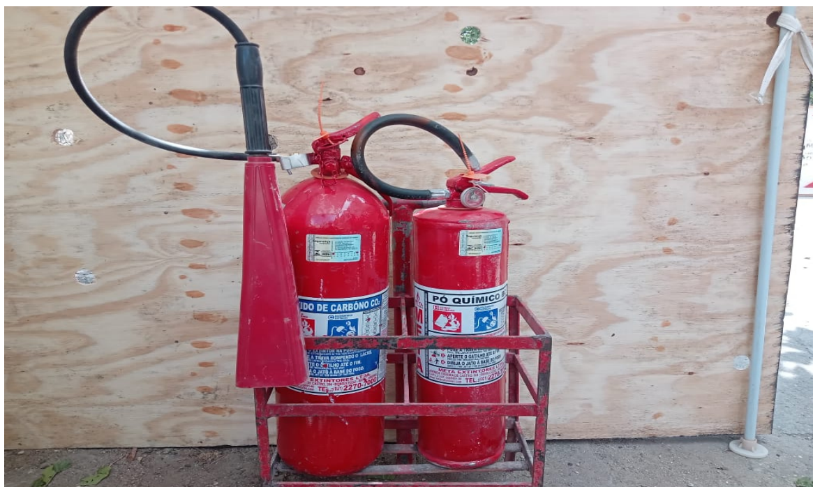
Foto 8: Extintores presentes no local de vivência
