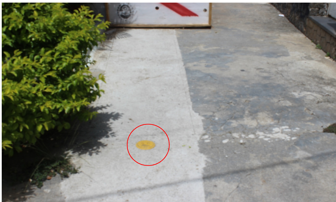
Foto 4: Marco plano indicando presença de rede de gás
