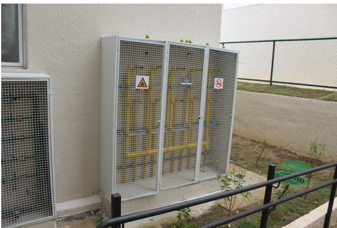
FOTO 4: Cabine de medidores coletiva.
