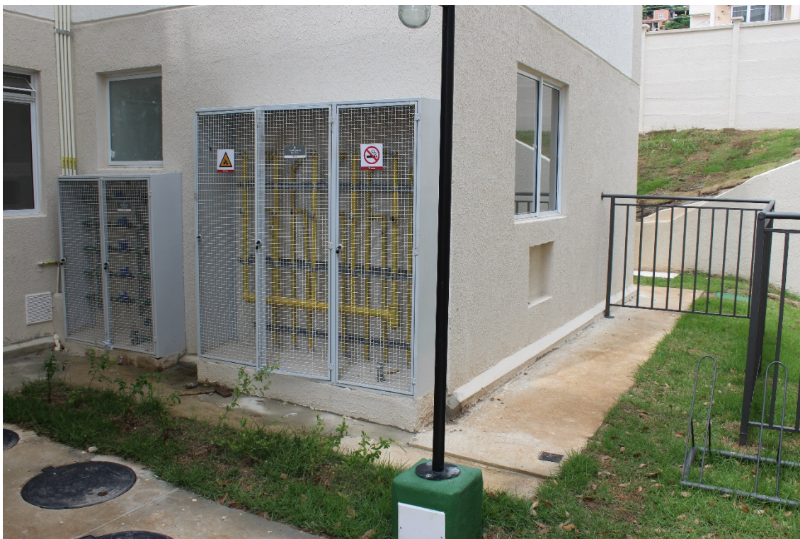
FOTO 3: Cabine de medidores coletiva.
