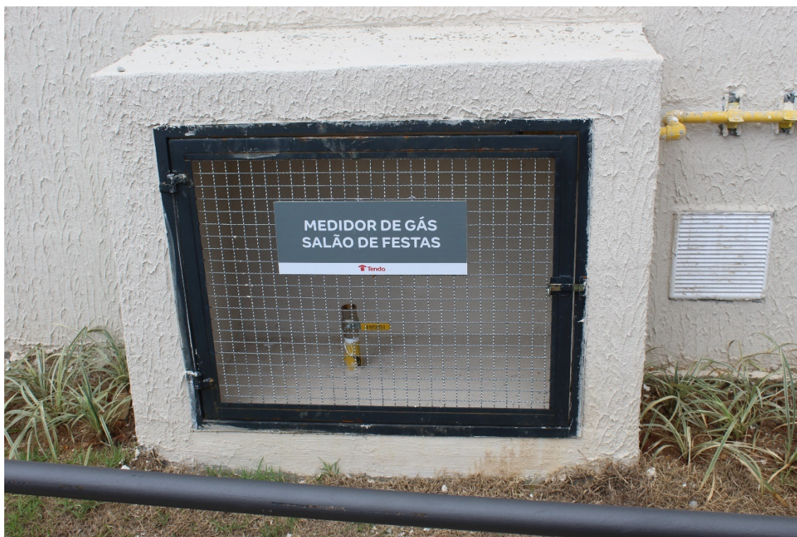
FOTO 5: Cabine de medidor individual.
