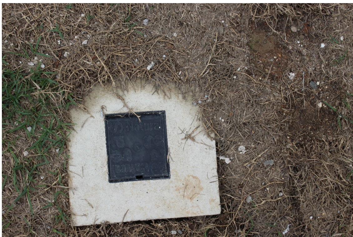
FOTO 2: Caixa de proteção de válvulas.
